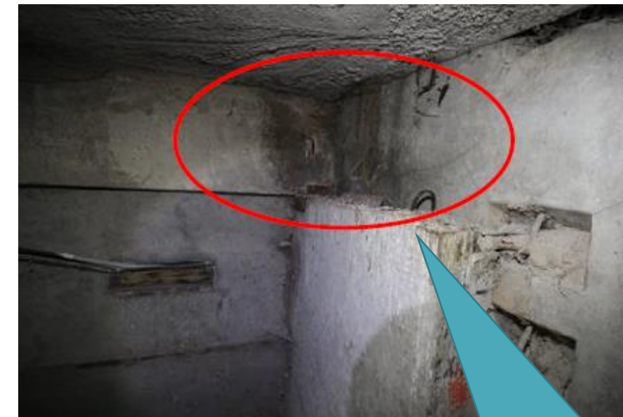
Nokrišņu ūdens infiltrācijas pazīmes
