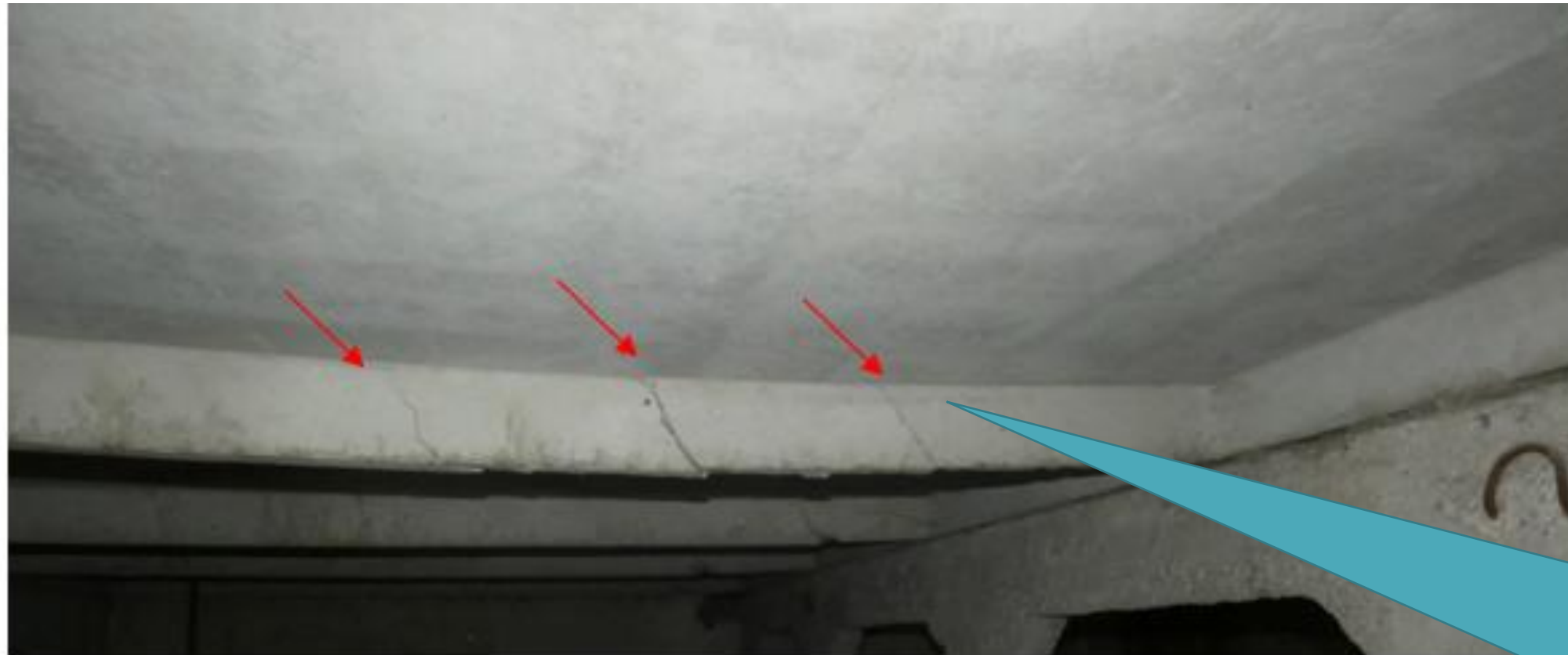
4.6.70.att. Ēkas 3.sekcijā konstatēta viena jumta klāja dzelzsbetona plātne, kurai pārlūzušas visas ribas un konstatēta izliece 30-50 mm. Nepieciešams nekavējoties izstrādāt tehnisko risinājumu un veikt konstrukciju pastiprināšanu.
