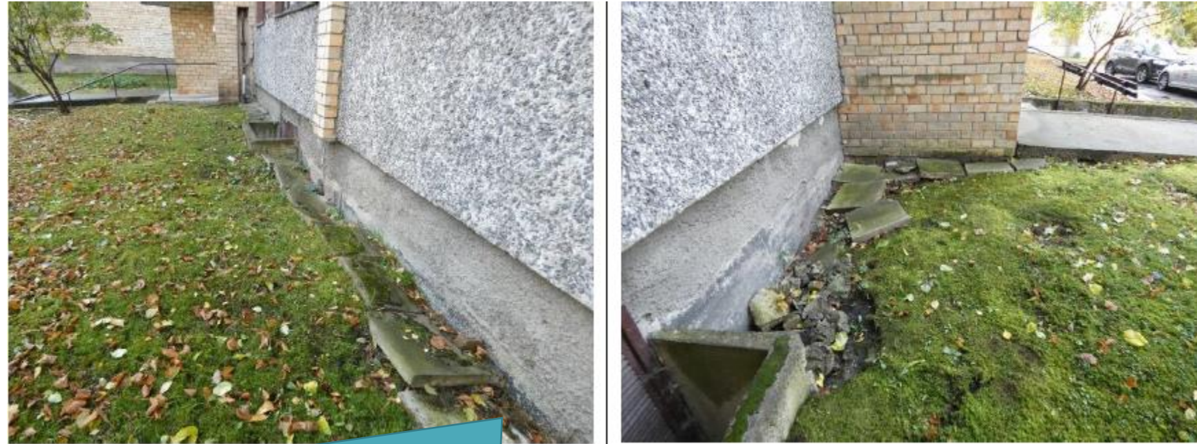
Ēkas aizsargapmale sabrukusi pa visu ēkas perimetru
