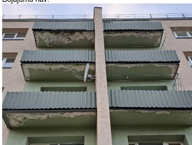
1.5.8.31. attēls. 9. Atjaunošana laiks – ~10 gadi. Metāla lāsenis visā balkona plātnes biezumā. Margas apdare nav zemāka par lāseņa un balkona plātnes apakšu. Galvenokārt izsāļojumi uz plātnes apakšējās virsmas pa perimetru. Lokāli atslāņojies apmetums pa perimetru. Izteiktāki bojājumi augšējo stāvu balkoniem.
