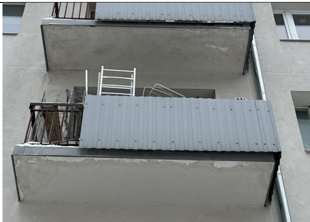
1.5.8.22. attēls. Ēka Nr. 2. Atjaunošana laiks – pirms ~10 gadi. Metāla lāsenis visā balkona plātnes biezumā. Marga nenosedz plātnes malu. Bojājumu galvenokārt pa plātnes perimetru apakšējā daļā.
