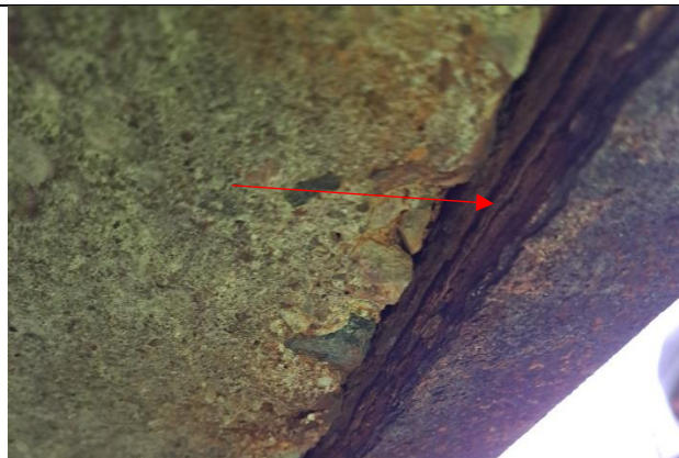
1.5.8.8. attēls. Mehānisko stiprību un stabilitāti ietekmējoši bojājumi. Perimetra profila apakšējais plaukts atslāņojies – pieaudzis tilpumā līdz 2 cm. Spriegumu rezultātā deformēta sienīņa.
