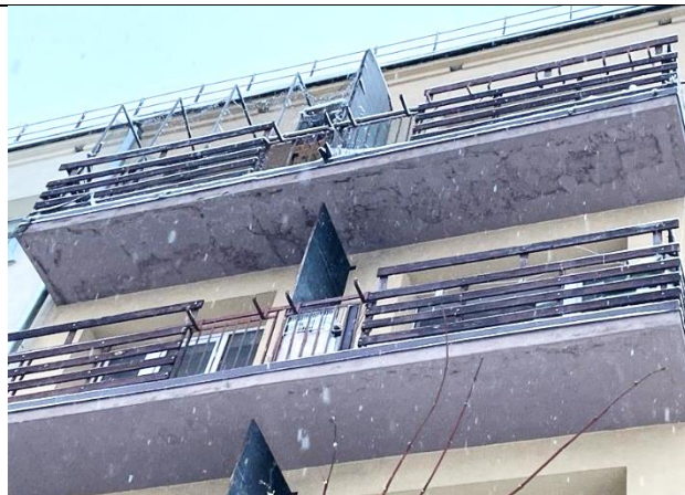
1.5.8.23. attēls. Ēka Nr. 3. Atjaunošana laiks – pirms ~10 gadi. Metāla lāsenis līdz balkona plātnes biezuma pusei. Marga nenosedz plātnes malu. Bojājumi galvenokārt pa plātnes perimetru apakšējā daļā, mirkoplaisas, izsāļojumi apmetumā, lokāli atslāņojies apmetums. Izteiktākas problēmas 5. stāva balkonu plātnēm.
