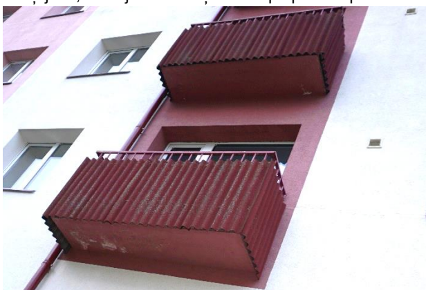
1.5.8.37. attēls. Ēka Nr. 14. Atjaunošana laiks – ~10 gadi. Metāla lāsenis visā balkona plātnes biezumā. Margas apdare zemāka par lāseņa un balkona plātnes apakšu. Izsāļojumi uz plātnes apakšējās virsmas, lokāli krāsojuma atslāņošanās. Margu Onduline apdare ēkas Dienvidu pusē deformējusies.
