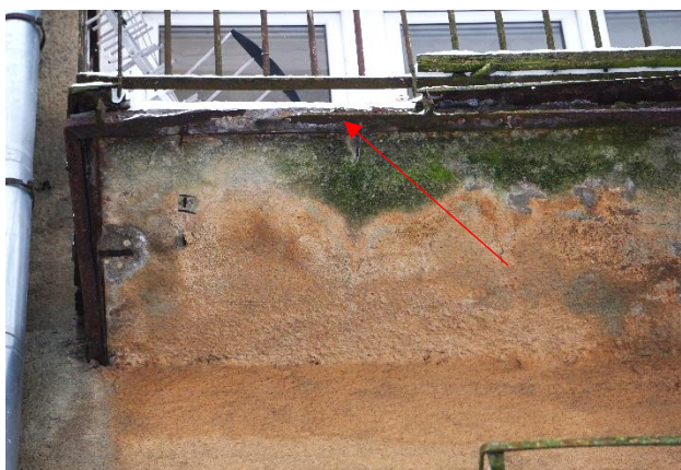
1.5.8.11. attēls. Mehānisko stiprību un stabilitāti ietekmējoši bojājumi. Perimetra profils atslāņojies, sadalījies.
