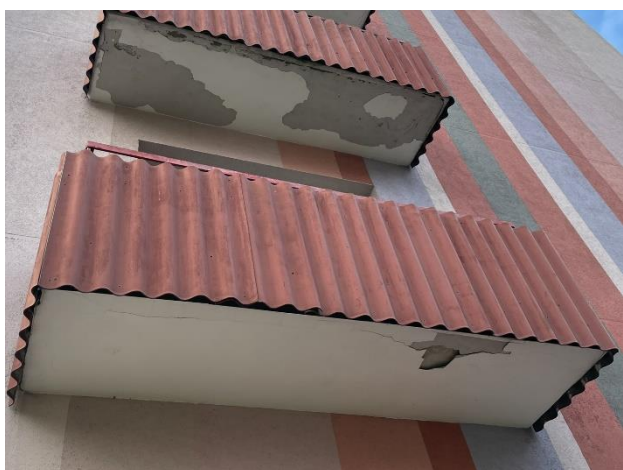
1.5.8.26. attēls. Ēka Nr. 6. Atjaunošana laiks – ~10 gadi. Metāla lāsenis visā balkona plātnes biezumā. Margas apdare zemāka par lāseņa un balkona plātnes apakšu. Apjomīgi bojājumi pa plātņu apakšējo virsu dienvidaustrumu pusē. Atslāņojies krāsojums, špaktele, betons, atsegta plātnes virsma. Var atdalīties apdares fragmenti.
