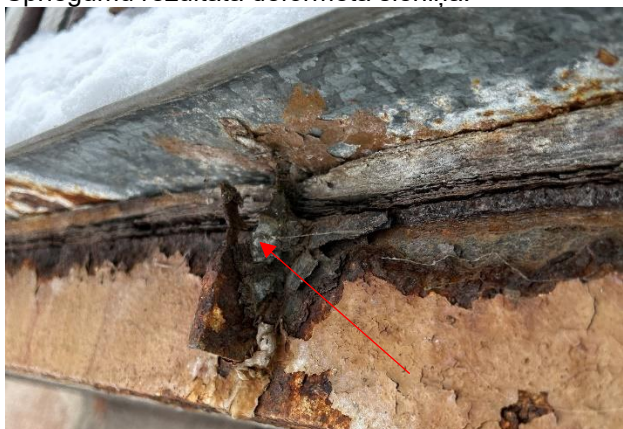
1.5.8.9. attēls. Mehānisko stiprību un stabilitāti ietekmējoši bojājumi. Caurrūsējis margas stats. Margu mehāniskā stiprība un stabilitāte zudusi.
