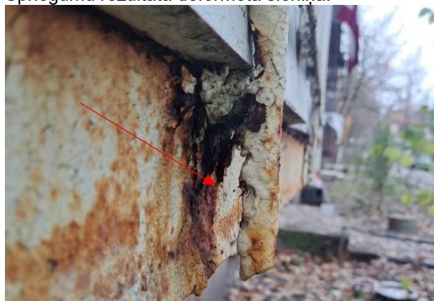
1.5.8.10. attēls. Mehānisko stiprību un stabilitāti ietekmējoši bojājumi. Atdalījusies margas stāva metinājuma šuve ar perimetra profilu. Margu mehāniskā stiprība un stabilitāte zudusi.
