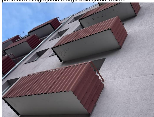
1.5.8.27. attēls. Ēka Nr. 6. Atjaunošana laiks – ~10 gadi. Metāla lāsenis visā balkona plātnes biezumā. Margas apdare zemāka par lāseņa un balkona plātnes apakšu. Citviet ēkā dienvidrietumu pusē tikai lokāli atslāņojušās krāsas fragmenti.
