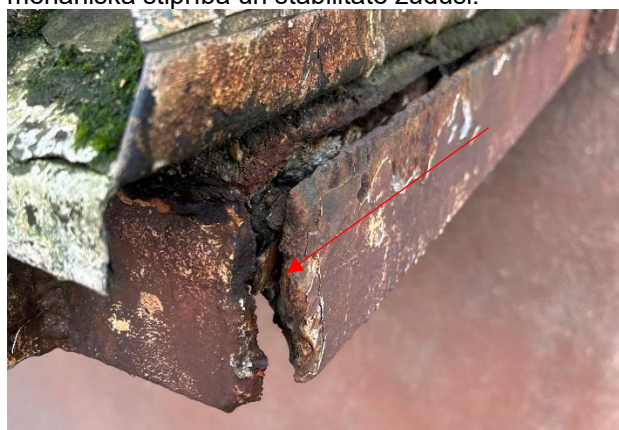
1.5.8.12. attēls. Mehānisko stiprību un stabilitāti ietekmējoši bojājumi. Perimetra profils atslāņojies, palielinājies tilpumā, spriegumu rezultātā bojāta stūra metinājuma šuve.
