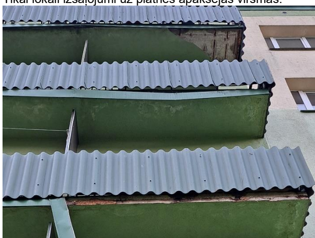
1.5.8.30. attēls. Ēka Nr. 9. Atjaunošana laiks – ~10 gadi. Metāla lāsenis visā balkona plātnes biezumā. Margas apdare nav zemāka par lāseņa un balkona plātnes apakšu. Galvenokārt izsāļojumi uz plātnes apakšējās virsmas pa perimetru. Lokāli atslāņojies apmetums pa perimetru, daļēji vai pilnībā nokrituši lāseņi, lokāli apjomīgāki aizsargslāņa atslāņošanās un apmetuma fragmentu nokrišana.
