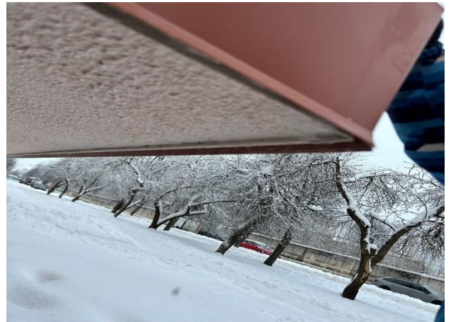
1.5.8.21. attēls. Ēka Nr. 1. Atjaunošana laiks <1 gads. Balkons ar epoksīda virsmas pārklājumu un dubultu lāseņi. Bojājumu nav.
