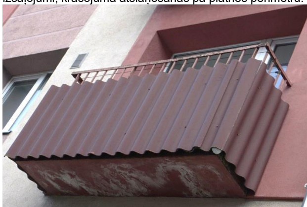
1.5.8.36. attēls. Ēka Nr. 13. Atjaunošana laiks – ~12 gadi. Metāla lāsenis visā balkona plātnes biezumā. Margas apdare zemāka par lāseņa un balkona plātnes apakšu. Izsāļojumi uz plātnes apakšējās virsmas, lokāli krāsojuma atslāņošanās. Margu Onduline apdare ēkas Dienvidu pusē deformējusies.
