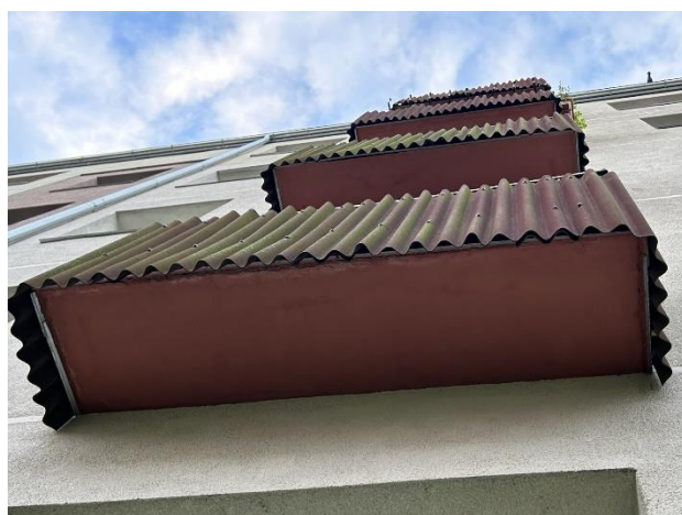
1.5.8.33. attēls. Ēka Nr. 11. Atjaunošana laiks – ~10 gadi. Metāla lāsenis visā balkona plātnes biezumā. Margas apdare zemāka par lāseņa un balkona plātnes apakšu. Tikai lokāli izsāļojumi uz plātnes apakšējās virsmas. Margu Onduline apdare ēkas Dienvidu pusē deformējusies.
