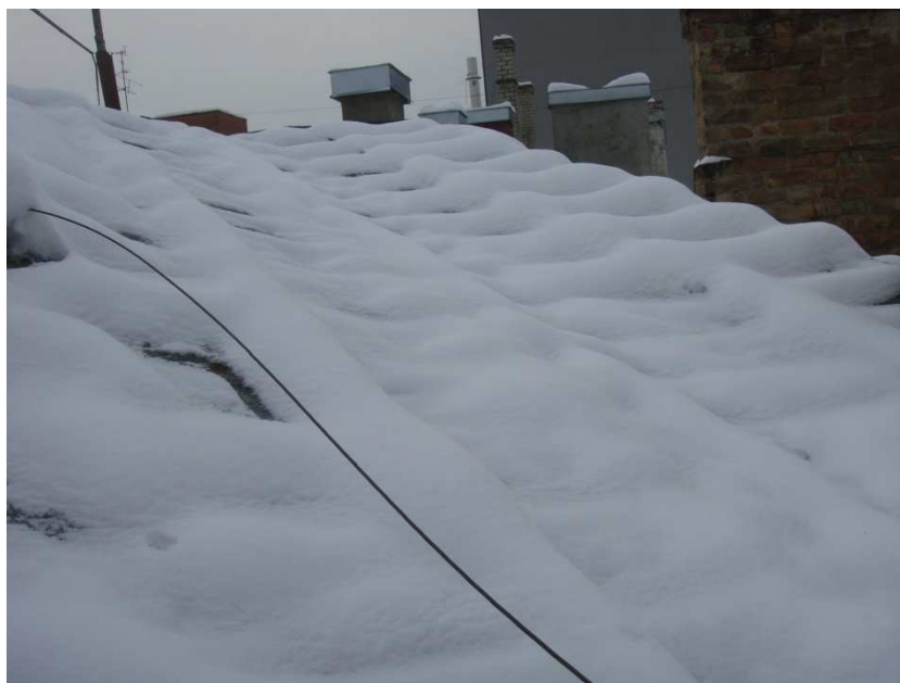
Slikti nosiltināti bēniņu pārsegumi
