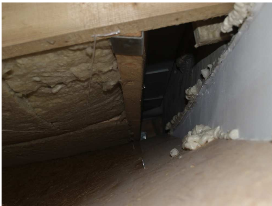
Vietas jumtā bez siltinājuma
