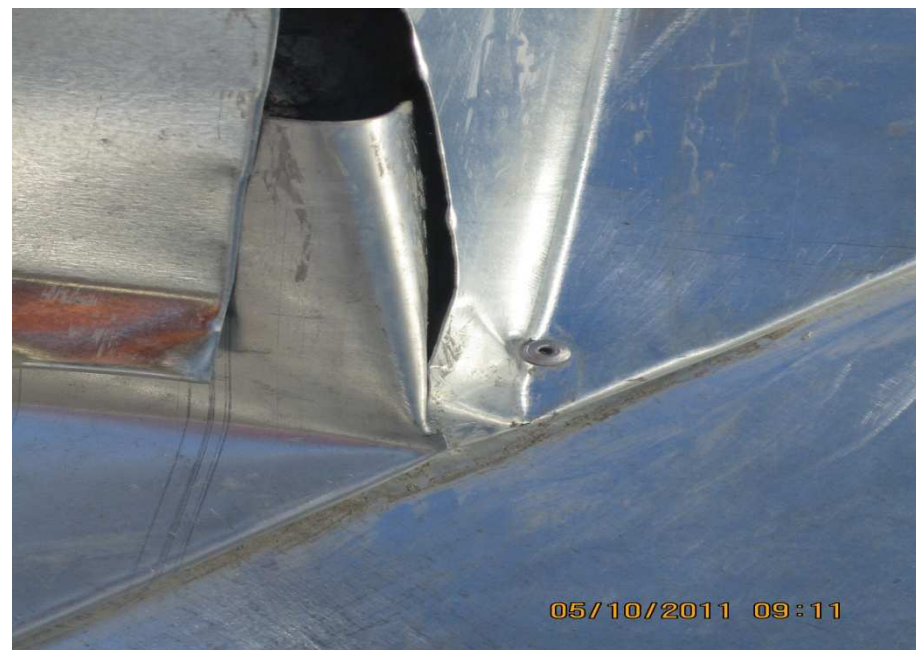
Stūros un pieslēgumu vietās atstāti caurumi
