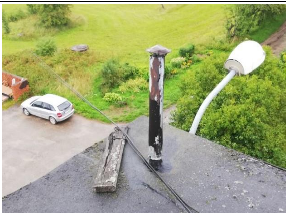
4.8.9.att. Korodējis ventilācijas izvads. Uz jumta atrodas priekšmets, kas var apdraudēt garāmgājējus.
