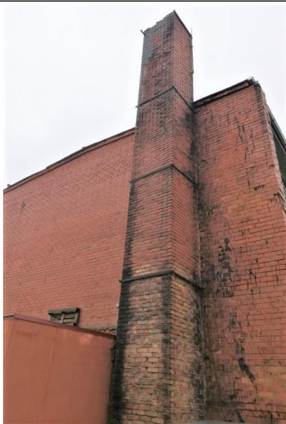
4.14.1.att. Katlu mājas dūmenis, mūra izdrupumi augšdaļā.
