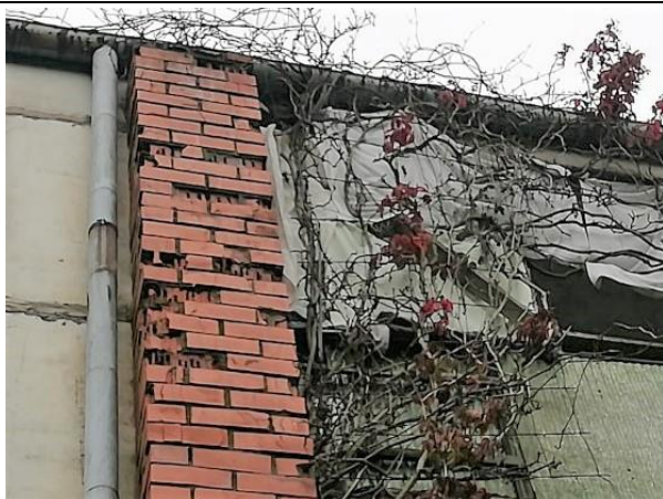
4.2.5.att. No nokrišņiem bojāts, erodējis starpsienas mūris.
