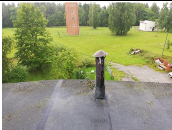
4.8.10.att. Korodējis jumta ventilācijas izvads.
