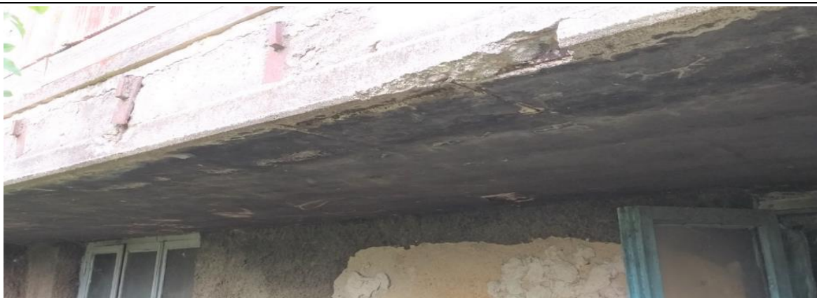
4.9.2.att. Ugunsgrēka rezultātā bojāta lodžijas pārseguma plātne – plaisas, izdrupumi un atsegts stiebrojums.
