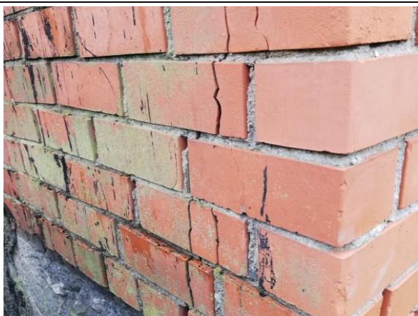
4.2.3.att. Mūra bojājumi - vertikālas plaisas.
