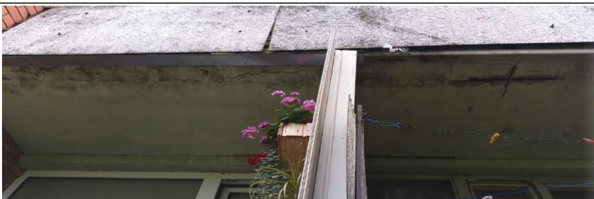
4.9.3.att. Bojāta lodžijas pārseguma plātne – plaisas, izdrupumi, atsegts korodēts stiebrojums.
