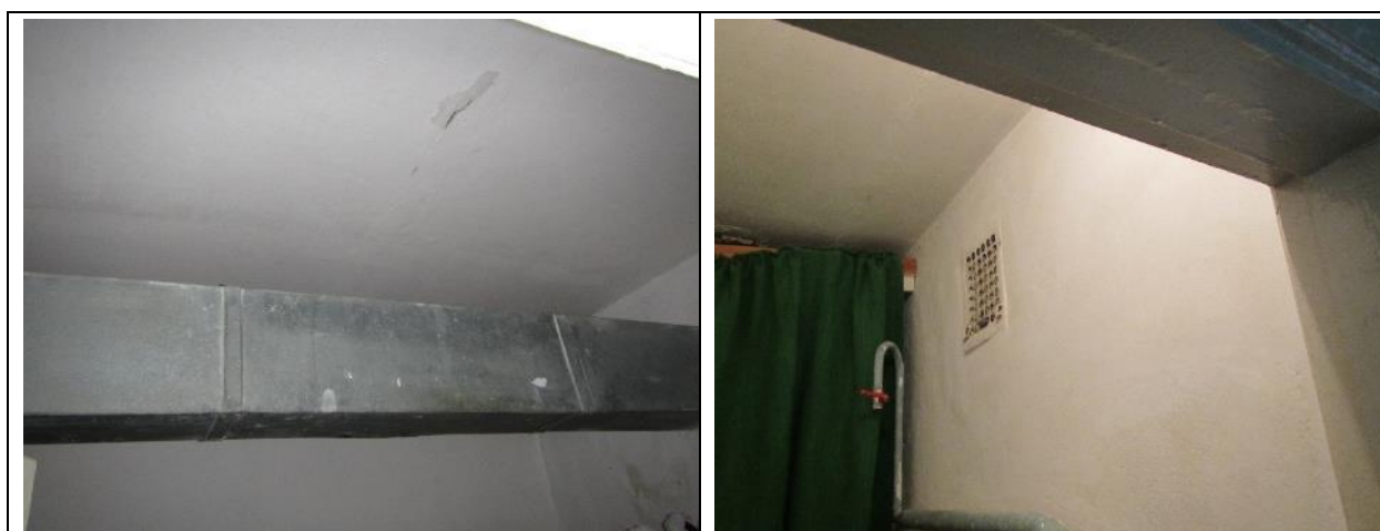
4.16.5., 4.16.6.att. Metāla ventilācijas kanāli dzīvokļu iekšienē.
