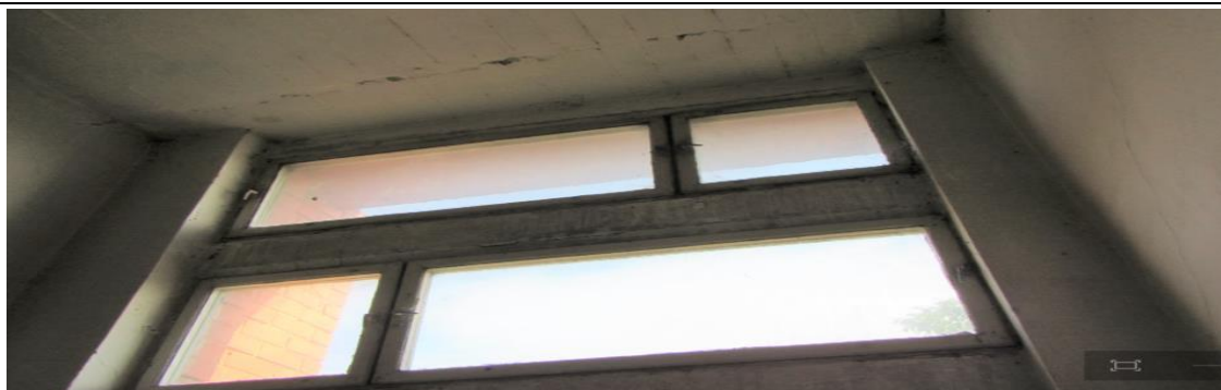
4.13.4.att. Kāpņu telpās nolietojušies logi koka rāmjos.
