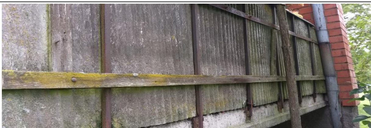
4.9.4.att. Korodējušas margas un ieliekamās detaļas, stiklašķiedras viļņoto lokšņu konstrukcija.
