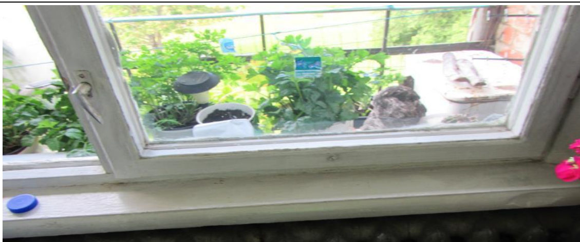
4.13.3.att. Nolietojušies dzīvokļu logi koka rāmjos.
