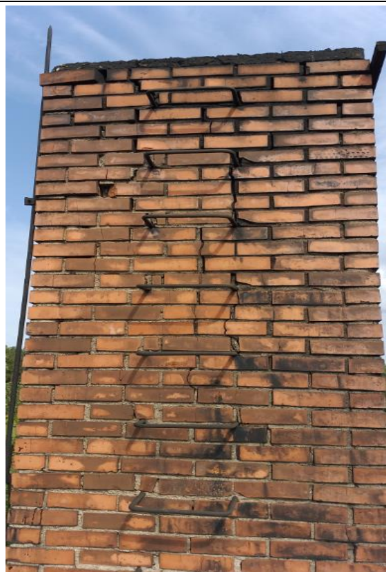
4.14.2.att. Mūra vājinājums dūmeņa galā – plaisas un izdrupumi.
