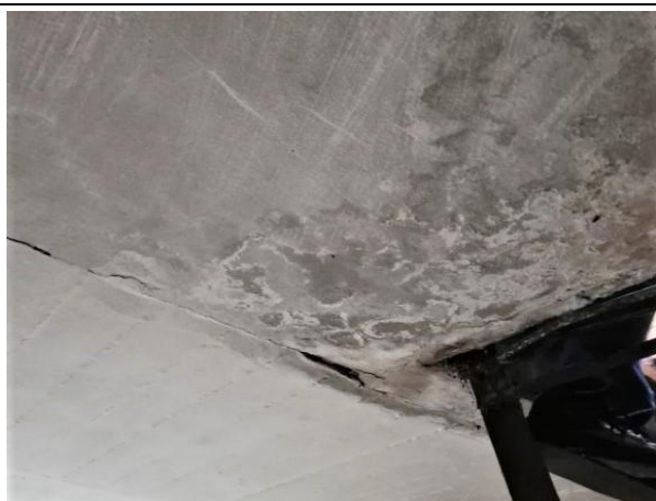
4.8.15.att. Mitruma infiltrācijas pazīmes pie jumta lūkas kāpņutelpā.
