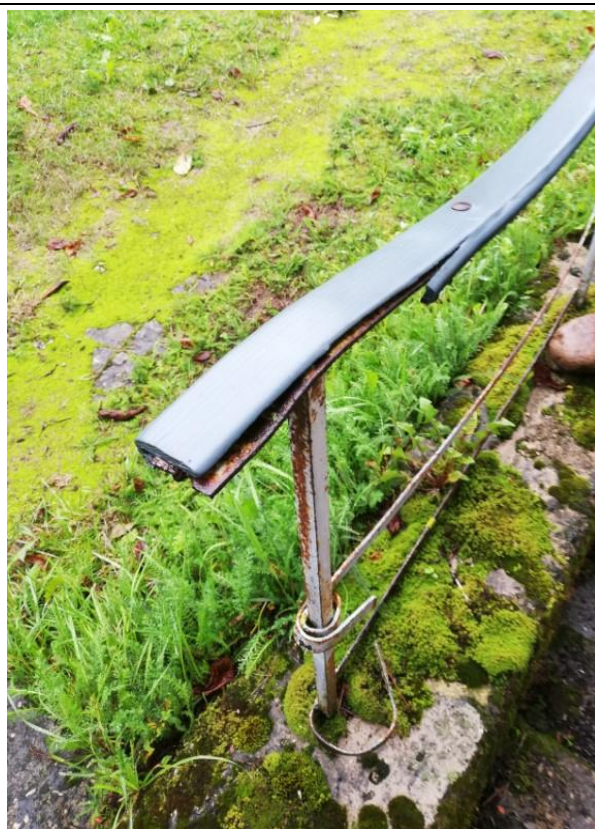
4.10.3.att. Ēkas pagalma daļā nokļūšanai uz pagraba nedroša, korodējusi kāpņu marga.
