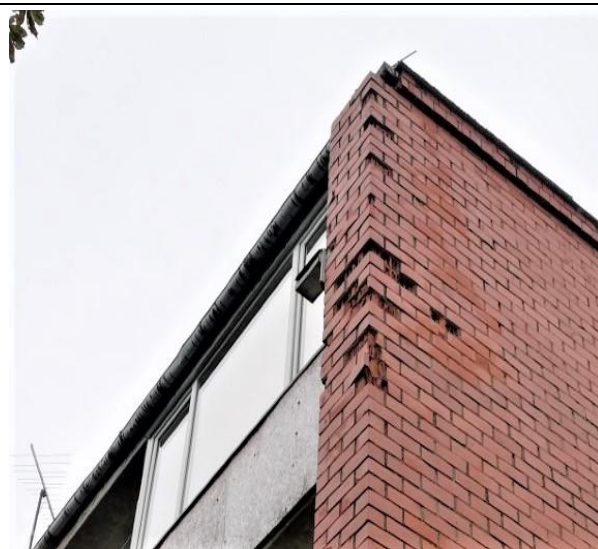
4.2.2.att. Ēkas nesošās ķieģeļu mūra gala sienas 510 mm biezumā. Nokrišņu bojāts gala sienas mūris.
