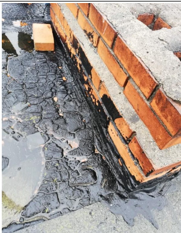
4.8.5.att. Bitumena mastikas jumta segums pie ventilācijas izvada plaisājis ar iesēdumiem un ir neapmierinošā tehniskā stāvoklī.
