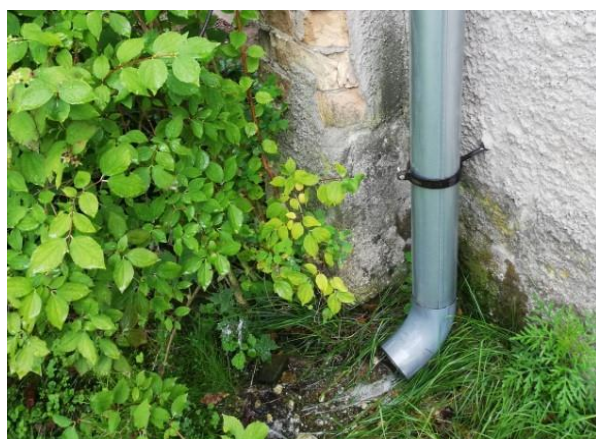
4.1.8.att. Nokrišņu ūdens netiek novadīts prom no pamatiem.
