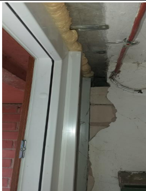
4.13.6.att. Kāpņu telpā iebūvētas PVC durvis nav hermetizētas un ap tām nav atjaunota apdare
