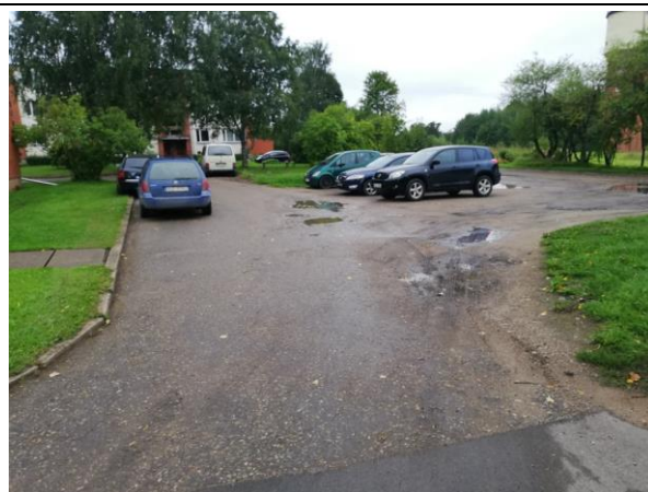
3.1.2.att. Brauktuve – neapmierinošā stāvoklī.
