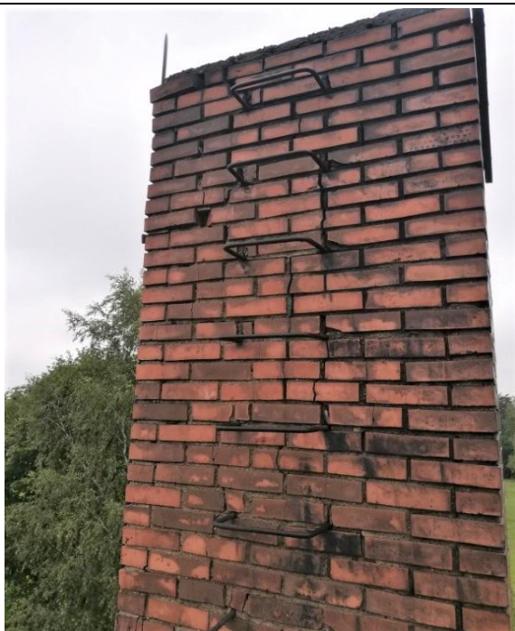
4.14.3.att. Katlu mājas dūmenis, mūra izdrupumi augšdaļā.
