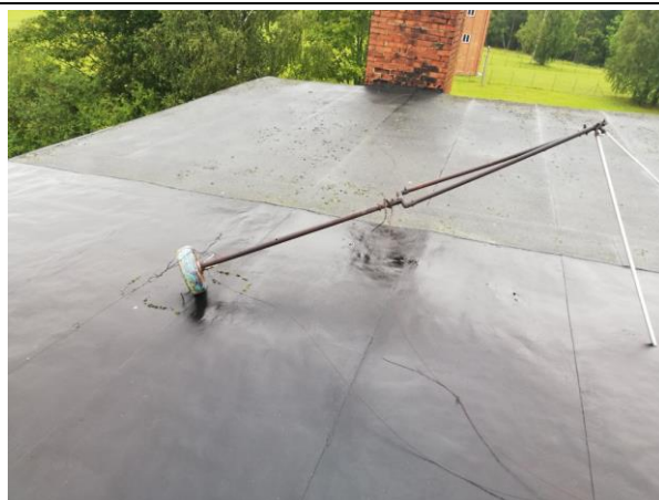
4.8.2.att. Jumta segums apmierinošā stāvoklī. Antenas uz jumta nav nostiprinātas.
