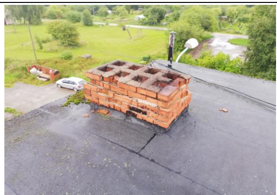
4.8.11. att. Ventilācijas izvada mūris erodējis.
