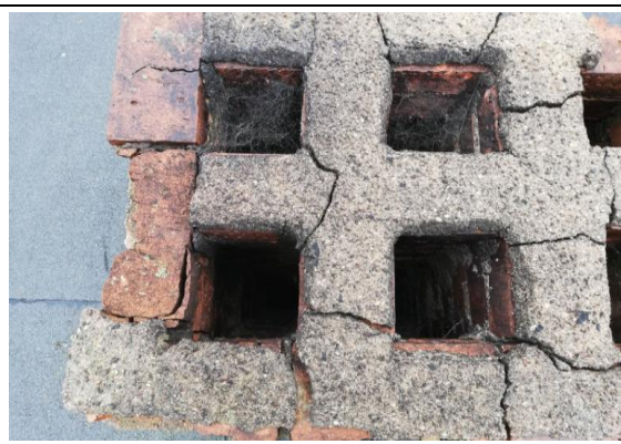
4.8.12.att. Ventilācijas izvada javas kārtā saplaisājusi un neaizsargā mūri no mitruma.
