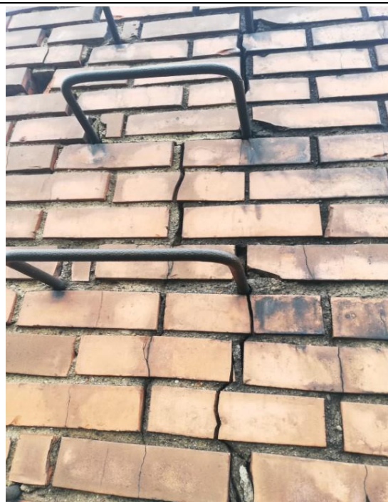
4.14.4.att. Katlu mājas dūmenim bīstami pakāpieni.
