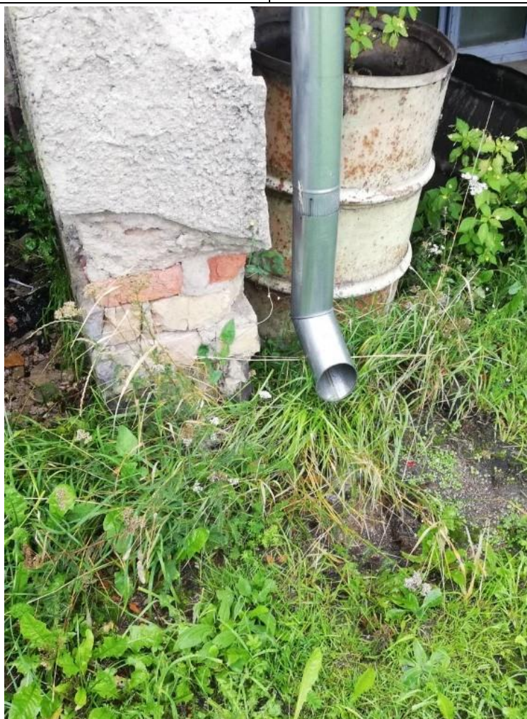
4.8.17.att. Nav novērsta lietus ūdeņu tieša ietekme uz ēkas ārsienu, pamatiem, konstrukcijām, noteku nepieciešams ievadīt lietus kanalizācijā.
