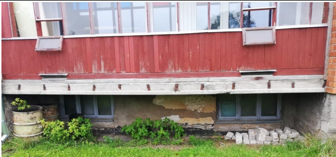
4.9.1.att. Ugunsgrēka rezultātā bojāta lodžijas pārseguma plātne – plaisas, izdrupumi un atkailināts stiebrojums. Konstatēta liece, kas ir pieļaujamo deformāciju robežās.
