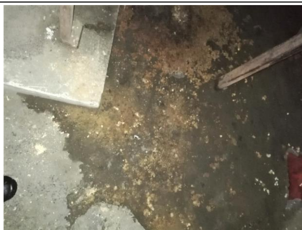
4.5.8. att. Mitrums iekļūst ēkas pagrabā caur kurināmā noliktavas jumta lūku.
