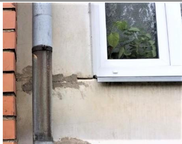
4.4.3.att. Nekvalitatīvi aizdrīvētas sprauga starp paneļiem.
