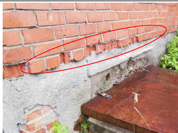
4.2.4.att. Mūra erozija gala sienā.
