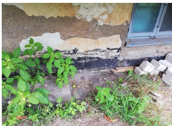
4.1.7.att. Ēkai aizsargapmale deformēta
