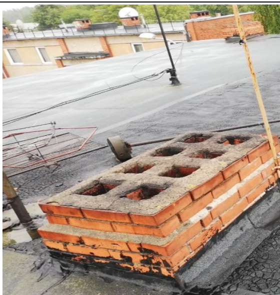
4.8.14.att. Antenas uz jumta nav nostiprinātas.
