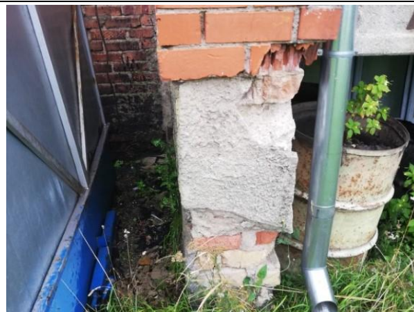
4.2.6.att. Ķieģeļu mūra izdrupums lodžijas paneļa un starpsienas balsta vietā.
