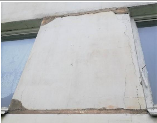
4.4.2.att. Gāzbetona piekarinātie sienu paneļu bojājumi, izdrupumi.
