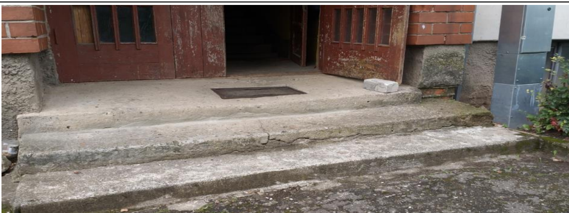
4.9.7.att. Lieveņa bojāti pakāpieni, betona destrukcija.
