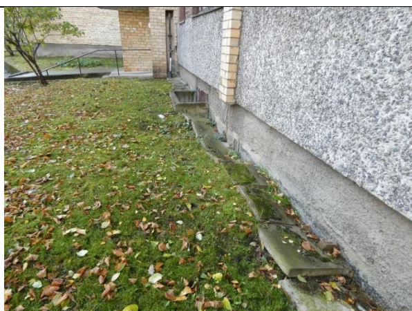
4.1.9.att. Ēkas aizsargapmales no plātnēm deformācija pa visu ēkas perimetru
