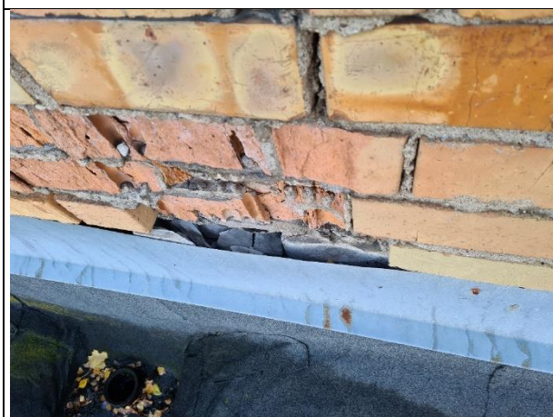
4.8.23.att. Ventilācijas kanālu ķieģeļu mūris ar izdrupumiem, kas radušies mitruma un sala iedarbības rezultātā
