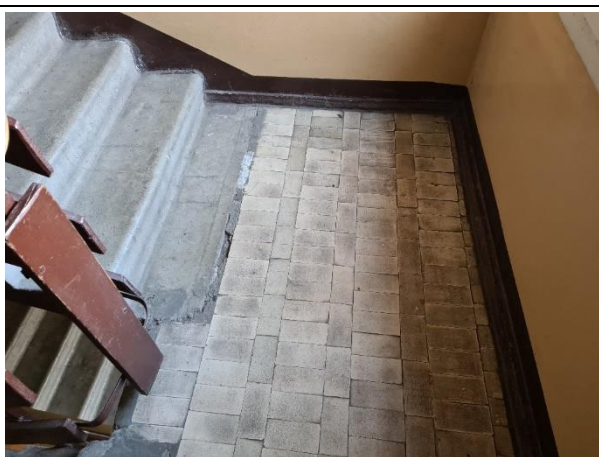
4.10.5.att. Kāpņu konstrukcijas labā tehniskajā stāvokli. Nebūtiski seguma bojājumi un izdrupumi.
