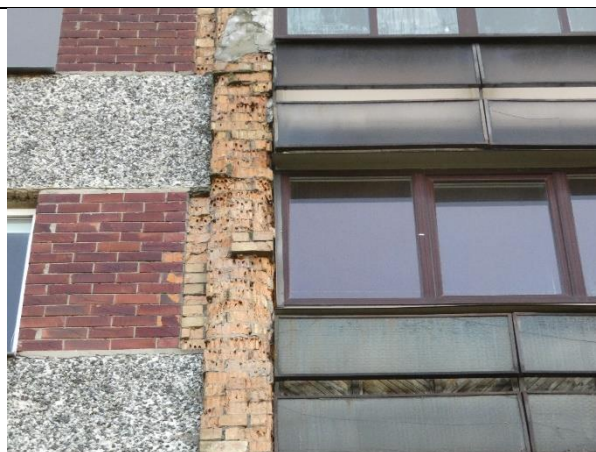
4.2.7.att. Mūra erozija nesošās mūra sienas vidusdaļā (2.sekcija)
