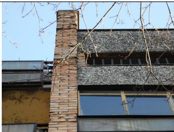
4.2.9.att. Izdrupumi nesošās mūra sienas augšdaļā pie jumta parapeta (2.sekcija)
