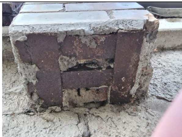
4.2.19.att. Nesošās mūra šķērssienas pilastra balsta konstrukcija ar korozijas bojājumiem, skats no apakšas
