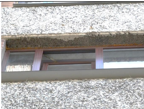
4.4.3.att. Keramzītbetona ārsienu paneli. Paneļa apakšējai virsmai nav veikta apdare
