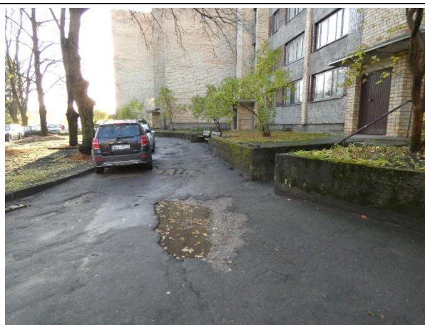
3.1.4.att. Brauktuves ēkas ZA pusē ar asfaltbetona segumu. Konstatējamas bedres un izdrupumi.
