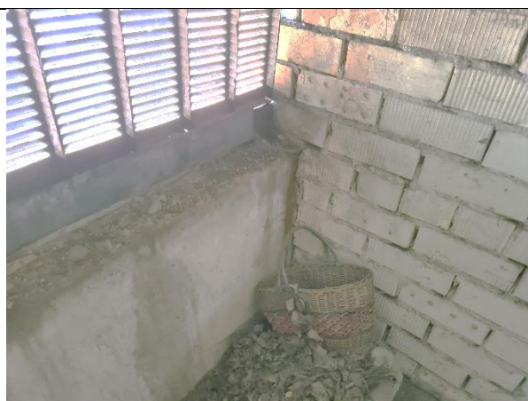
4.4.8. att. Mitruma pazīmes 4.kāpņu telpas bēniņos
