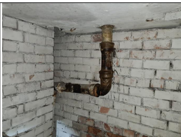
4.8.26.att. Jumta lietus ūdens kanalizācijas notekcaurule (čuguna)
