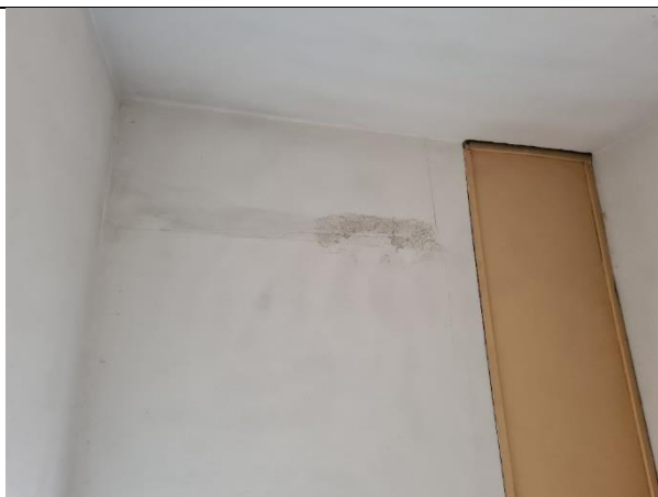
4.4.5.att. Mitruma bojājumi starppaneļu šuves zonā 1.kāpņu telpā
