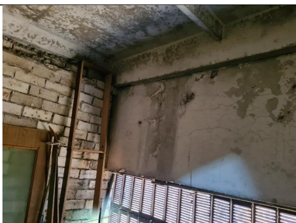
4.4.7. att. Mitruma infiltrācijas pazīmes uz jumta plātnes un ārsienu paneļa, 4.kāpņu telpas bēniņi
