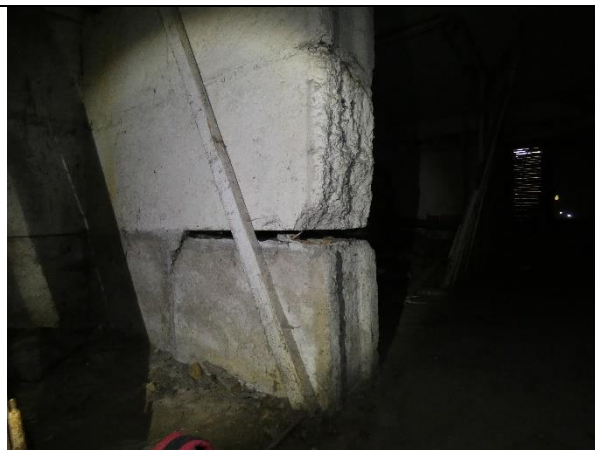
4.1.6.att. Pamatu bloka deformācija ēkas pagrabā. Nepieciešams aizpildīt šuvi ar birstošo remontjāvu.
