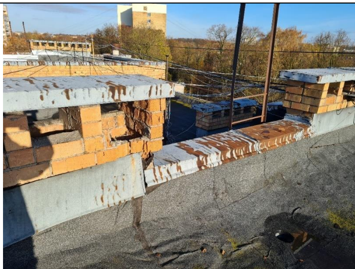
4.14.3.att. Ventilācijas šahtas mūra ķieģeļi ar sala un mitruma radītiem bojājumiem
