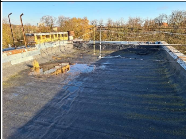
4.8.16.att. Jumta klājs ar neatbilstošu kritumu, krājas ūdens
