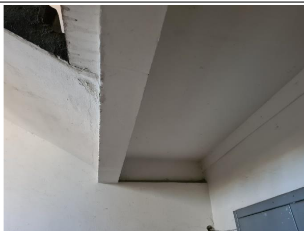
4.10.4.att. Kāpņu konstrukcijas labā tehniskajā stāvokli
