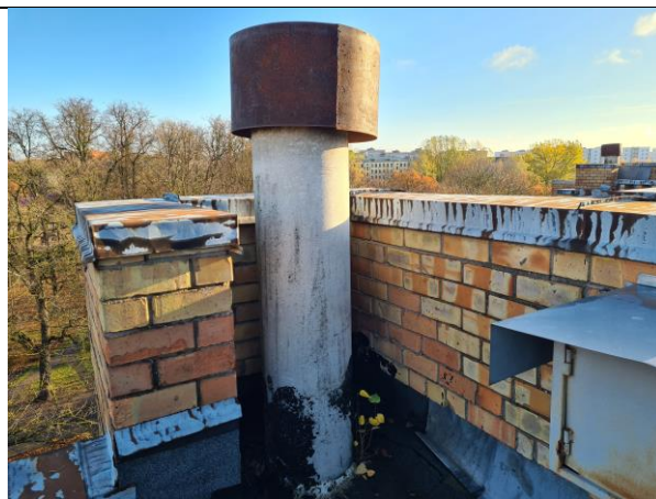
4.16.2.att. Atkritumu vada ventilācijas izvads virs jumta ar korozijas bojājumiem
