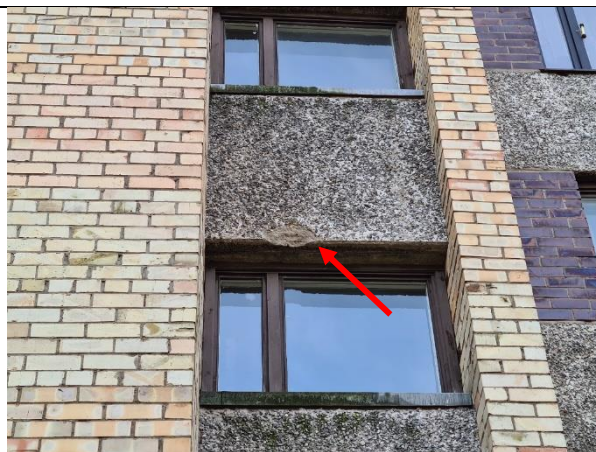
4.4.6.att. Ārsienu paneli ar mehāniskiem bojājumiem transportēšanas vai montāžas laikā
