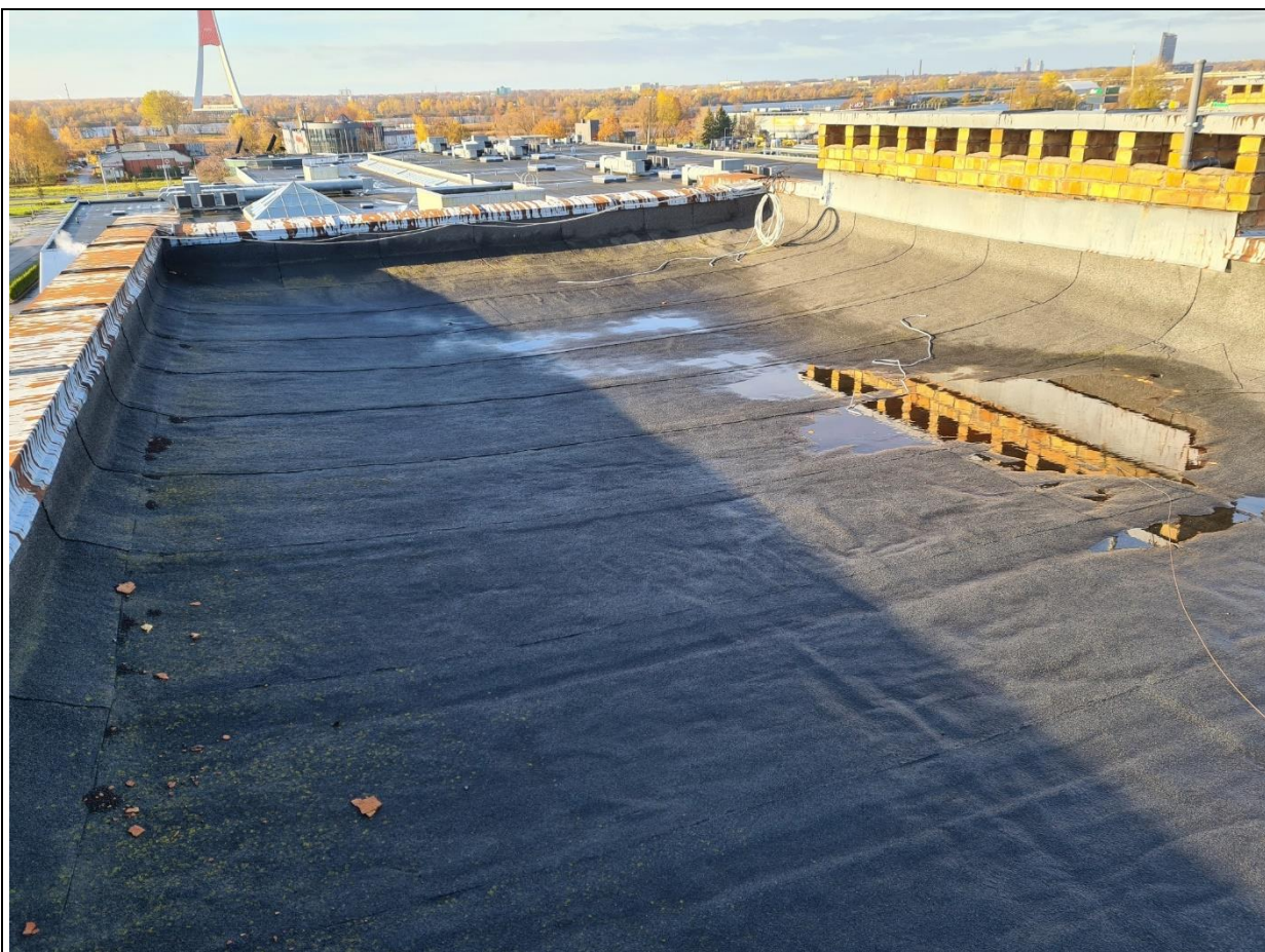
4.8.18.att. Jumta segums apmierinošā tehniskajā stāvoklī, vietām iesēdumi, kur krājas ūdens
