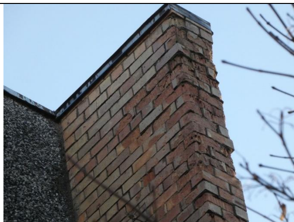
4.2.5.att. Izdrupumi nesošās mūra sienas augšdaļā pie jumta parapeta (3.sekcija)
