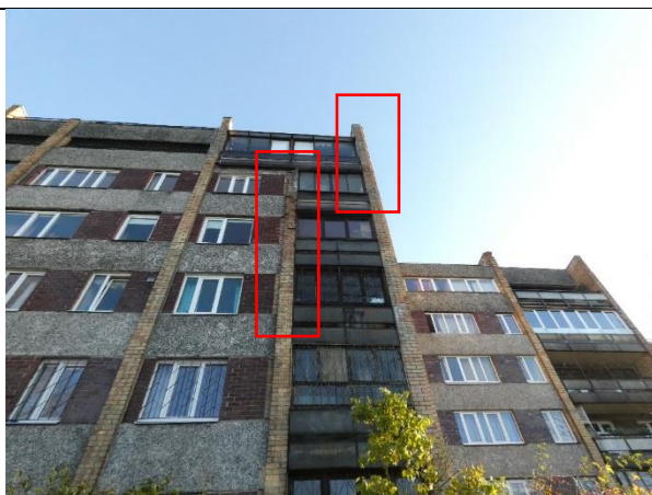
4.2.6.att. Mūra erozija nesošās mūra šķērssienas augšdaļā pie jumta parapeta (2.sekcija). Sk.kopā ar att. 4.2.7., 4.2.8.
