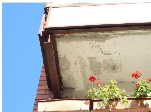
4.9.7.att. Konsolsija un lodžijas norobežojošo elementu metāla konstrukciju elementi korodējuši, bez aizsargpārklājuma. Nepieciešams veikt to pretkorozijas apstrādi. Konsolsijas balsta vieta labā stāvoklī.
