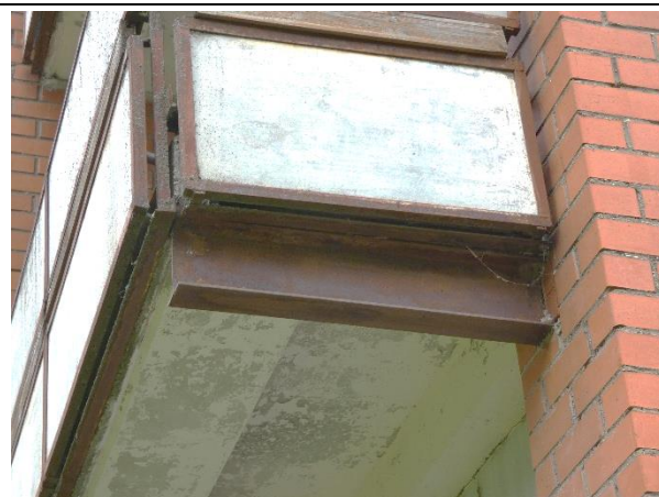
4.9.11.att. Konsolsija un lodžijas norobežojošo elementu metāla konstrukciju elementi korodējuši, bez aizsargpārklājuma. Nepieciešams veikt to pretkorozijas apstrādi. Konsolsijas balsta vieta bez atbalsta spilvena, deformācijas nav novērotas
