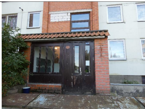
4.12.4.att. Koka durvis un ailas ar stiklojumu ēkas ieejas mezglos. Nepieciešams atjaunot durvju krāsojumu.
