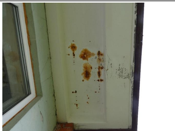
4.9.9.att. Lodžijas ribotās pārseguma plātnes stiegrojums ar korozijas bojājumiem. Visdrīzāk, bojājumi radušies mitruma iedarbības un nepietiekamas betona aizsargkārtas dēļ.
