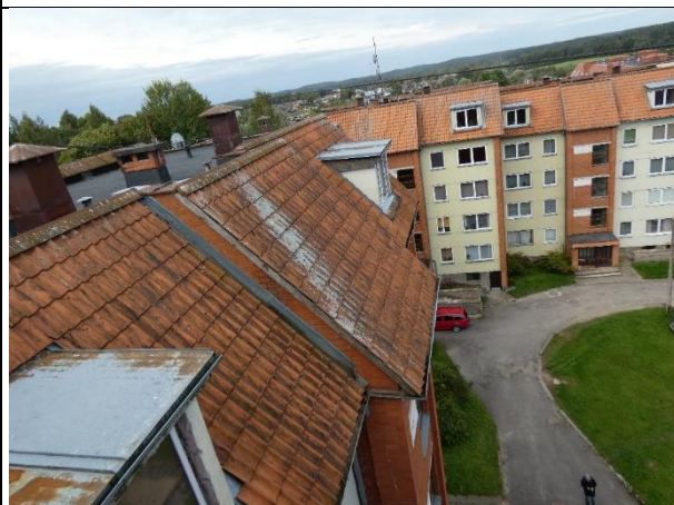
4.8.17.att. Māla dakstiņu segums ar apaugumu un notecējumiem
