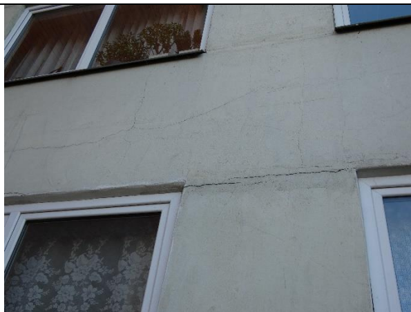
4.4.8.att. Ārsienu paneļi ar plaisām
