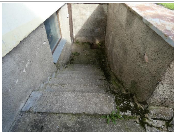
4.10.6.att. Kāpnes uz pagrabu ar betona struktūras bojājumiem un apaugumu
