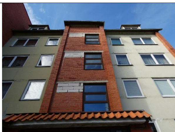
4.2.2.att. Dzelzsbetona pārsedzes virs kāpņu telpas logu ailām, kas daļēji aizmūrētas ar gāzbetona blokiem, nav pabeigta apdare
