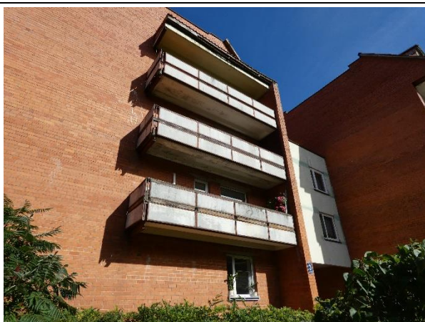
4.9.6.att. Lodžijas ēkas dienvidu fasādes pusē (3. sekcija). Lodžiju pārsegums balstīts uz nesošās ķieģeļu mūra šķērssienas un uz metāla dubult-T profila konsolsijas.
