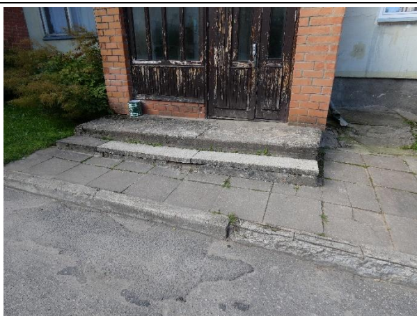
4.10.5.att. Kāpnes pie ieejas mezgla ar betona struktūras bojājumiem
