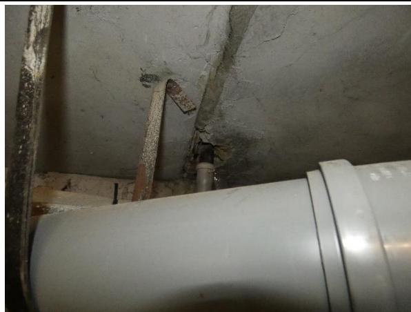
4.6.2.att. Neaizdarītas atveres pagraba pārsegumā
