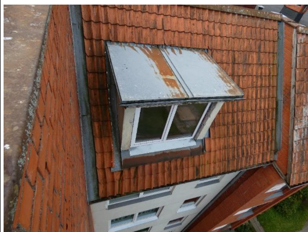
4.8.8.att. Mansarda stāva logu konstrukcijas jumtiņa valcētā skārda loksnes ar korozijas bojājumiem
