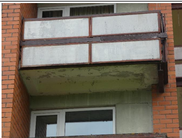
4.9.10.att. Konsolsija un lodžijas norobežojošo elementu metāla konstrukciju elementi korodējuši, bez aizsargpārklājuma. Nepieciešams veikt to pretkorozijas apstrādi. Konsolsijas balsta vieta labā stāvoklī.
