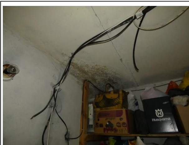
4.8.1.att. Jumta dzelzsbetona pārseguma plātnes ar mitruma bojājumiem 5.stāvā
