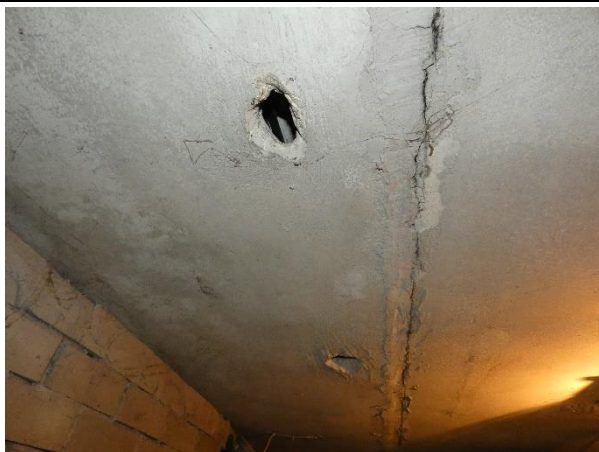
4.6.1.att. Neaizdarītas atveres pagraba pārsegumā
