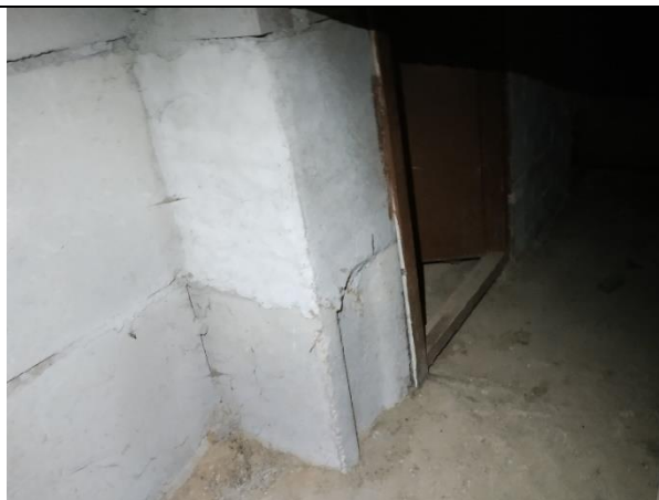
4.1.5.att. Pamatu bloki ēkas pagrabā, labā stāvoklī
