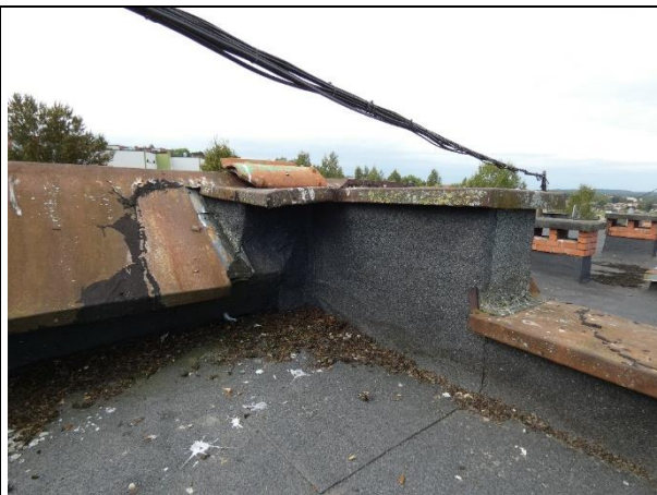
4.8.16.att. Jumta segums apmierinošā tehniskajā stāvoklī, skārda detaļas korozijas bojājumiem
