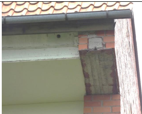
4.2.4.att. Mūra šķērsnesošā gala siena ārpus pilastra, balstīta uz konsoles, kas izbūvēta no metāla konstrukcijas un monolītā dzelzsbetona. Metāla konstrukcijas ar korozijas pazīmēm, nepieciešams veikt to pretkorozijas apstrādi.
