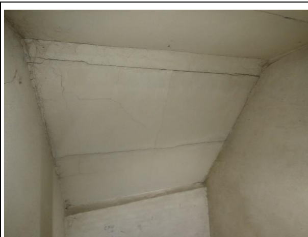
4.8.2.att. Savietotā jumta dzelzsbetona pārseguma plātnes kāpņu telpā. Plaisas
