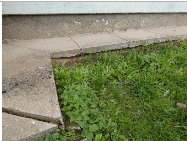
4.1.9.att. Aizsargapmale ar deformācijas pazīmēm, apmales pamatne izskalota
