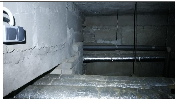
4.1.4.att. Pārsedzes balsta vieta uz pamatu blokiem tehniskajā gaitenī, ķieģeļu mūra iecirkņi. Pārsedze balstīta uz ķieģeļu mūra, kas nav atbilstoši Projekta norādēm
