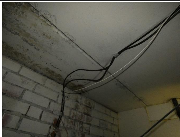
4.6.4.att. Savietotā jumta pārseguma plātnes ar mitruma bojājumiem, kas radušies dēļ bojāta jumta seguma
