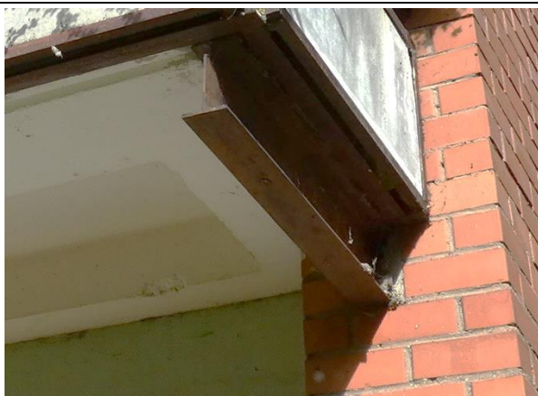
4.9.8.att. Konsolsija un lodžijas norobežojošo elementu metāla konstrukciju elementi korodējuši, bez aizsargpārklājuma. Nepieciešams veikt to pretkorozijas apstrādi. Konsolsijas balsta vieta labā stāvoklī.
