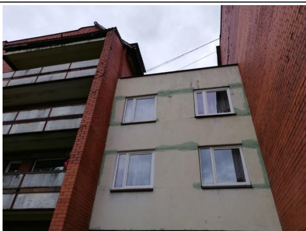
4.5.1.att. Starppaneļu šuves neapmierinošā tehniskā stāvoklī
