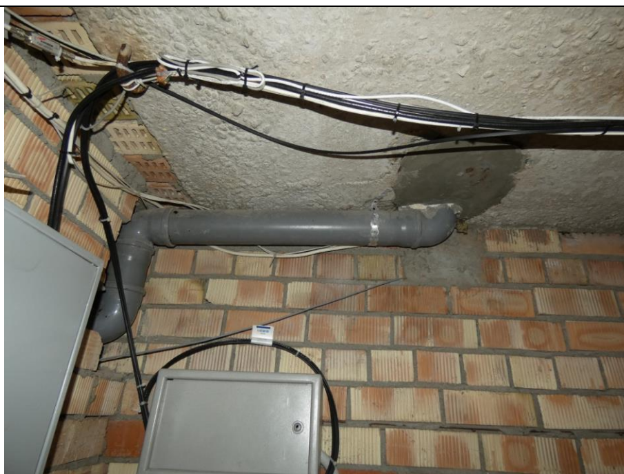
4.8.20. att. Jumta lietus ūdens kanalizācijas notekcaurule
