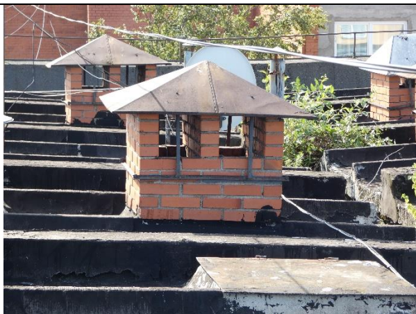
4.14.1. att. Ķieģeļu mūra ventilācijas šahtu izvadi. Jumtiņi ar korozijas bojājumiem.
