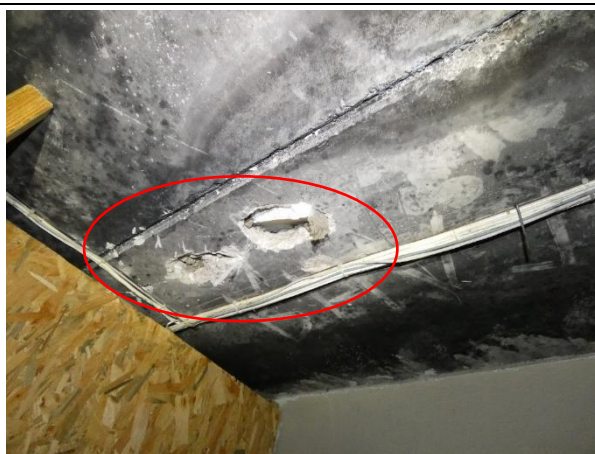
4.6.2.att. Neaizdarītas atveres pagraba pārsegumā, ugunsgrēka rezultātā apkvēpis pārsegums
