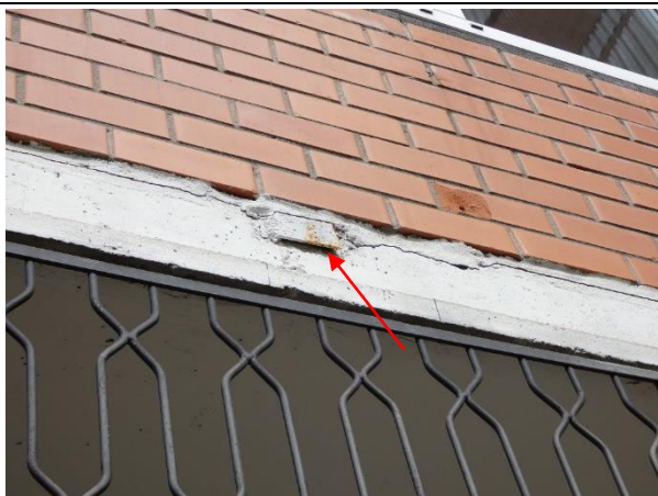
4.6.3.att. Lodžiju pārseguma plātņu ieliekamo detaļu korozija
