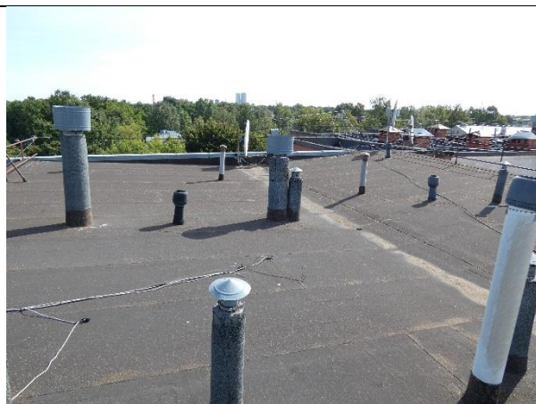
4.14.4. att. Cinkotā skārda un PVC ventilācijas izvadi
