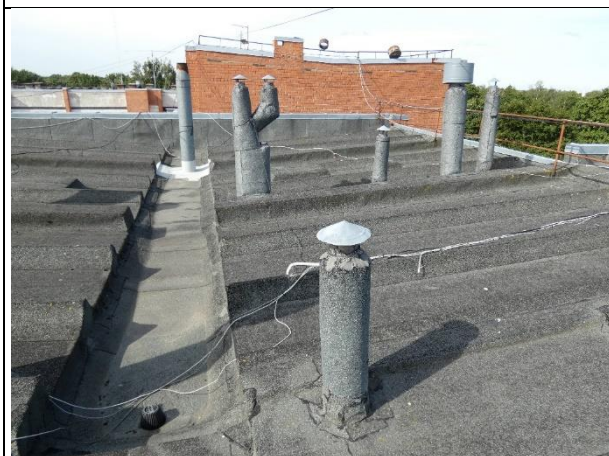
4.8.16.att. Jumta segums labā tehniskā stāvoklī
