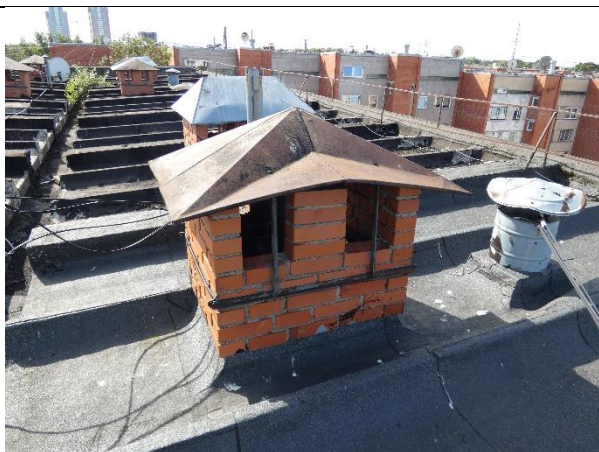
4.14.3. att. Ķieģeļu mūra ventilācijas šahtu izvadi. Jumtiņi ar korozijas bojājumiem.
