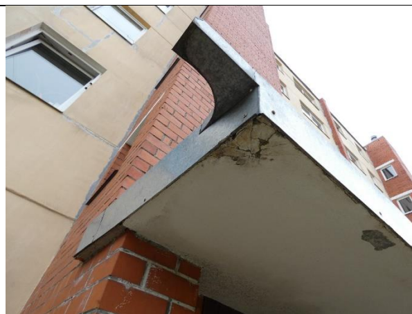
4.9.6.att. Betona struktūras bojājumi mitruma iedarbībā
