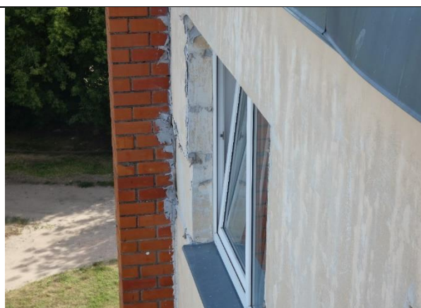
4.4.4. att. Ārsienu paneļi ar apdares bojājumiem
