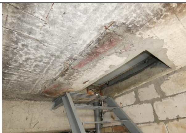
4.8.6.att. Jumta klāja dzelzsbetona plātnes ar mitruma bojājumiem
