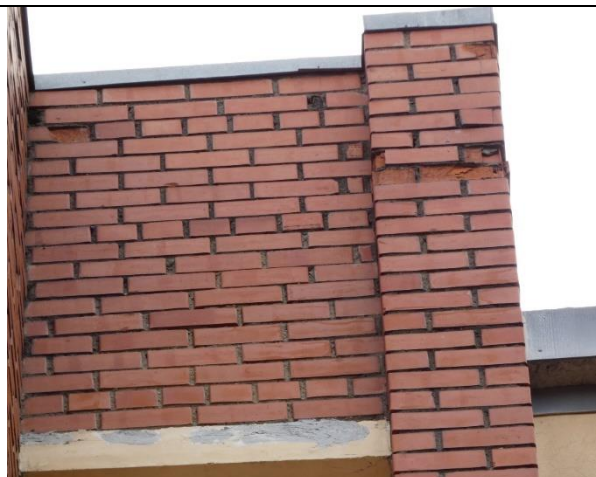
4.2.11.att. Kāpņu telpas ārsienā ķieģeļu mūra izdrupumi
