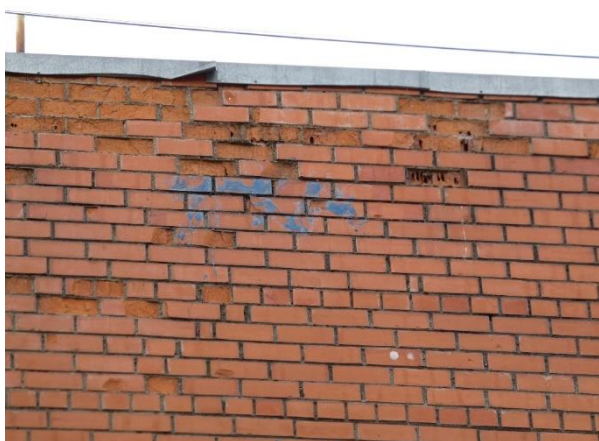
4.2.10.att. Ēkas gala sienā ķieģeļu mūra izdrupumi, bojāts skārda nosegelements
