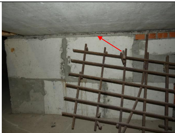
4.1.6.att. Pamatu bloki ēkas pagrabā, virs pagraba sienu blokiem cementa javas kārtā 50 mm biezumā ar stiebrojumu. Atsegtais stiebrojums ar korozijas pazīmēm.
