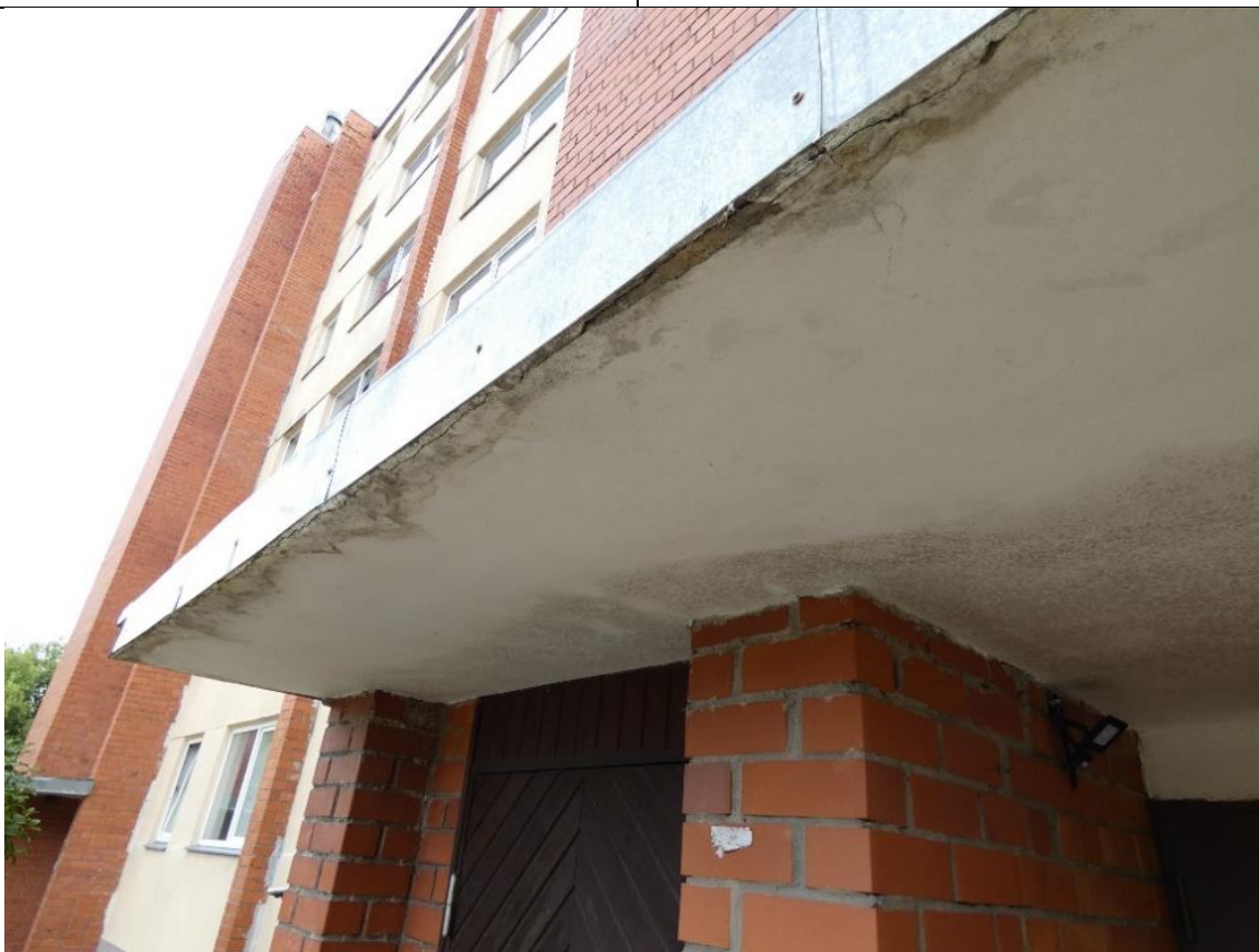
4.9.9.att. Betona struktūras bojājumi mitruma iedarbībā
