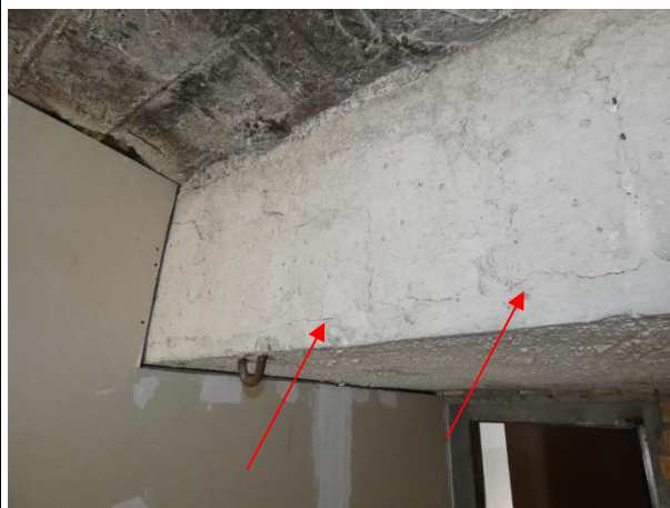
4.8.2.att. Dzelzsbetona teknes elementam plaisas stiebrojuma vietā – iespējams, nekvalitatīvs būvizstrādājums
