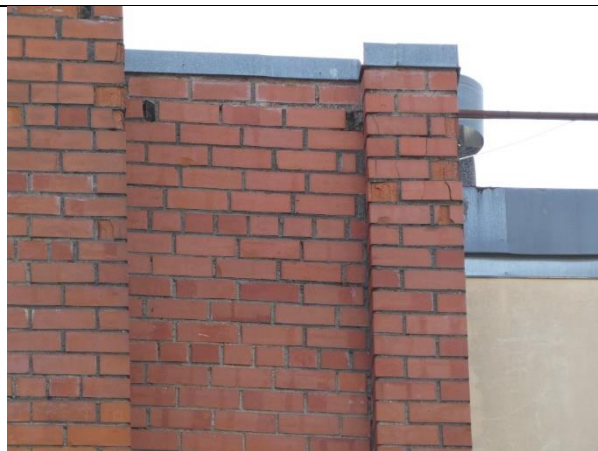
4.2.2.att. Kāpņu telpas nesošās mūra sienas ar ķieģeļu mūra izdrupumiem
