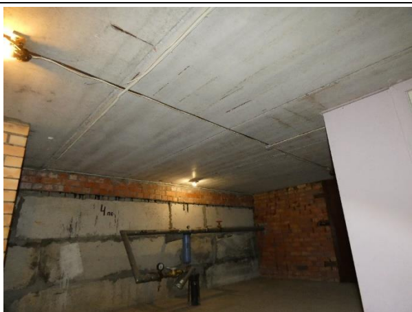
4.6.1.att. Pagraba pārseguma plātņu stiegrojuma betona aizsargkārtā nav atbilstoša (ražošanas defekts). Atsegts, korodējis stiegrojums.
