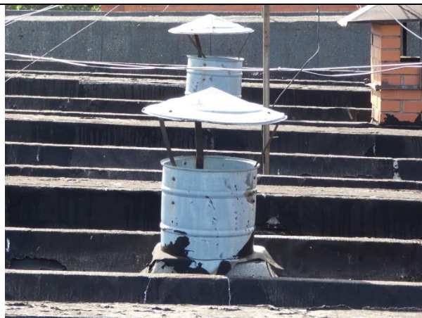
4.14.2. att. Cinkotā skārda ventilācijas izvadi
