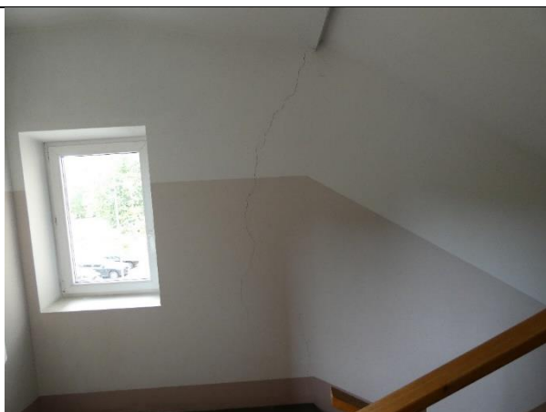
4.2.14.att. Plaisa 1.kāpņu telpas mūra sienā. Sk. kopā ar att. 4.2.15.
