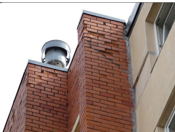
4.2.9.att. Kāpņu telpas ārsienā ķieģeļu mūra izdrupumi
