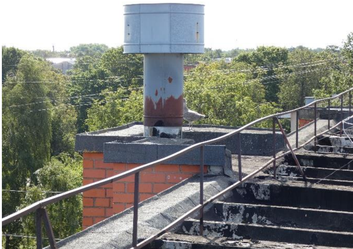
4.16.3.att. Atkritumu vada ventilācijas izvads virs jumta ar korozijas bojājumiem
