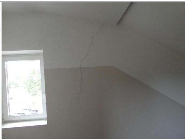
4.2.16.att. Plaisa 1.kāpņu telpas mūra sienā. Sk. kopā ar att. 4.2.17.
