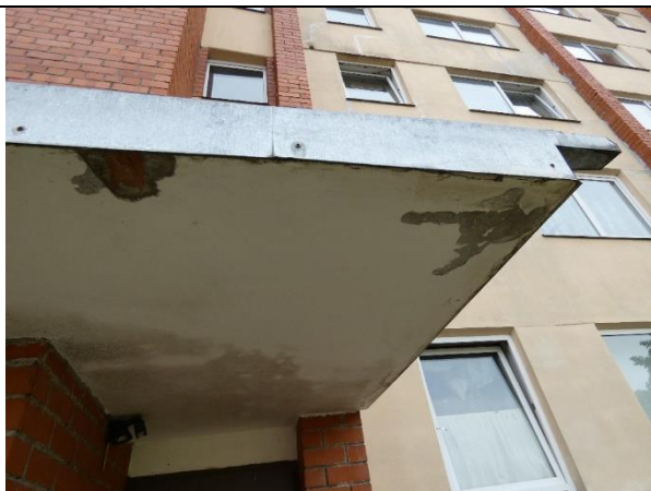
4.9.7.att. Betona struktūras bojājumi mitruma iedarbībā
