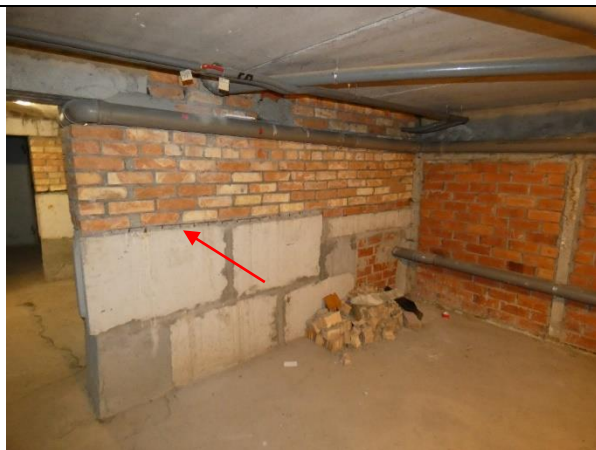
4.1.5.att. Pamatu bloki ēkas pagrabā, virs pagraba sienu blokiem cementa javas kārtā 50 mm biezumā ar stiebrojumu. Atsegtais stiebrojums ar korozijas pazīmēm.
