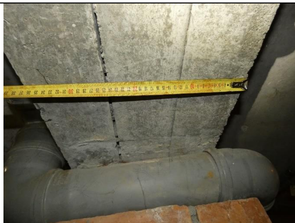
4.2.5.att. Dzelzsbetona gatavelementu pārsedzes pagrabā 120x250 mm(h)
