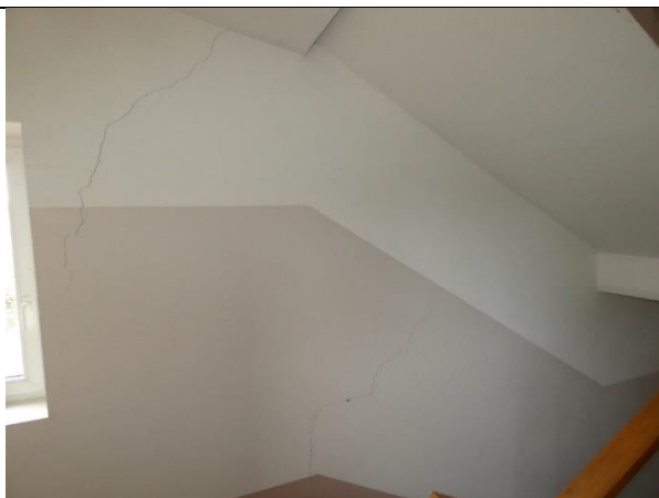
4.2.18.att. Plaisa 1.kāpņu telpas mūra sienā
