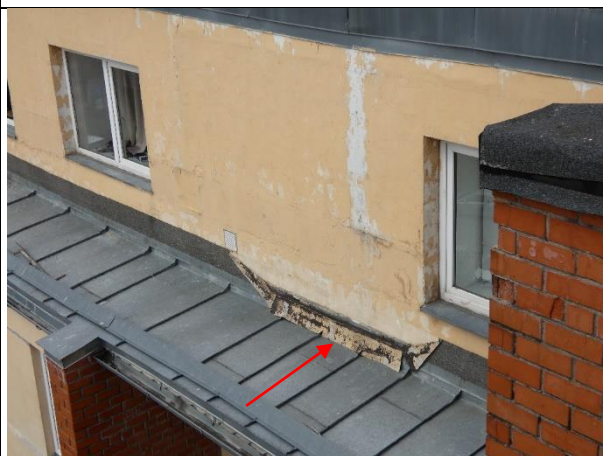
4.8.17.att. Bojāts ruberoīda hidroizolācijas pieslēgums ārsienas konstrukcijai virs 5.stāva
