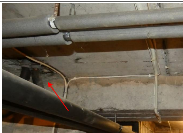
4.6.10.att. Nehermētiskas inženiertīklu šķērsojuma vietas pārsegumā
