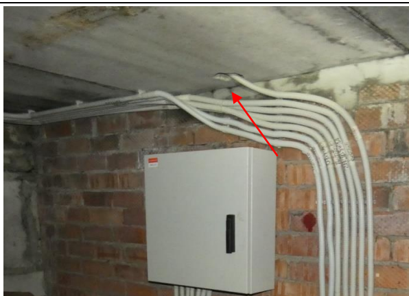
4.6.9.att. Nehermētiskas inženiertīklu šķērsojuma vietas pārsegumā
