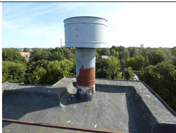
4.16.2.att. Atkritumu vada ventilācijas izvads virs jumta ar korozijas bojājumiem
