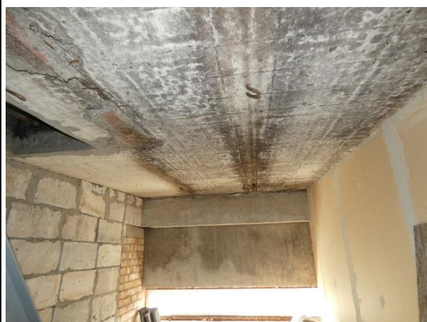
4.8.3.att. Jumta klāja dzelzsbetona plātnes ar mitruma radītiem bojājumiem
