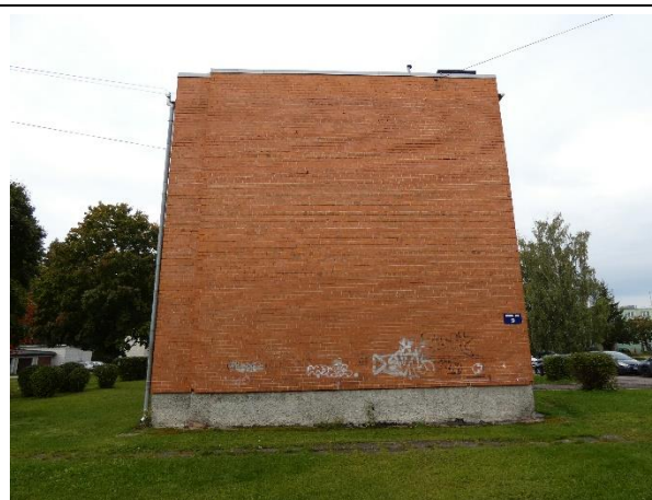
4.2.2.att. No nokrišņiem neaizsargāts gala sienas mūris. Ķieģeļu izdrupumi.
