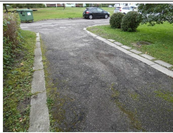
3.1.4.att. Ietves – daļēji apmierinošā stāvoklī.
