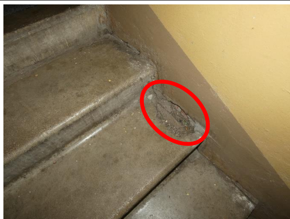
4.10.6.att. Dzelzsbetona laidumi ar lokāliem betona izdrupumiem.
