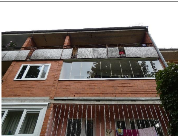
4.13.11. att. Lodžijām veidots dažāds ailu aizpildījums. Iespējami patvaļīga būvniecība.
