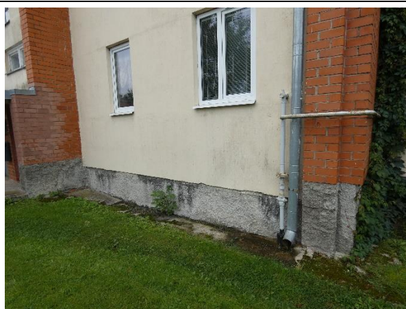
4.1.4.att. Bojāta ēkas aizsargapmale.
