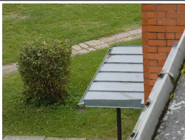
4.9.2.att. Jumtiņi virs ieejas mezgļiem daļēji apmierinošā stāvoklī.
