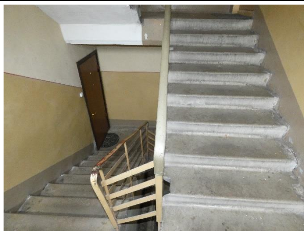
4.10.2.att. Dzelzsbetona kāpņu konstrukcijas apmierinošā stāvoklī. Iztrūkst vinila lenterī.
