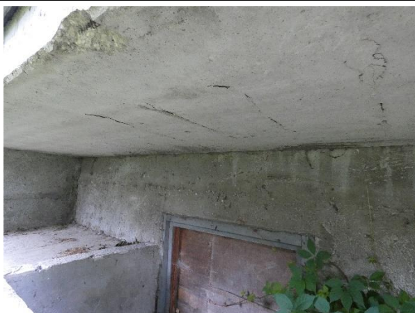
4.13.9. att. Pagraba logs aizstāts ar siltumizolācijas plātni. Neatbilstoši hermetizēts.
