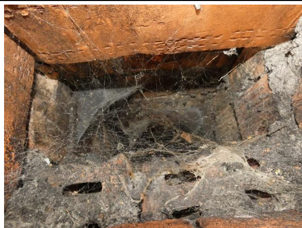
4.16.4.att. Mūrēto ventilācijas šahtu izvadi virs jumta līmeņa. Konstatēti netīrīti ventilācijas kanāli.
