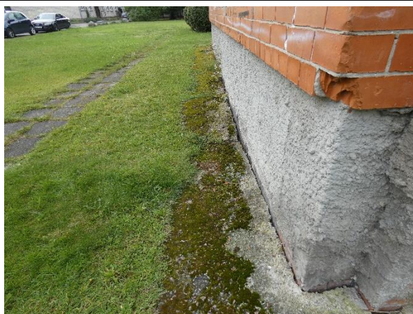
4.2.4.att. Ķieģeļa nošķelums nesošajā sienā virs cokola zonas.
