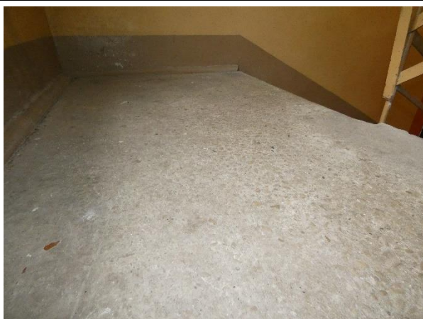
4.10.5.att. Dzelzsbetona laukumi ar lokāliem betona izdrupumiem.
