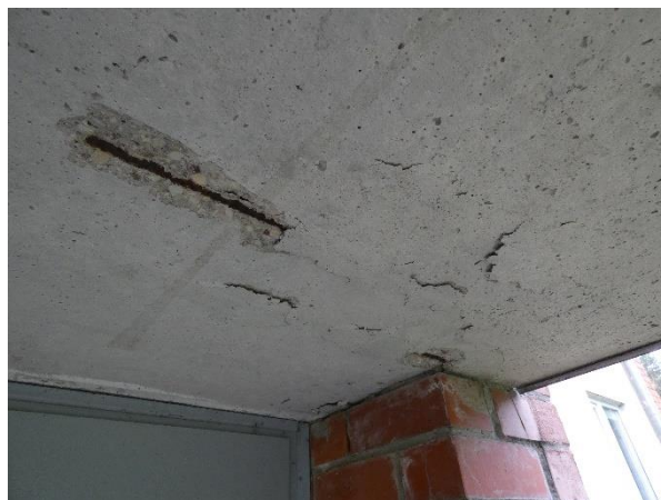
4.9.4.att. Mitruma pazīmes zem ieejas mezglā jumtiņiem. Betona izdrupumi.
