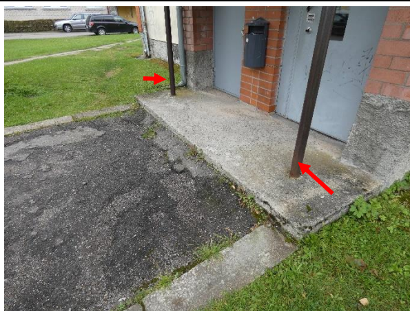
4.9.6.att. Ieejas lieveņi ar betona izdrupumiem. Tērauda kolonnas ar koroziju.
