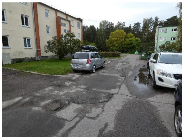
3.1.1. Brauktuves un ietves – daļēji apmierinošā stāvoklī.
