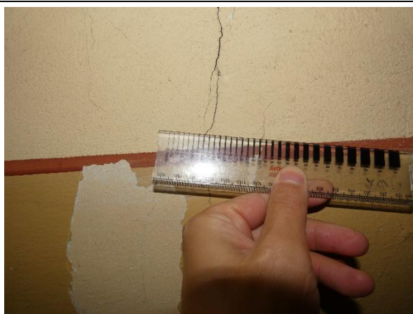
4.2.6.att. Kāpņutelpā konstatētas plaisas mūra nesošajā šķērssienā ar platumu līdz 0,35 mm.
