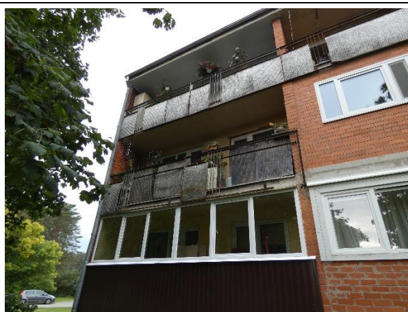
4.13.12. att. Lodžijām veidots dažāds ailu aizpildījums. Iespējami patvaļīga būvniecība.
