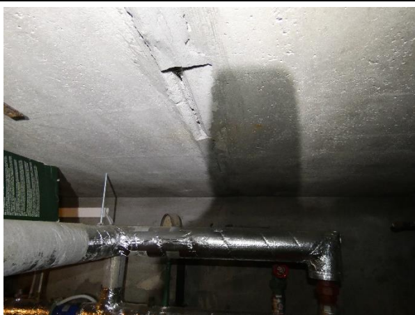
4.6.1. att. Pagraba pārseguma paneļi – apmierinošā stāvoklī. Lokāli starppaneļu javas aizpildījumu izdrupumi.
