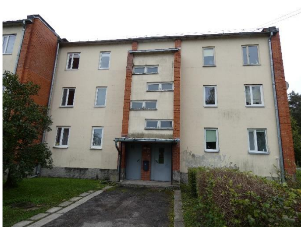
4.16.1. att. Ventilācijas restes ārsienās netika konstatētas.
