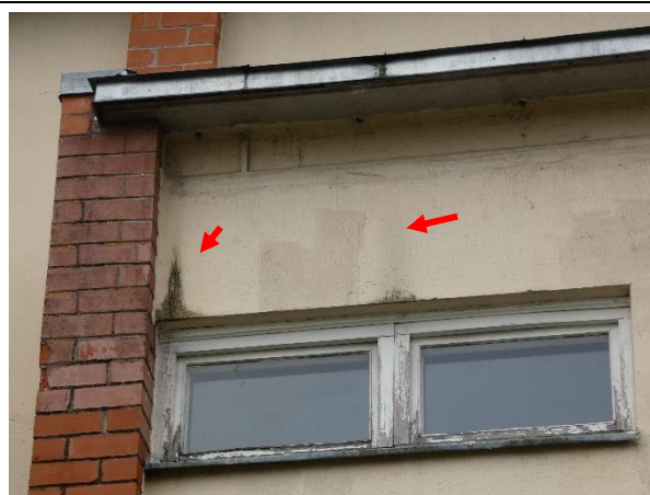
4.4.10.att. Fasādes apdares bojājumi. Ārsienu aizsardzība pret mitrumu samazināta.
