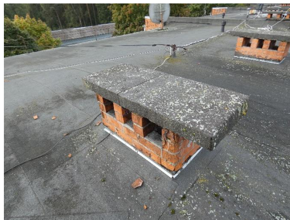
4.16.2. att. Mūrēto ventilācijas šahtu izvadi ar izdrupumiem virs jumta līmeņa.
