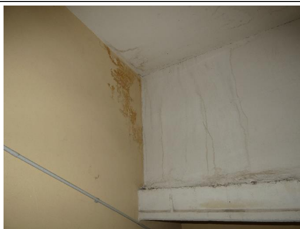
4.8.14.att. Mitruma infiltrācijas pazīmes kāpņu telpā. Iespējami nehermētiska starppaneļu šuves vieta.
