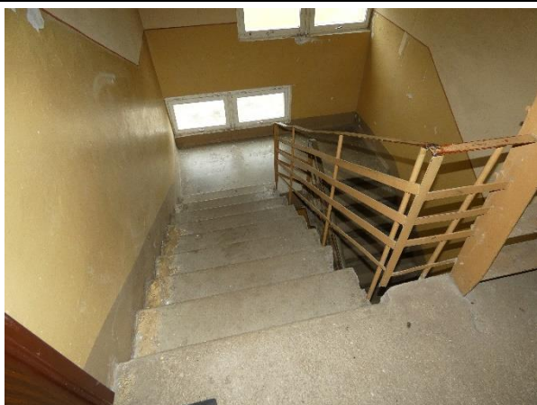
4.10.7.att. Kāpņu margas ar deformācijām.
