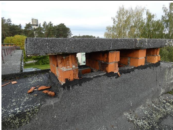
4.16.3.att. Mūrēto ventilācijas šahtu izvadi ar izdrupumiem virs jumta līmeņa.
