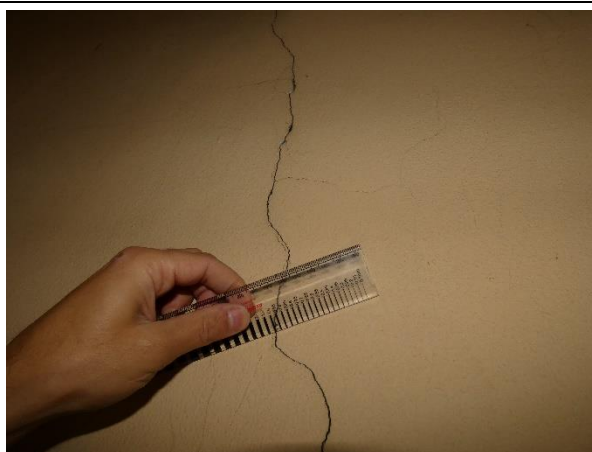
4.2.8.att. Kāpņutelpā konstatētas plaisas mūra nesošajā šķērssienā ar platumu līdz 1,0 mm.
