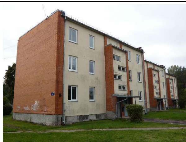
4.2.1.att. No nokrišņiem neaizsargāts gala sienas mūris
