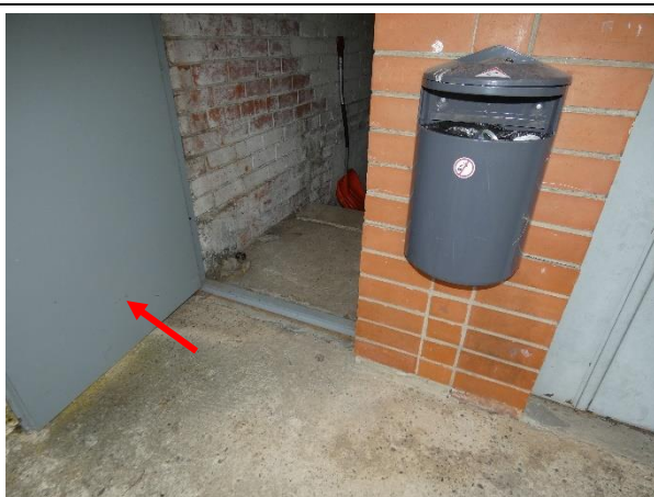
4.13.13. att. Pagrabā durvis metāla konstrukcijās – apmierinošā stāvoklī.
