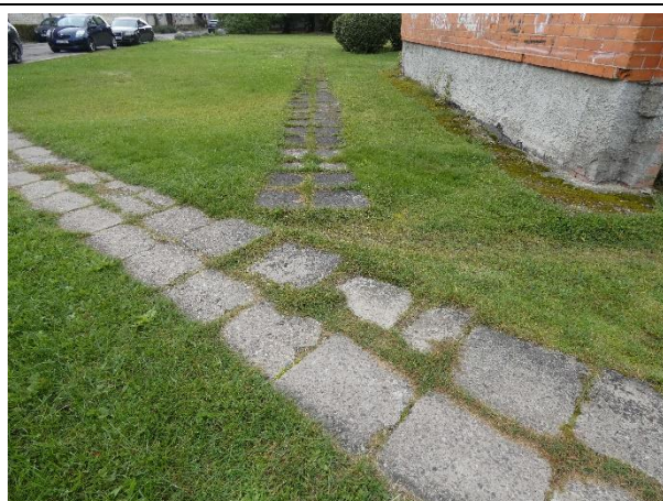
3.1.3.att. Ietves – daļēji apmierinošā stāvoklī.
