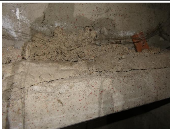
4.1.2.att. Saliekamā dzelzsbetona paneļu un ķieģeļu lentveida pamati - apmierinošā stāvoklī. Horizontālā hidroizolācija netika konstatēta.
