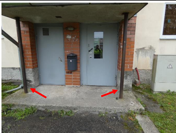
4.9.5.att. Ieejas lieveņi ar betona izdrupumiem. Tērauda kolonnas ar koroziju.
