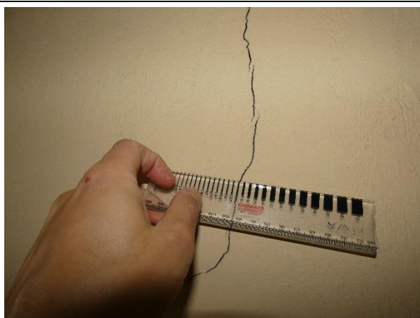
4.2.7.att. Kāpņutelpā konstatētas plaisas mūra nesošajā šķērssienā ar platumu līdz 1,0 mm.
