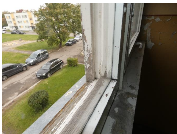
4.13.4. att. Kāpņutelpās koka futera tipa logi ar divkāršu stiklojumu. Lokālās vietās stiklojums bojāts vai iztrūkst.
