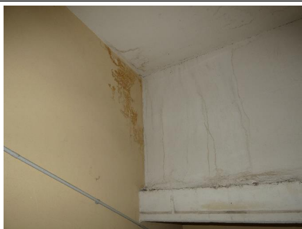
4.6.6. att. Pārsegums virs kāpņu telpas apmierinošā stāvoklī. Lokālas mitruma pazīmes paneļu sadurvietā.
