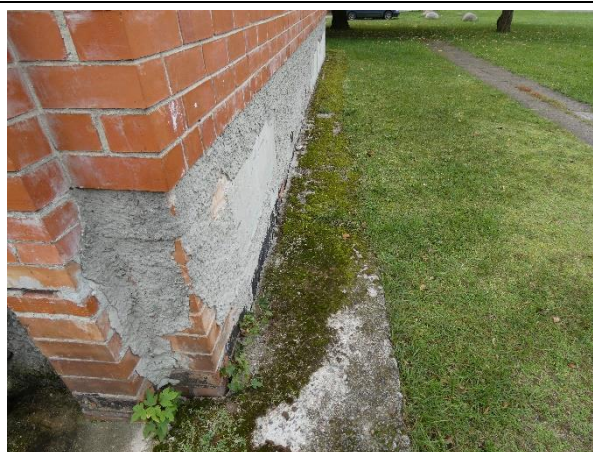
4.1.6.att. Cokola daļā vertikālā hidroizolācija netika konstatēta. Konstatēti apmetuma izdrupumi. Bojāta aizsargapmale.
