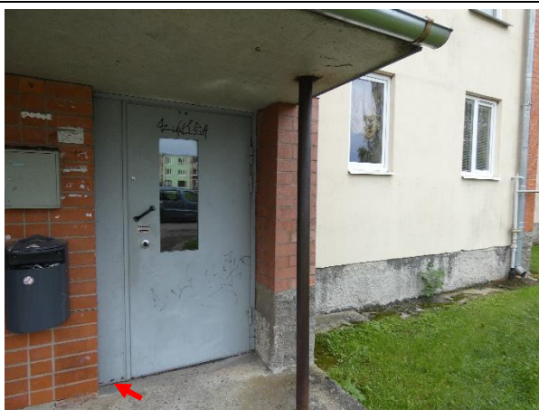
4.13.5. att. Kāpņutelpām metāla ārdurvis ar maznozīmīgu koroziju – apmierinošā stāvoklī.
