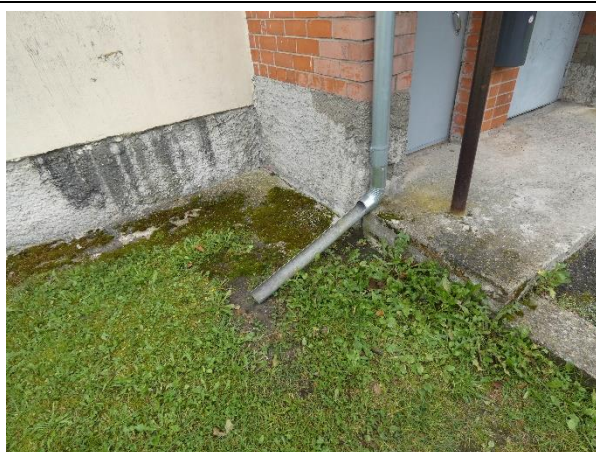
4.1.3.att.Bojāta ēkas aizsargapmale.
