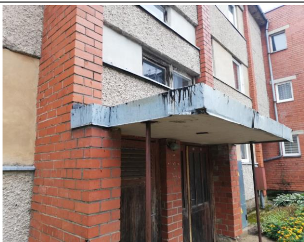
4.9.10.att. Jumtiņa skārda detaļas nav atjaunotas.
