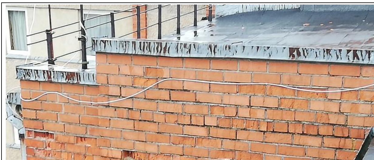
4.8.13. att. Skārda nasegdetāļu korozija.
