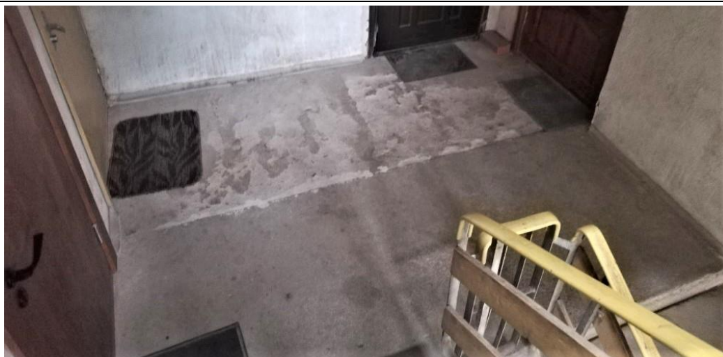
4.10.2.att. Ēkas kāpņu telpas laukumam nolietojies un izdrupis betona segums.
