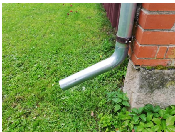
4.8.16.att. Noteka nav pieslēgta pie lietus kanalizācijas sistēmas. Notekcaurules posma garums nepietiekams, lai novērstu ūdens ietekmi uz ēkas konstrukcijām.
