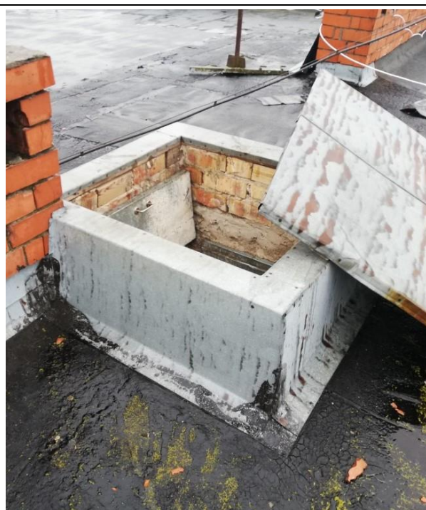
4.8.14.att. Jumta lūka ar koroziju.
