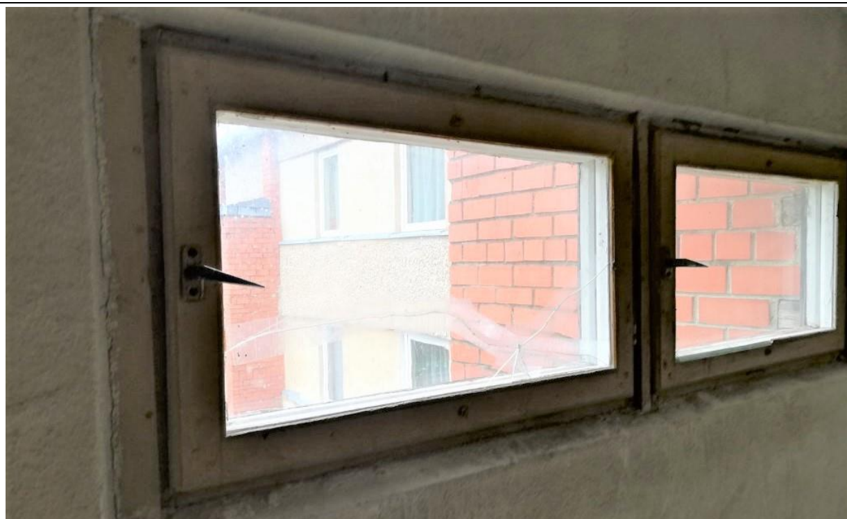
4.13.7.att. Nolietotojušies logi koka rāmjos.
