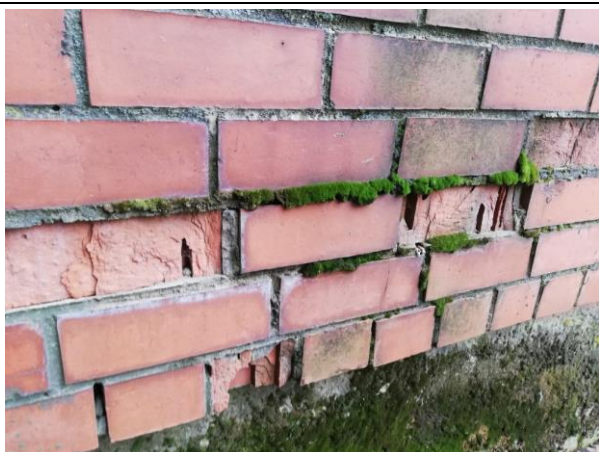
4.2.7.att. Mūra bojājumi gala sienas cokola līmenī.
