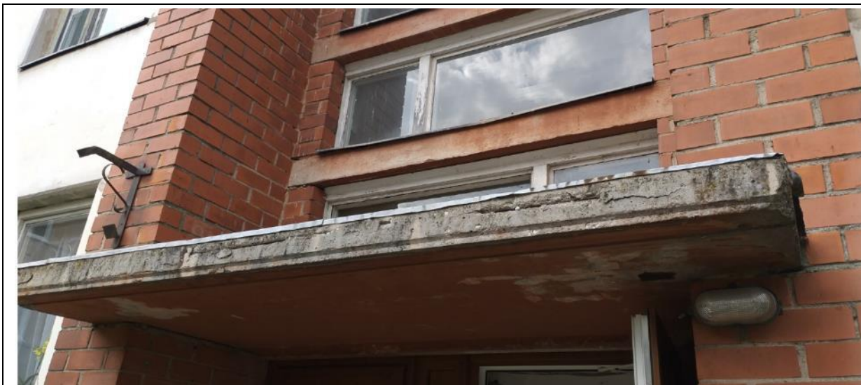
4.9.8.att. Uzjumteņa dzelzsbetona plātne ar betona struktūras bojājumiem un atsegtu korodējušu stiebrojumu, trūkst skārda detaļas.
