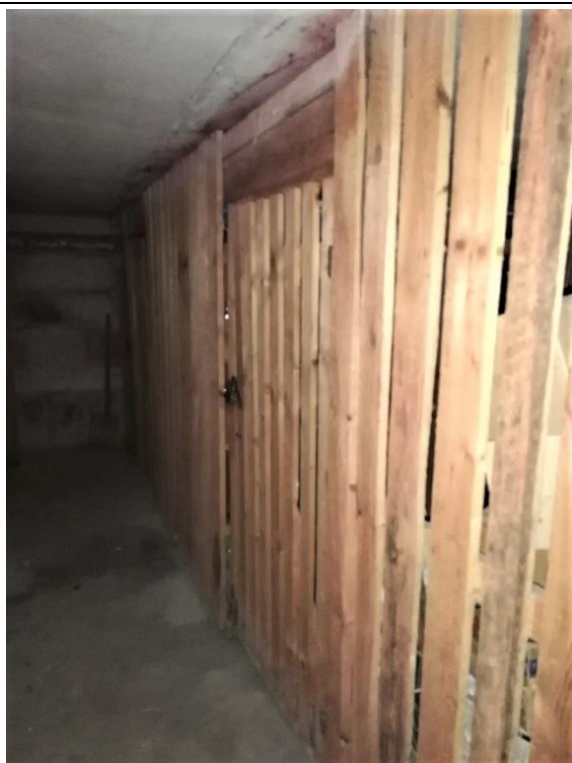
4.15.1.att. Pagrabstāvā izbūvēti šķūnīši un koka konstrukcijas – no degošiem kokmateriāliem.
