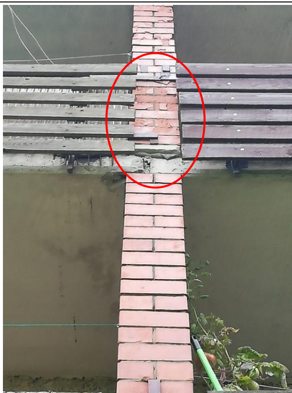
4.2.10.att. Nokrišņu ietekmē bojāts, erodējis mūris.
