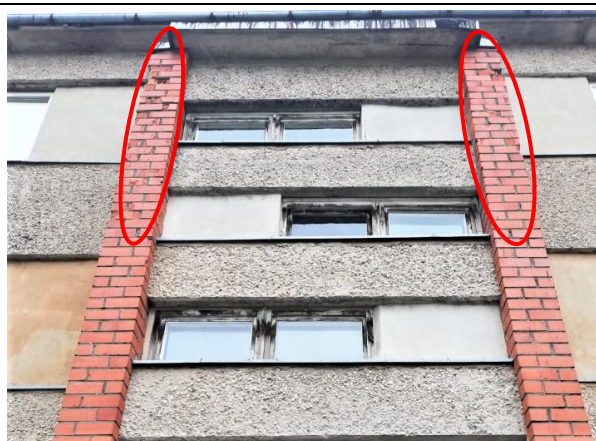
4.2.6.att. Ēkas nesošās ķieģeļu mūra šķērssienu 510 mm biezumā. Erodējušas mūra šķērssienu augšējās daļas.
