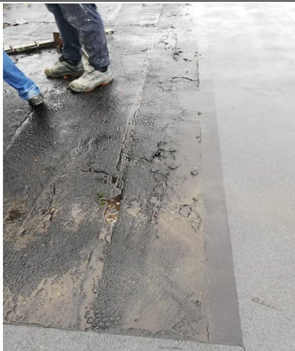
4.8.3.att. Daļā ēkas jumta segums ir nolietojies, tas ir neapmierinošā stāvoklī.
