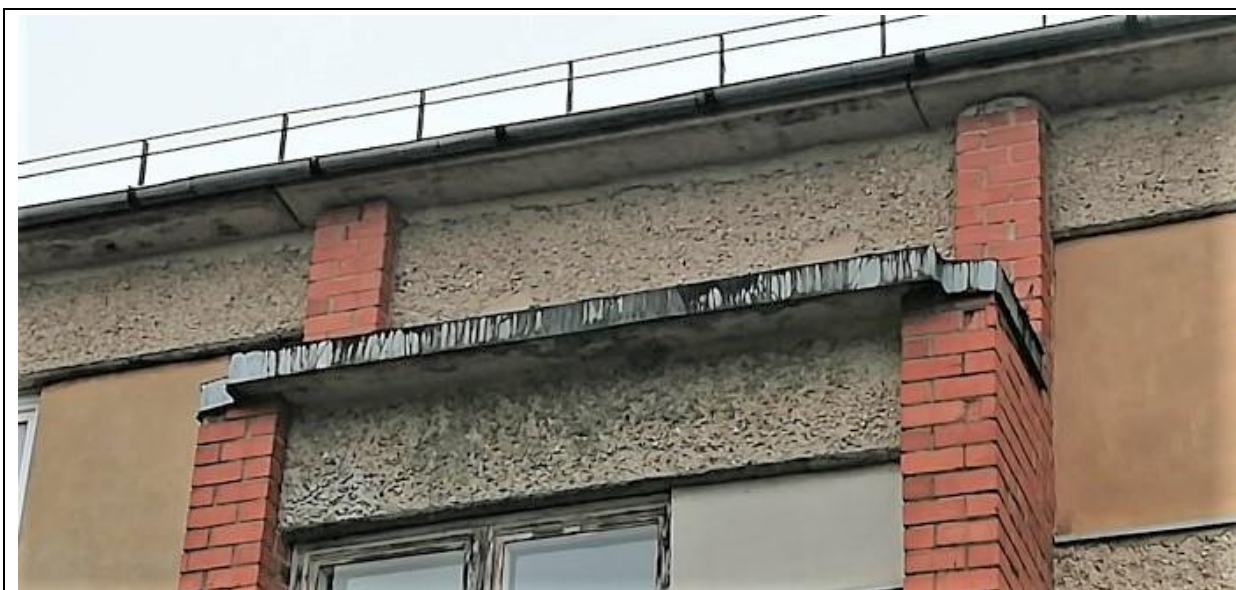
4.9.13.att. Mitruma ietekmē bojāta jumtiņa plātne, iesegums un skārda detaļas.
