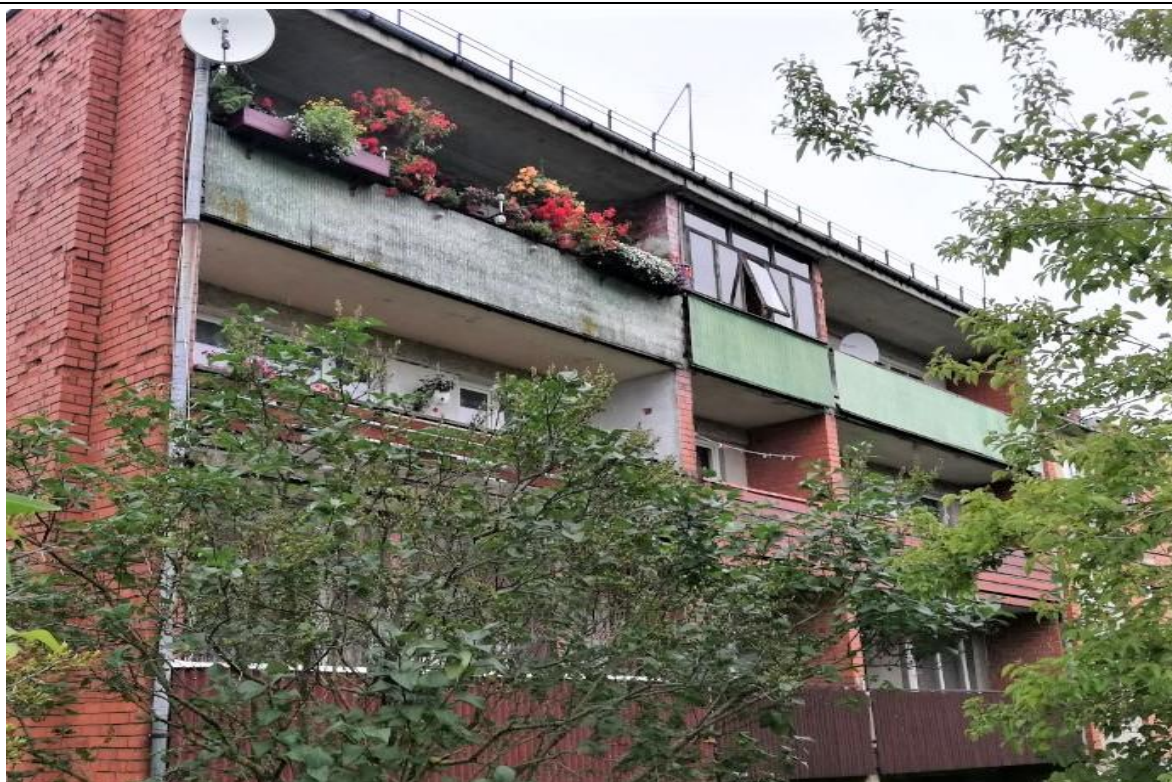
4.9.1.att. Ēkas fasādēs ir izbūvētas lodžijas, aizsegtas ar dažādiem materiāliem, kas bojā arhitektonisko izskatu.
