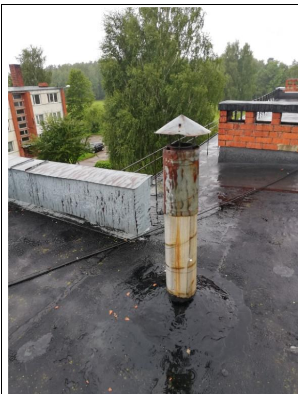
4.8.9.att. Korodējis ventilācijas izvads.
