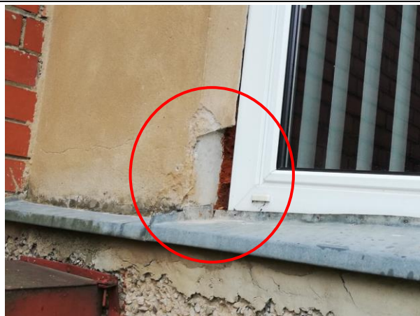
4.5.1. att. Nehermētiska vieta starp paneli un logu.
