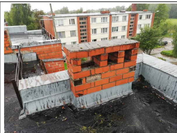
4.8.5.att. Jumta segums pie ventilācijas izvada nolietojies, plaisājis ar iesēdumiem, neapmierinošā tehniskā stāvoklī.
