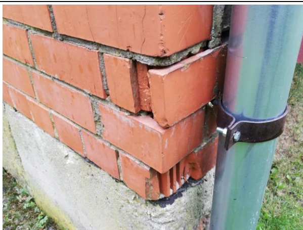
4.2.1.att. Mūra erozija ēkas gala sienā cokola līmenī.
