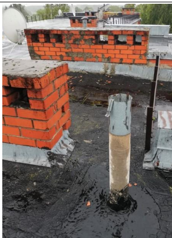
4.16.2.att. Skārda ventilācijas izvads bez nosegelementa.
