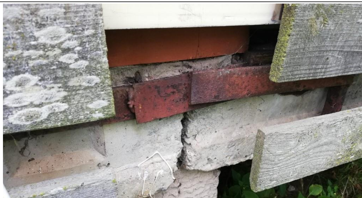
4.9.5.att. Korodējuši lodžiju margu metāla stiprinājumi.
