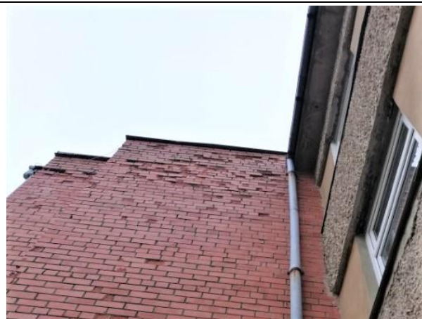
4.2.4.att. Nokrišņu ietekmē bojāts, erodējis mūris.
