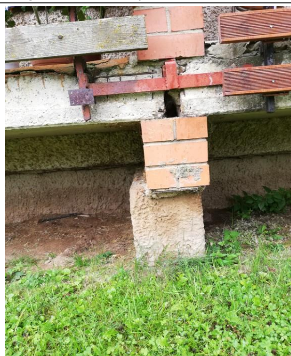
4.9.7.att. Neaizpildīta sprauga starp lodžiju pārsegumu plātnēm. Neprecīzu lodžiju pārsegumu plātņu montāža.
