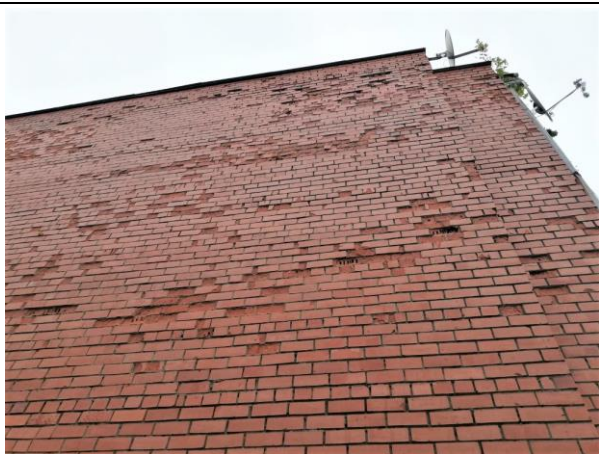
4.2.3.att. Ēkas nesošā ķieģeļu mūra gala siena 510 mm biezumā. Mūra erozija.
