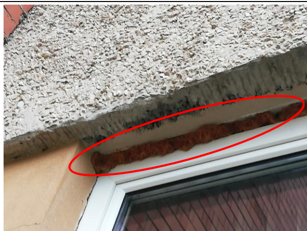
4.5.3. att. Logam nav veikta pieslēgumu aizdare, nehermētisks pieslēgums.
