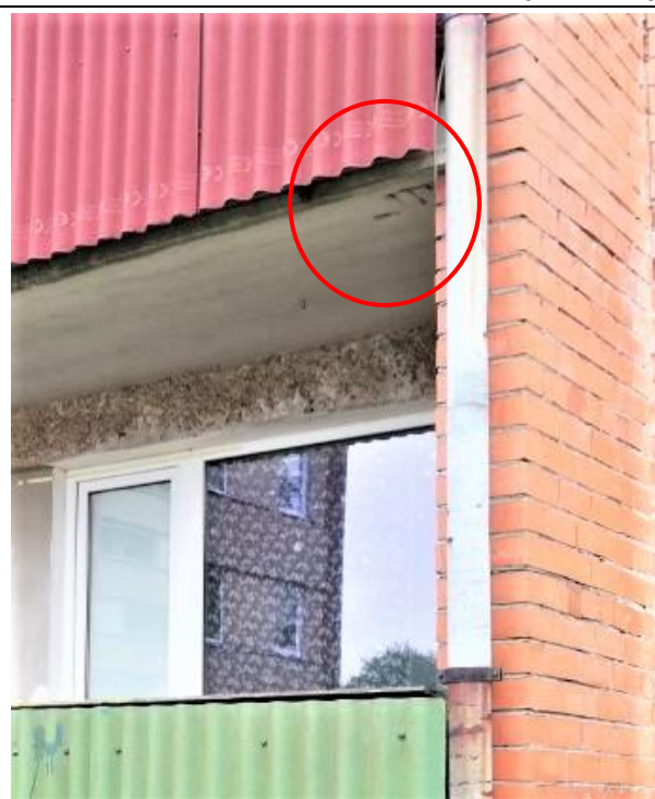
4.9.6.att. Lodžiju pārsegumu plātņu neaizsargāts stiegrojums.
