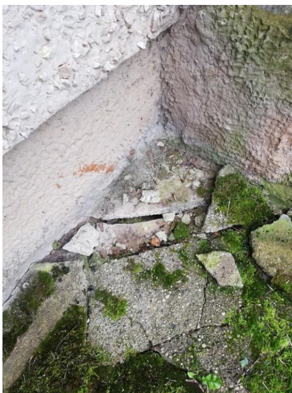
4.1.7.att. Ēkas aizsargapmale sabrukusi.
