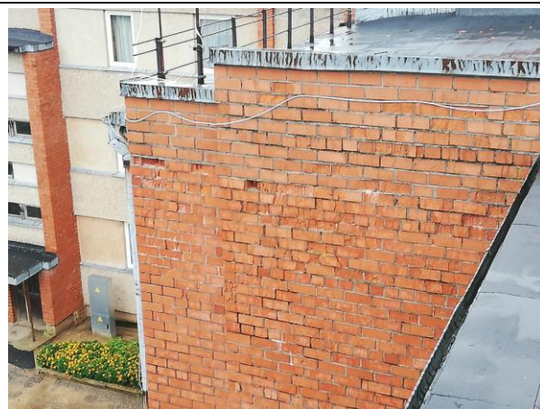
4.2.2.att. Nesošās šķērssienu mūra erozija.
