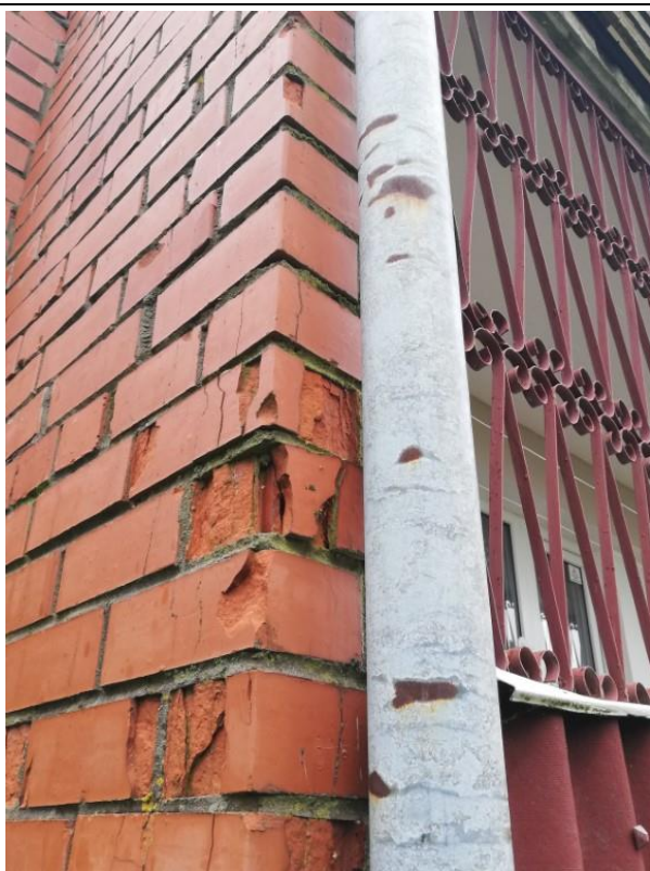
4.2.9.att. Nokrišņu ietekmē bojāts, erodējis mūris.
