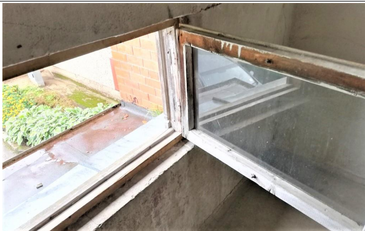
4.13.8.att. Kāpņu telpās nolietotojušies logi koka rāmjos.
