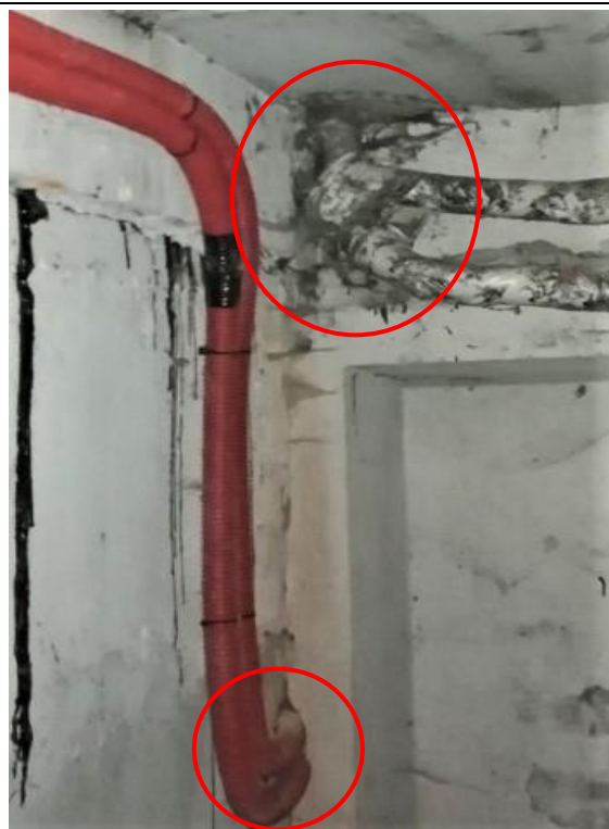
4.15.2.att. Cauruļvadu šķērsojums ugunsdrošajā konstrukcijā, nav veikta ugunsdrošā aizdare.
