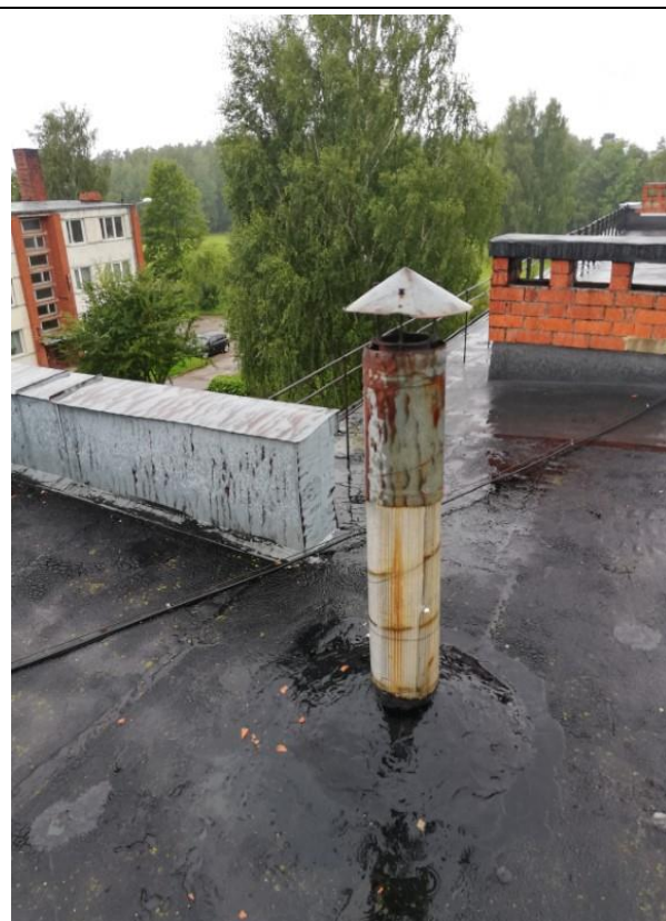
4.16.3.att. Skārda ventilācijas izvads korodējis.
