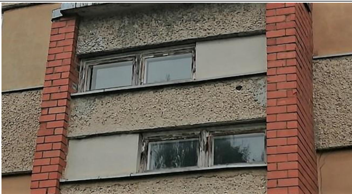
4.13.2.att. Kāpņu telpā logi daļēji aizstāti ar sienu paneļiem.
