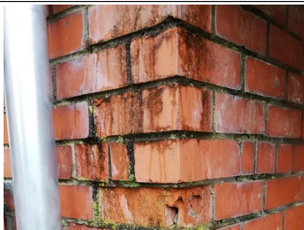
4.2.8.att. Nokrišņu ietekmē bojāts, erodējis mūris.
