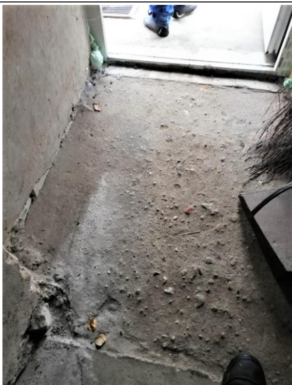
4.10.4.att. Pagraba kāpņu laukumam izdrupis betona segums.
