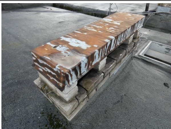
4.16.3.att. Ventilācijas šahtu izvadi virs jumta līmeņa. Skārda nasegelementu korozija.
