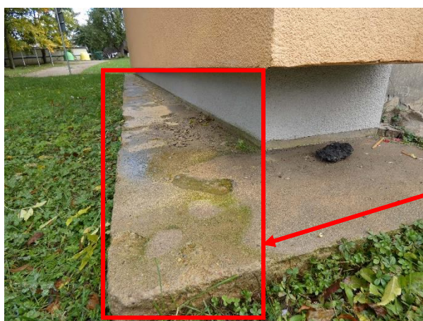
4.1.1.att. Bojāta ēkas aizsargapmale.
