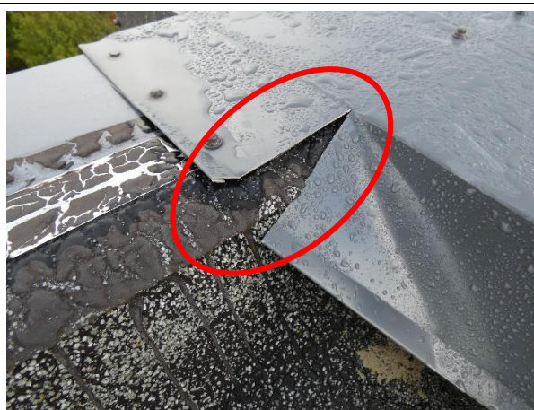
4.8.14.att. Parapeta skārda elementi - nehermētiskas savienojumu vietas.
