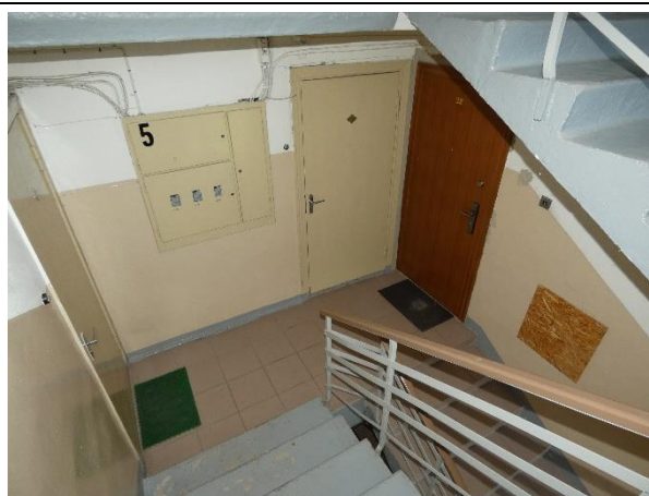
4.13.8. att. Dzīvokļu ārdurvis no metāla, koka.
