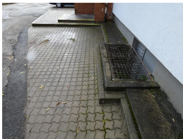
4.1.4.att. Aizsargapmale, daļēji apmierinošā stāvoklī.
