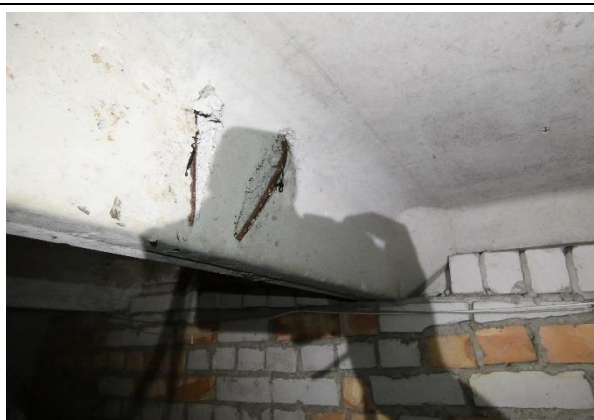
4.8.8.att. Jumta pārseguma plātņu balsta vietas bez slodzi pārdalošas dzelzsbetona joslas, ražošanas defekts – atsegts stiegrojums
