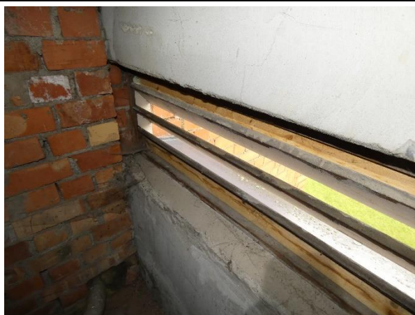
4.13.14. att. Bēniņos ailu aizpildījums ar žalūzijām – apmierinošā stāvoklī.
