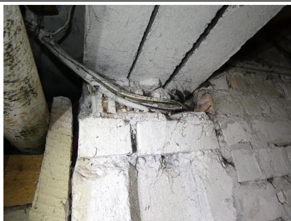
4.2.16.att. Bojāta/neatbilstoši izpildīta ailas pārsedzes balstvieta.
