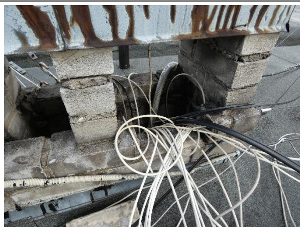
4.16.6. Vēdināšanas šahtas tiek izmantotas inženierkomunikāciju kabeļiem. Nav sakārtoti vadu stiprinājumi.
