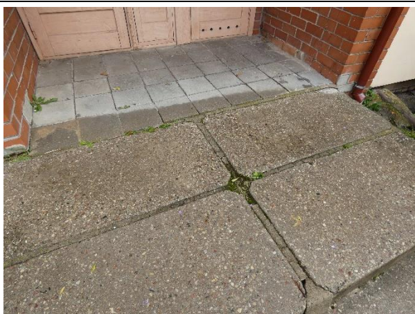
4.9.7.att. Ieejas lieveņi no betona plātnēm – daļēji apmierinošā stāvoklī.
