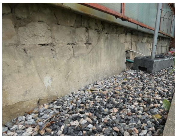
4.1.3.att. Cokola daļā vertikālā hidroizolācija netika novērota. Bojāts apmetums - no mitruma neaizsargāts ķieģeļu mūris.
