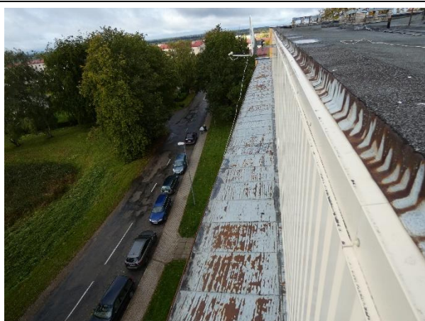
4.8.15.att. Skārda elementi ar koroziju.
