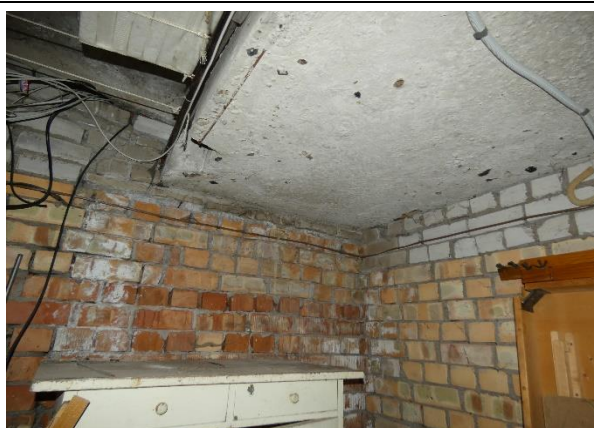
4.8.4.att. Atsegts un korodējis jumta paneļu stiegrojums. Ražošanas defekts.
