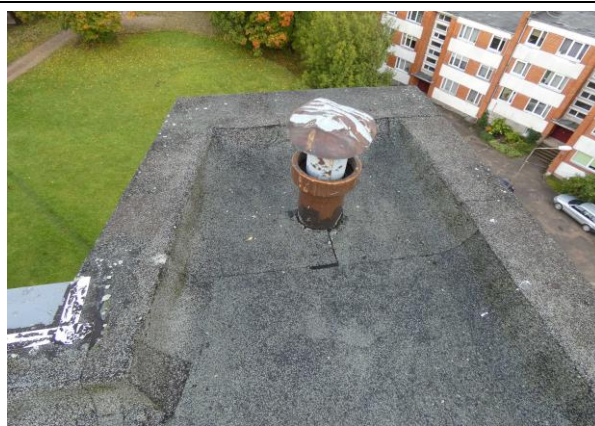
4.16.2.att. Atkritumu vada ventilācijas izvads virs jumta ar korozijas bojājumiem
