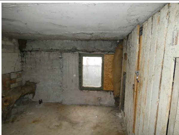
4.13.9. att. Pagraba logs , daļēji aizdarīts ar osb lokšņu materiālu. Trūkst 1 stiklojuma kārtā.
