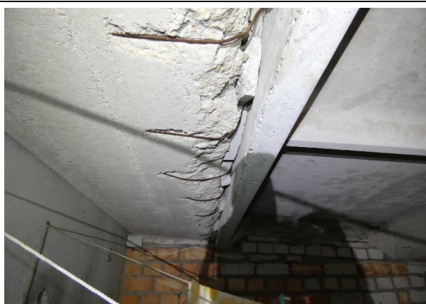
4.8.3.att. Atsegts un korodējis jumta plātnes stiegrojums. Iespējams bojājums montāžas laikā.
