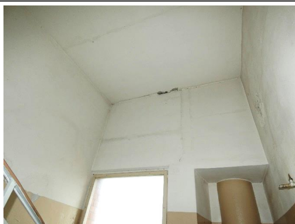
4.8.28. Att. Pārsegums virs kāpņu telpām vietām ar lokāliem saduršuvju izdrupumiem un mitruma pazīmēm
