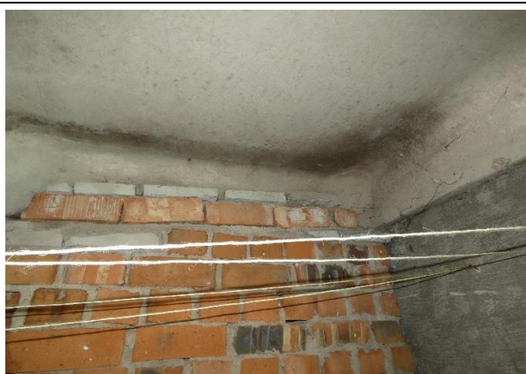
4.8.6.att. Mitruma pazīmes uz jumta plātnēm, balsta vietas uz mūra, bez slodzi pārdalošas dzelzsbetona joslas.
