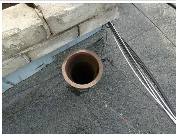
4.8.20.att. Zuduši skārda nosegelementi izvadiem jumtā.
