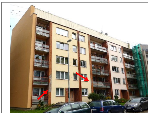
4.2.1.att. Bojāts nesošo šķērssienu fasādes daļas mūris.
