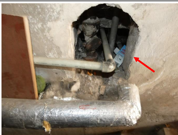
4.15.1.att. Cauruļvadu šķērsojums ugunsdrošajā konstrukcijā, nav veikta ugunsdrošā aizdare.
