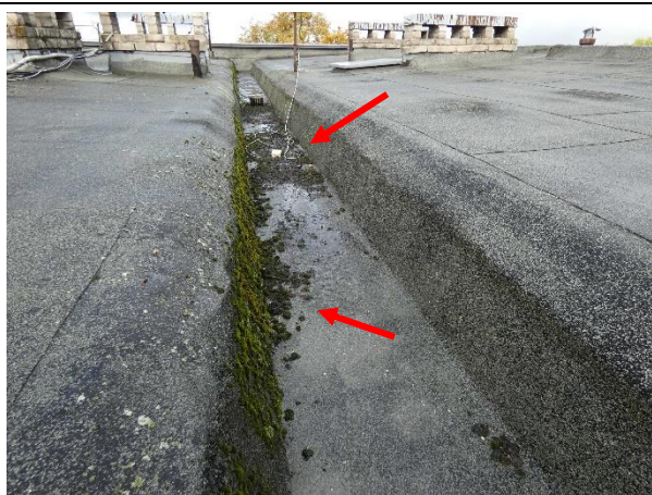
4.8.17.att. Gruži jumta tekņē. Jumta segums ar apaugumiem.
