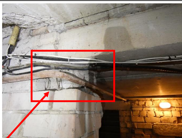
4.2.14.att. Bojāta/neatbilstoši izpildīta ailas pārsedzes balstvieta.
