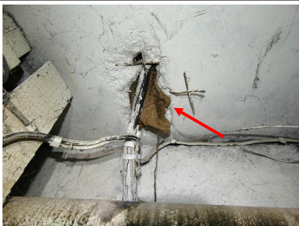
4.6.3. Att. Neatbilstoši hermetizēta inženiertīklu šķērsojumu vieta.
