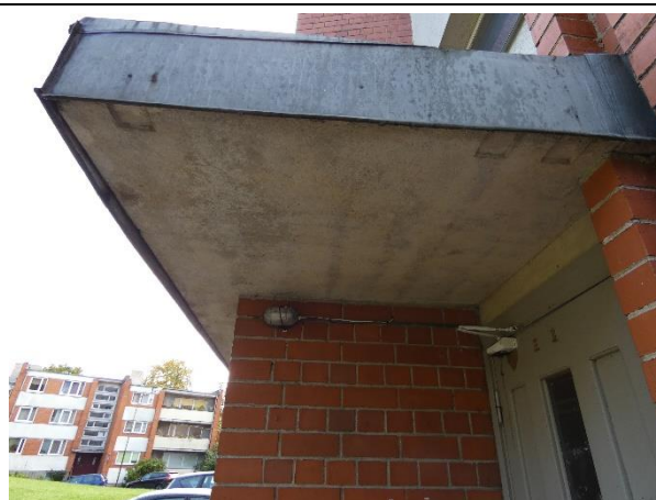
4.9.2.att. Jumtiņi virs ieejas mezgliem apmierinošā stāvoklī. Mitruma pazīmes uz jumtiņa pārseguma plātnes.
