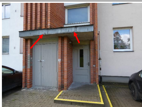
4.9.10.att. Jumtiņu skārda elementi ar koroziju.
