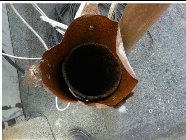
4.8.21.att. Zuduši skārda nosegelementi izvadiem jumtā.
