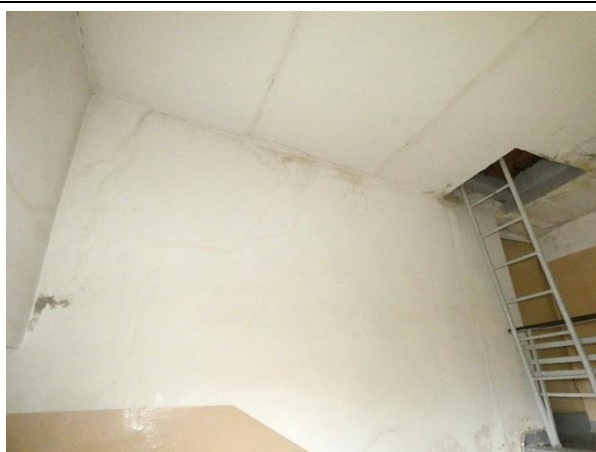
4.8.27. Att. Pārsegums virs kāpņu telpām vietām ar lokāliem saduršuvju izdrupumiem un mitruma pazīmēm
