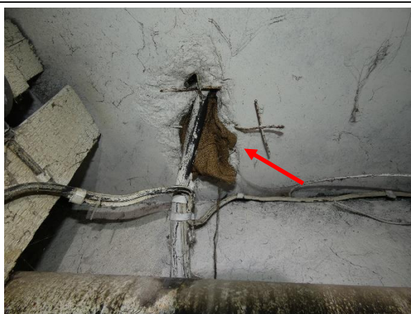
4.15.2.att. Kabeļu šķērsojums ugunsdrošajā konstrukcijā, nav veikta ugunsdrošā aizdare.
