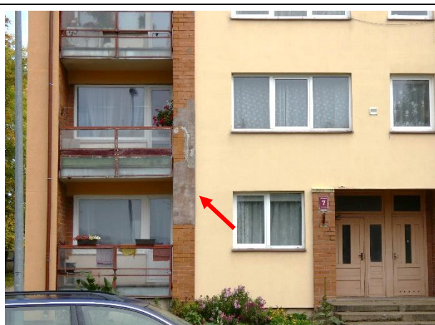
4.2.2.att. Konstatēti ievērojami ķieģeļu izdrupumi un lokālas remonta zonas.
