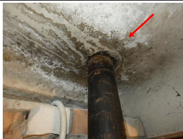
4.8.2.att. Konstatēta mitruma infiltrācija pie izvadiem jumtā.
