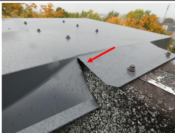
4.8.23.att. Parapeta skārda elementi - nehermētiskas savienojumu vietas.
