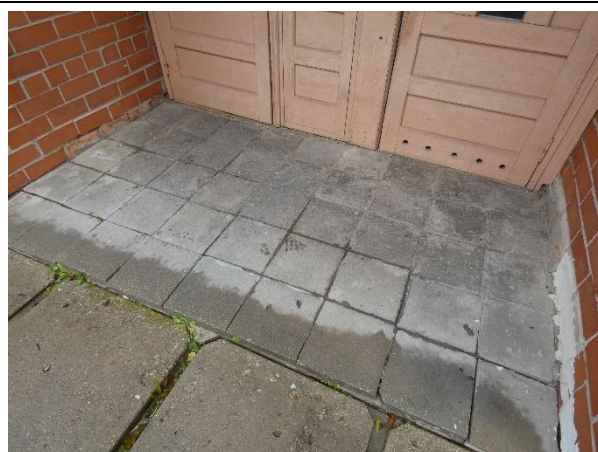
4.9.6.att. Ieejas lieveņi no betona plātnēm – daļēji apmierinošā stāvoklī.
