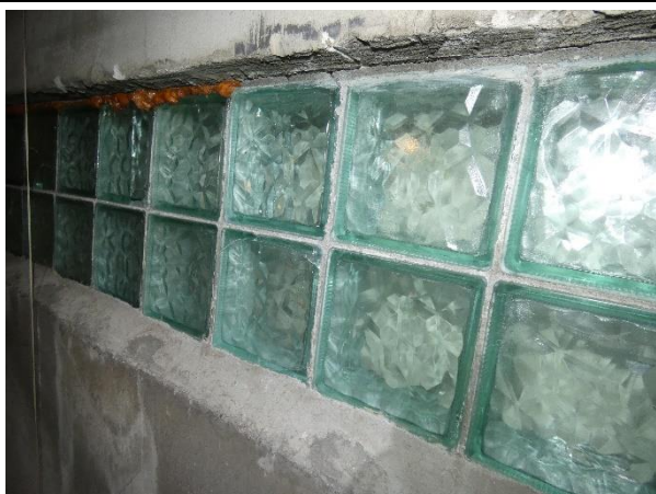
4.13.13. att. Bēniņos stikla bloku ailu aizpildījums daļēji apmierinošā stāvoklī.
