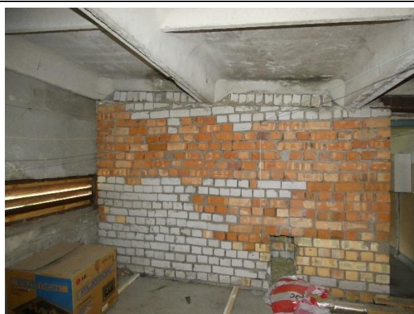
4.8.10.att. Mitruma pazīmes uz jumta plātnēm, balsta vietas bez slodzi pārdalošas dzelzsbetona joslas, apmierinošā stāvoklī
