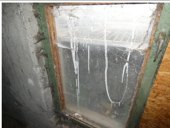
4.13.10. att. Pagraba logs , daļēji aizdarīts ar osb lokšņu materiālu. Trūkst 1 stiklojuma kārtā.
