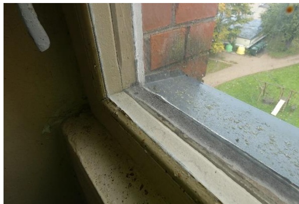
4.13.4. att. Kāpņu telpās koka logi ar stiklojumu divās kārtās – apmierinošā stāvoklī.
