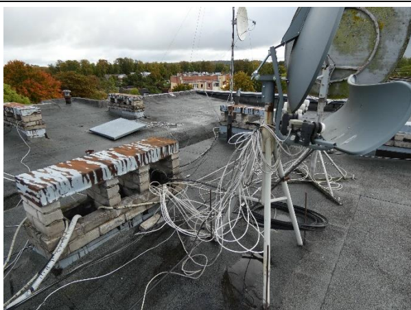
4.16.5. Ventilācijas šahtu izvadi virs jumta līmeņa. Korodējuši skārda nasegelementi.
