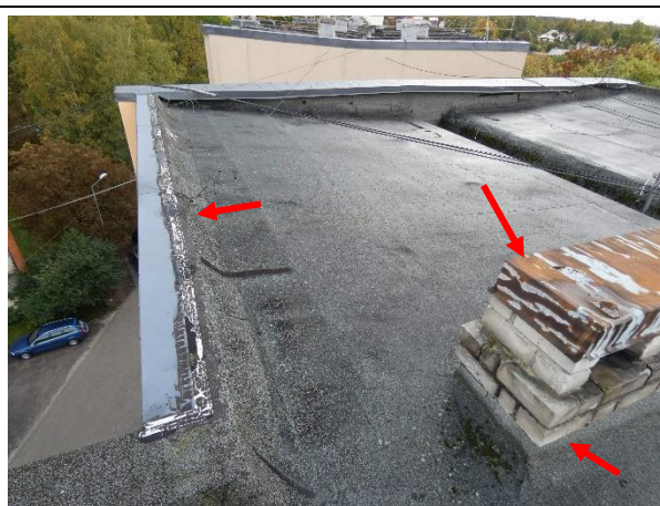
4.8.12.att. Izvadiem jumtā skārda elementi ar koroziju. iespējami nehermētiskas pieslēgumu vietas.
