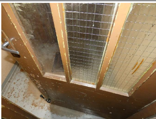
4.13.7. att. Ieejas mezgla iekšdurvis no koka ar armēto stiklu – apmierinošā stāvoklī.
