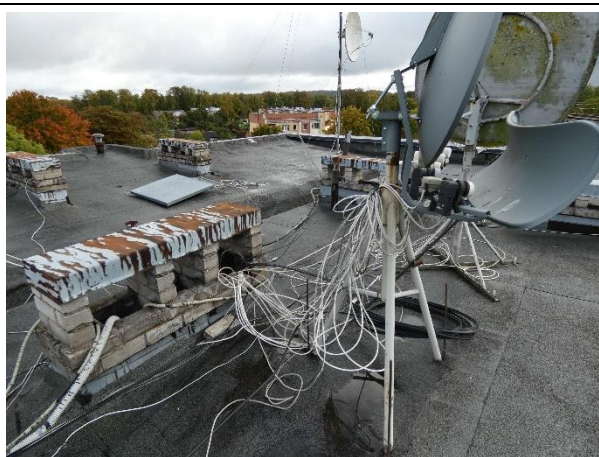
4.8.13.att. Nesakārtoti kabeļu uz jumta. Izvadiem jumtā skārda elementi ar koroziju.
