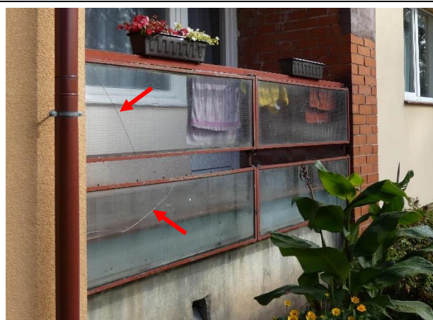
4.9.12.att. Lodžiju norobežojuma stiklam konstatēti bojājumi. Nedrošums.
