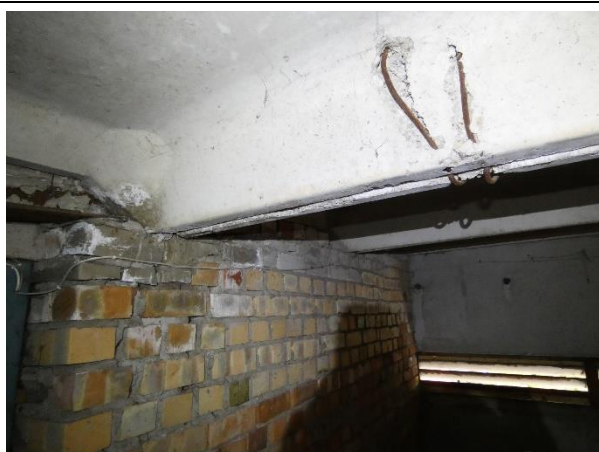
4.8.9.att. Atsegts un korodējis jumta paneļu stiegrojums. Ražošanas defekts.
