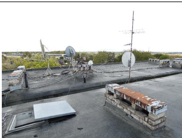
4.8.11.att. Bitumena jumta segums – daļēji apmierinošā stāvoklī.
