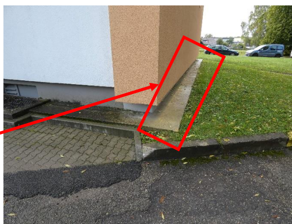
4.1.2.att. Bojāta ēkas aizsargapmale. Daļēji atjaunota un jau bojāta aizsargapmale.
