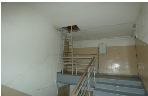
4.13.15. att. Konstatētas mitruma pazīmes, gar jumta lūku.
