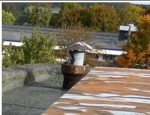
4.16.4.att. Atkritumu vada ventilācijas izvads virs jumta ar korozijas bojājumiem
