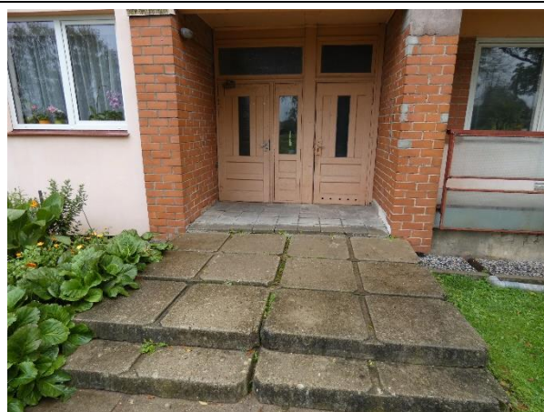
4.9.8.att. Ieejas lieveņi no betona plātnēm – daļēji apmierinošā stāvoklī.
