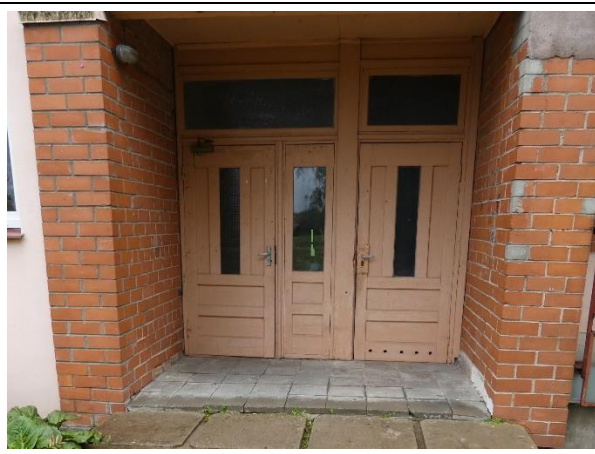
4.13.6. att. Ieejas mezgla ārdurvis no koka, ar stikla pildījumu – apmierinošā stāvoklī.
