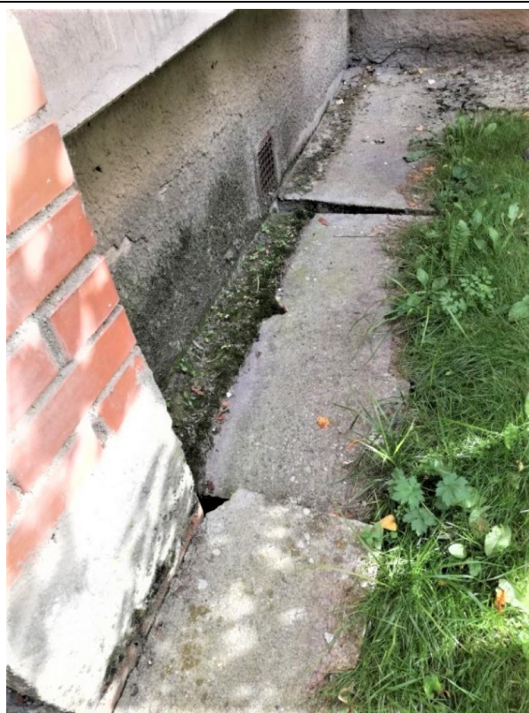
4.1.10.att. Ēkas aizsargapmales plātnes deformācija.
