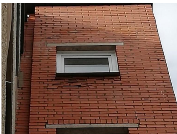
4.2.6.att. Šķērsgriezumā sienā ķieģeļu mūra izdrupumi.
