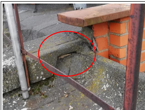
4.8.2.5.att. Bojājums jumta segumā.
