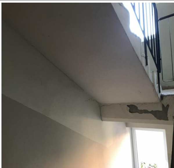
4.10.5.3.att. Krāsojuma atdalīšanās no kāpņu laukuma vertikālās plaknes
