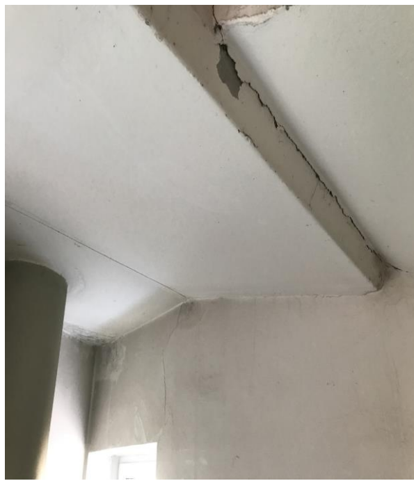
4.10.5.2.att. Saduršuvē krāsojuma atdalīšanās
