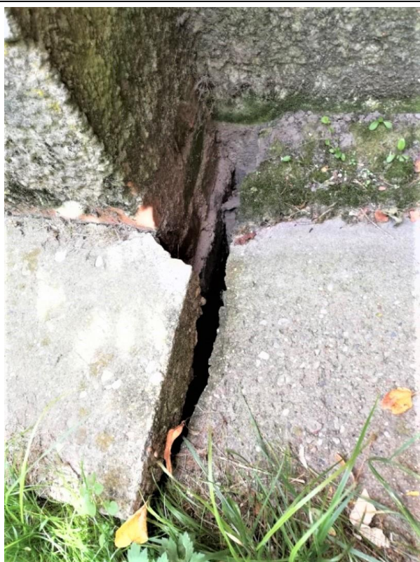
4.1.9.att. Deformācijas spraugas starp aizsargapmales dzelzsbetona plātnēm.
