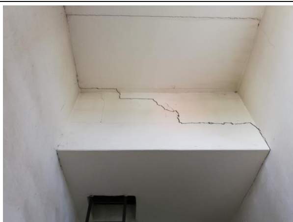
4.2.11.att. Plaisa 4. sekcijas kāpņu telpas un bēniņu telpas mūra sienā.
