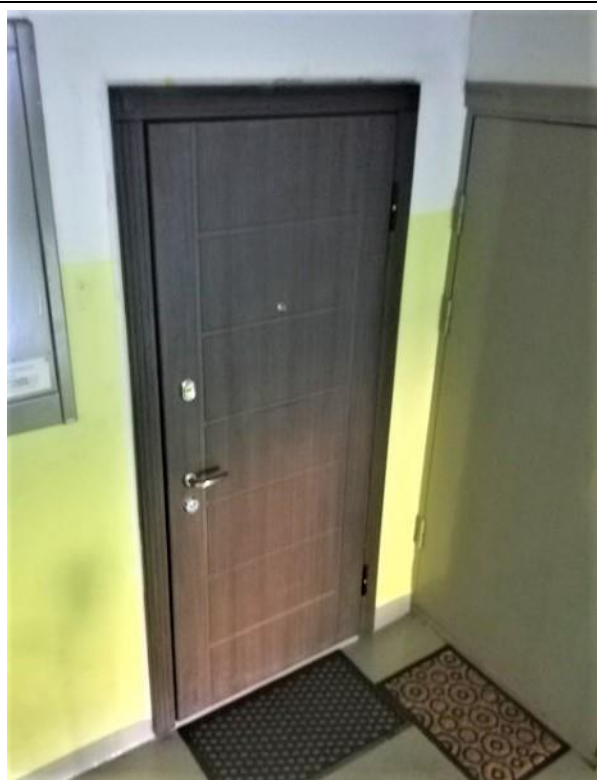
4.12.4.att. Dzīvokļa durvis labā stāvoklī.
