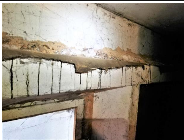
4.4.8.att. Nebūtiski mitruma radīti bojājumi cokola paneliņiem.
