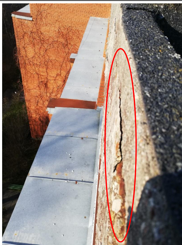
4.4.6.att. Sekcijas augšējā stāvā vērojama betona aizsargkārtas atdalīšanās un atsegts stiebrojums paneļa virsmā.
