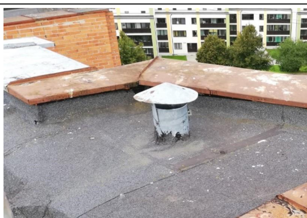
4.14.2.att. Metāla ventilācijas kanālu izvadi uz jumta.
