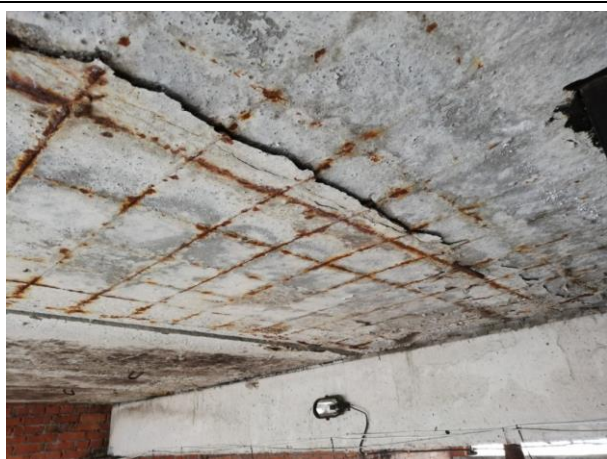
4.8.8.att. Jumta klāja ribotām dzelzsbetona plātnēm atslāņojies betons un korodējis stiegrējums
