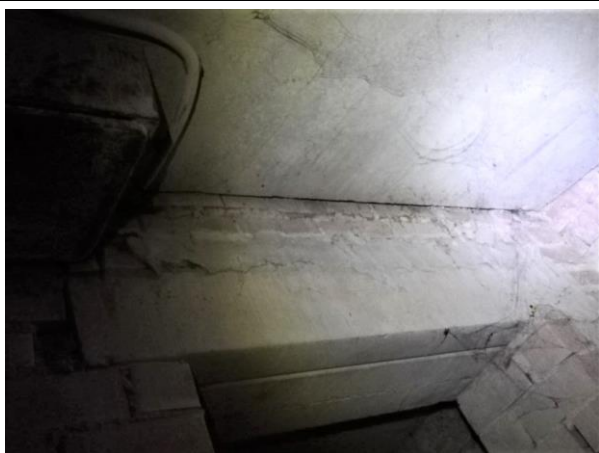
4.2.14.att. Dzelzsbetona pārsedze pagrabā.
