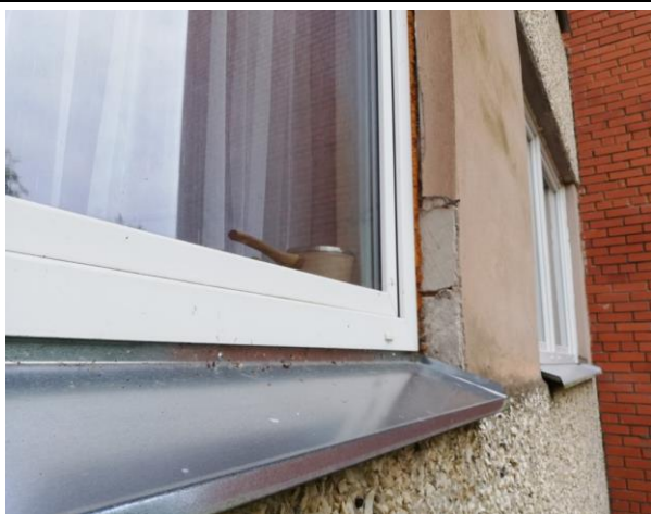
4.12.5.att. Logam nav veikta pieslēgumu aizdare, nehermētisks pieslēgums.
