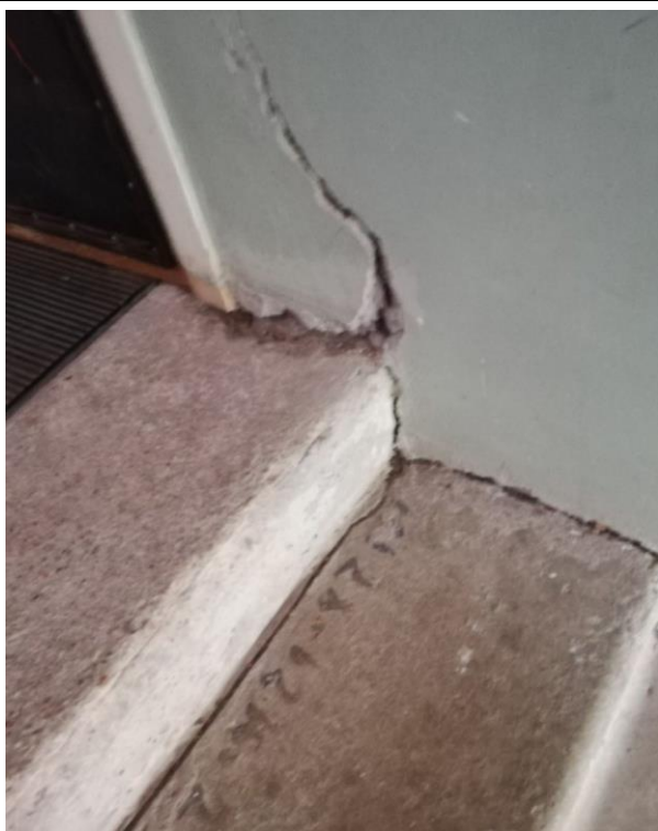
4.2.12.att. Plaisa 1.kāpņu telpas mūra sienā.
