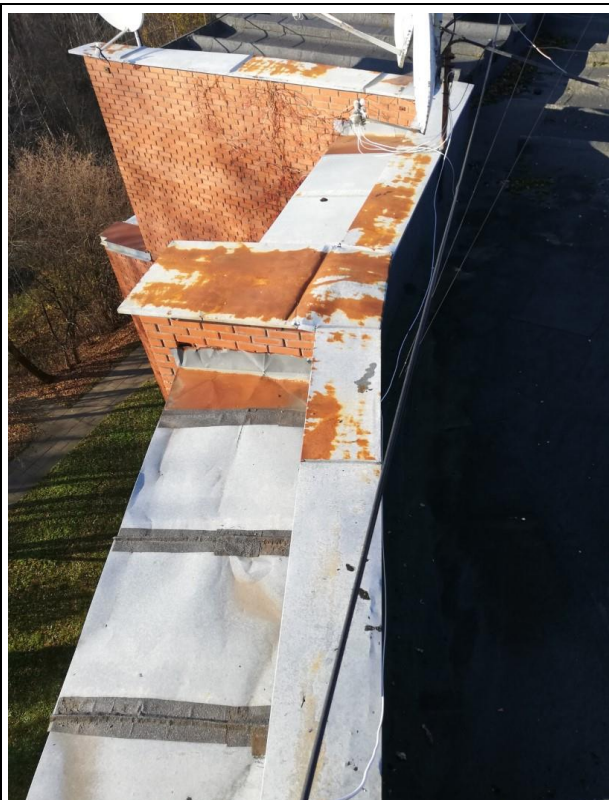
4.8.2.9.att. Korodējušas parapetu skārda nosegdetaļas.
