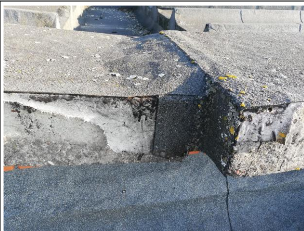
4.8.2.6.att. Atklāta seguma stikla šķiedras auduma hidroizolācija. Nav uzklāta bitumena mastika.
