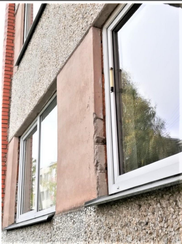
4.4.5.att. Atdalīties apmetums no starplogu ailes aizpildījuma gāzbetona bloku aizmūrējuma.
