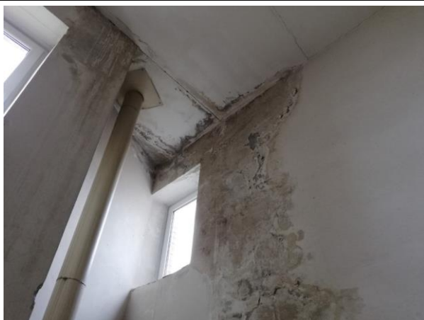
4.2.8.att. Plaisa 4. sekcijas kāpņu telpas mūra sienā.
