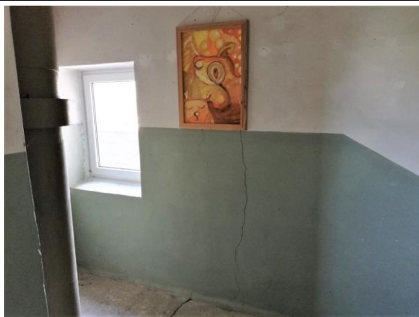
4.2.9.att. Plaisa 4. sekcijas kāpņu telpas mūra sienā.
