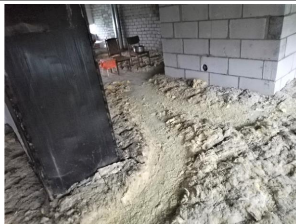
4.5.3. att. Uz pārseguma vietām trūkst siltumizolācijas, tā ir nomīdīta.
