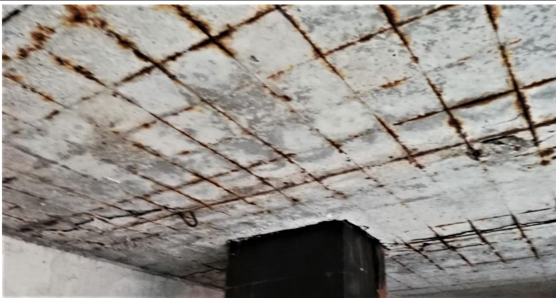
4.8.10.att. Jumta klāja ribotām dzelzsbetona plātnēm nepietiekams stiebrojuma aizsargslānis un korodējis stiebrojums.
