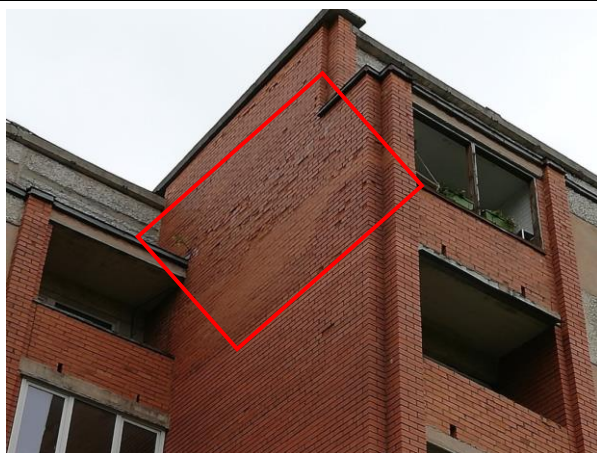
4.2.7.att. Šķērsgriezumā mūra sienā izdrupumi.
