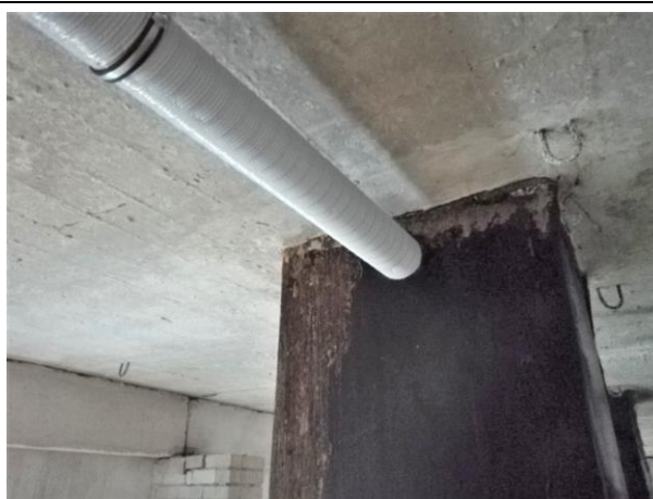
4.14.3.att. Ventilācijas ievads ventilācijas šaftā ēkas bēniņu stāvā.
