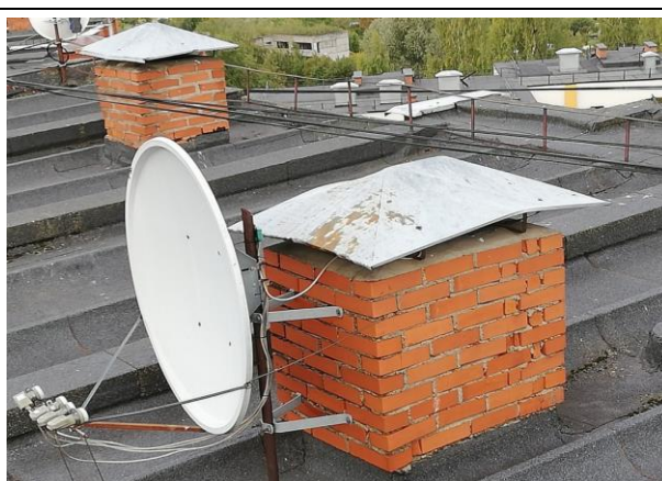
4.14.1.att. Ventilācijas šahtu izvadi uz jumta.
