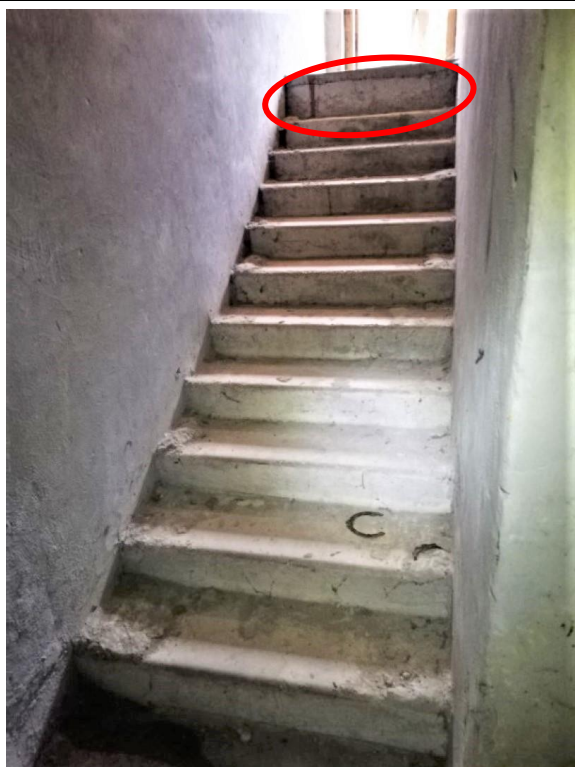
4.10.5.att. Dzelzsbetona gatavelementu kāpnes uz pagrabu. Pakāpiena augstums neatbilstošs.
