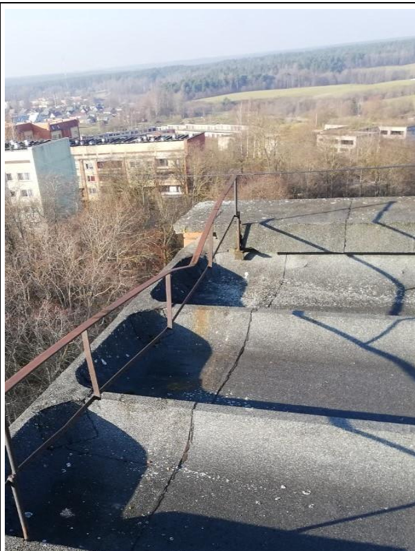
4.8.2.10.att. Metāla margas vietām ir korodējušas un deformētas.
