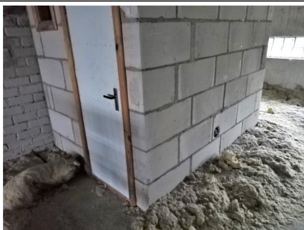
4.14.4.att. Izbūvēts nodalījums ventilācijas iekārtai ēkas bēniņu stāvā (iespējams, ka nelikumīgi).
