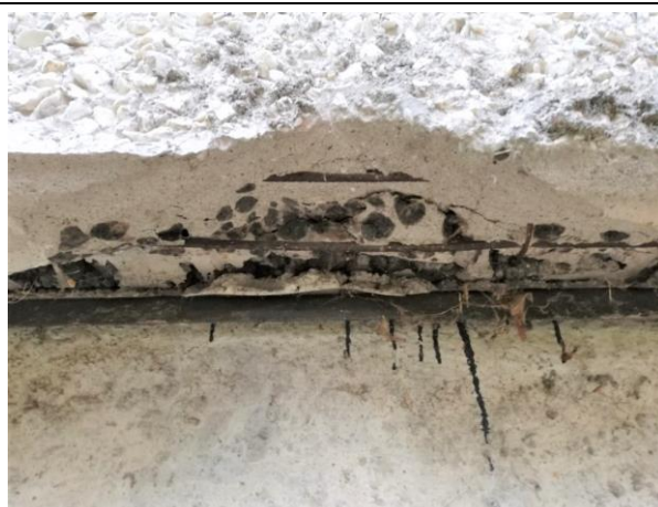
4.4.4.att. Lokāli izdrupumi un atkailināts stiegrojums pašnesošajos ārsienu paneļos.
