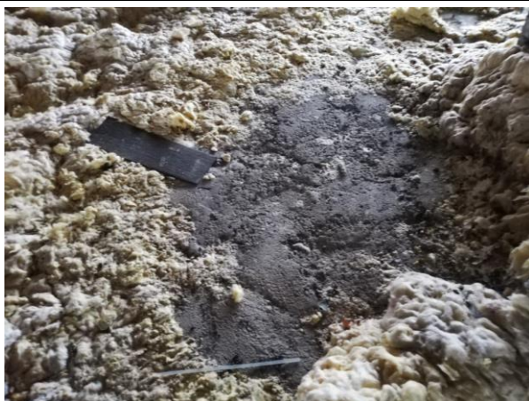
4.5.2. att. Ēkas bēniņu pārsegumiem ir ierīkota beramā keramzīta siltumizolācija, virs tā akmensvates siltumizolācija, kura neveic savu funkciju.
