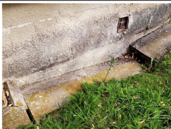
4.1.8.att. Ēkas aizsargapmales plātnes deformācija izskalotas grunts sēšanās rezultātā.
