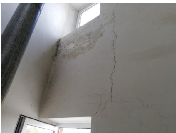
4.2.10.att. Plaisa 2. sekcijas kāpņu telpas mūra sienā.
