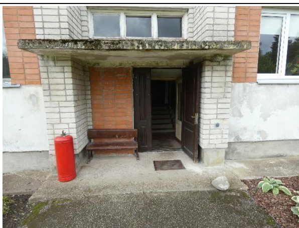
4.9.5.att. Ieejas lievenis apmierinošā stāvoklī ar maznozīmīgiem betona izdrupumiem.
