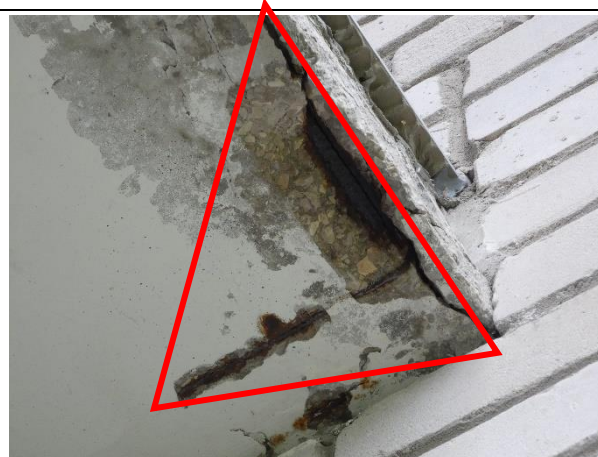
4.9.8.att. Bojāta lodžijas pārseguma plātnē – plaisas, izdrupumi, atsegts korodēts stiebrojums
