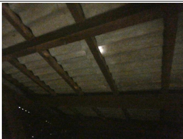
4.8.9.att. Konstatēti jumta seguma bojājumi. Ēkas konstrukcijas nav pasargātas no mitruma.
