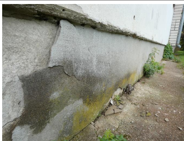
4.1.4.att. Cokola daļā vertikālā hidroizolācija netika noteikta. Konstatēti apmetuma izdrupumi.
