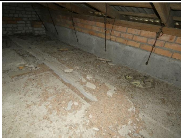
4.8.8.att. Jumta konstrukcija enkurota sienās ar tērauda stieplēm. Stieples ar koroziju.
