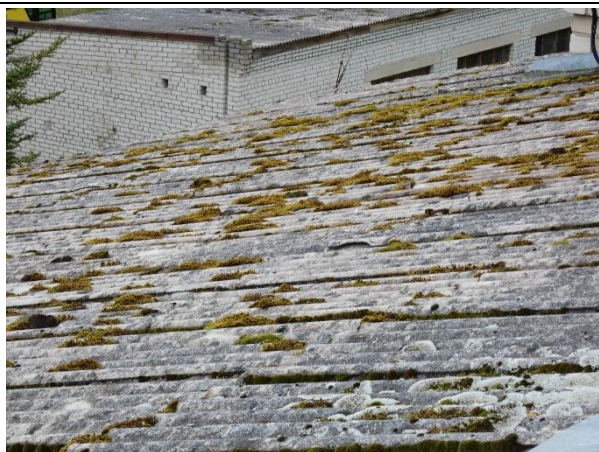
4.8.19.att. Jumta segums ar apaugumiem.
