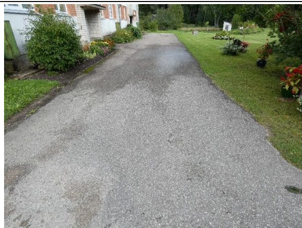
3.1.2.att. Brauktuves un ietves – daļēji apmierinošā stāvoklī.
