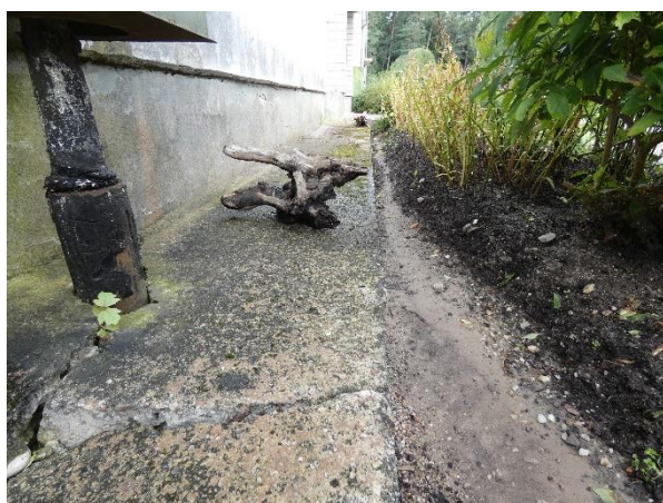
4.1.1.att. Bojāta ēkas aizsargapmale.
