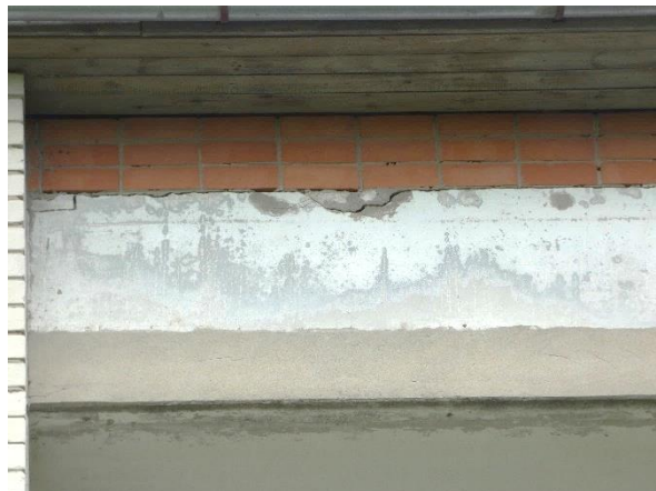
4.4.2.att. Pašnesošie sienu paneļi ar bojājumiem - izdrupumiem
