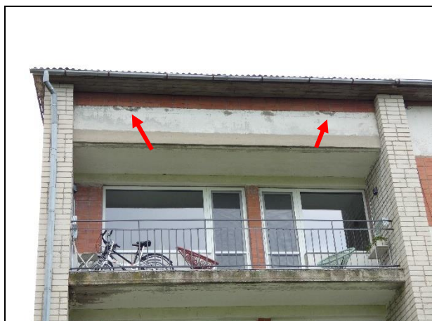
4.5.1. att. Sadurvietas izdrupumi.
