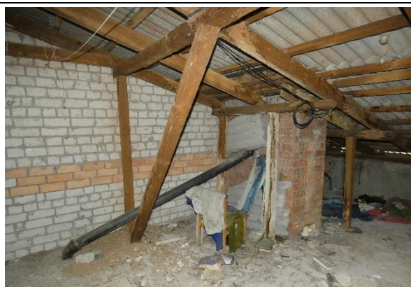
4.8.2.att. Jumta nesošie elementi ar mitruma pazīmēm.
