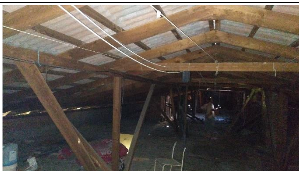
4.8.3.att. Jumta nesošie elementi ar mitruma pazīmēm.
