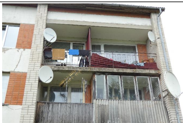
4.2.1.att. No nokrišņiem neaizsargāts nesošo šķērssienu fasādes daļas mūris.
