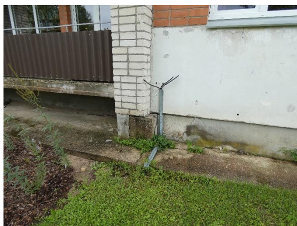
4.1.2.att. Bojāta ēkas aizsargapmale.
