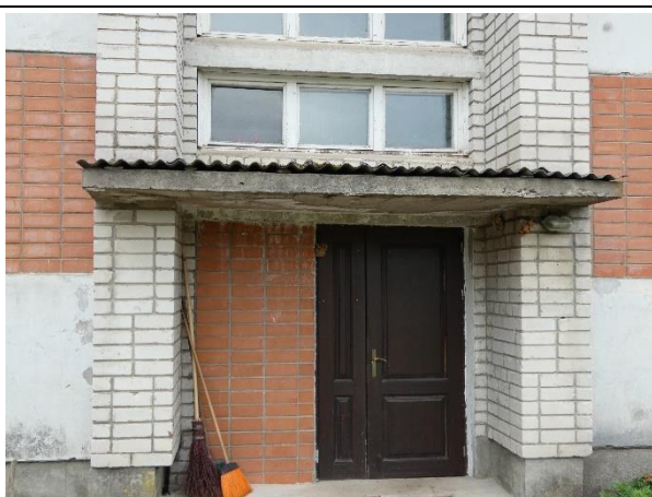
4.9.1.att. Jumtiņš virs ieejas mezglim daļēji apmierinošā stāvoklī. Azbestcements lokšņu segums.
