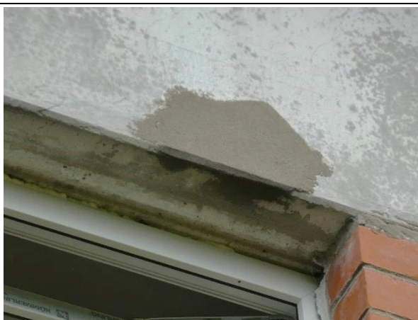
4.4.4.att. Plaisas un izdrupumi pašnesošajos sienu paneļos, apdares bojājumi.
