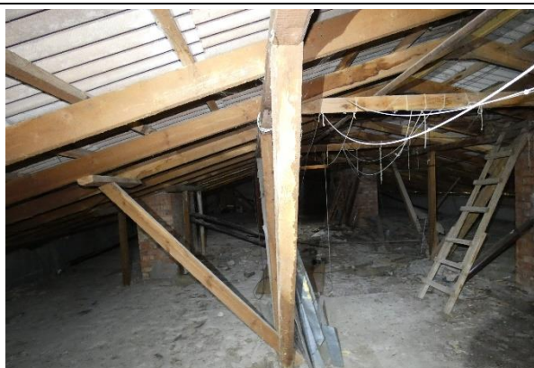
4.8.1.att. Jumta nesošie elementi ar mitruma pazīmēm.
