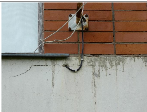
4.4.3.att. Plaisas un izdrupumi pašnesošajos ārsienu paneļos, apdares bojājumi.
