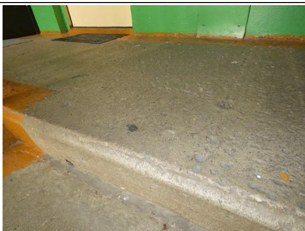
4.10.3.att. Kāpņu laukums ar lokāliem betona izdrupumiem.
