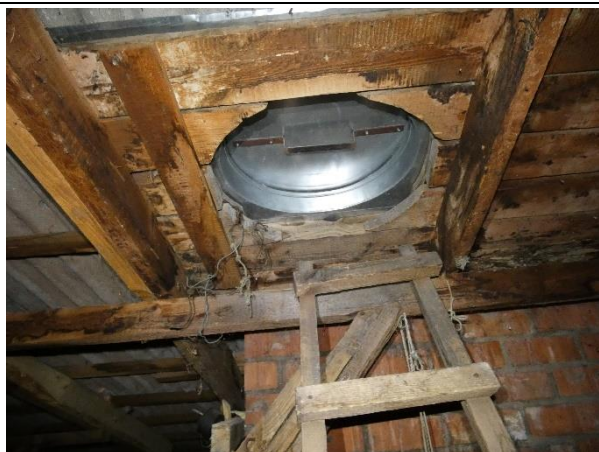
4.8.13.att. Lūka jumtā – koka konstrukcijās ar mitruma pazīmēm.
