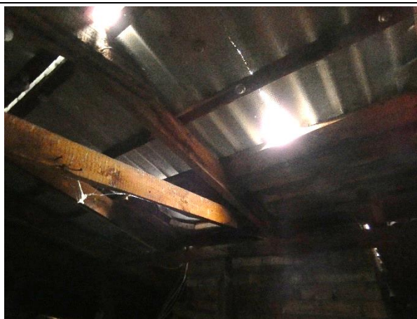
4.8.10.att. Konstatēti jumta seguma bojājumi. Ēkas konstrukcijas nav pasargātas no mitruma.
