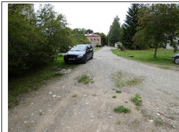
3.1.3.att. Brauktuves un ietves – daļēji apmierinošā stāvoklī.
