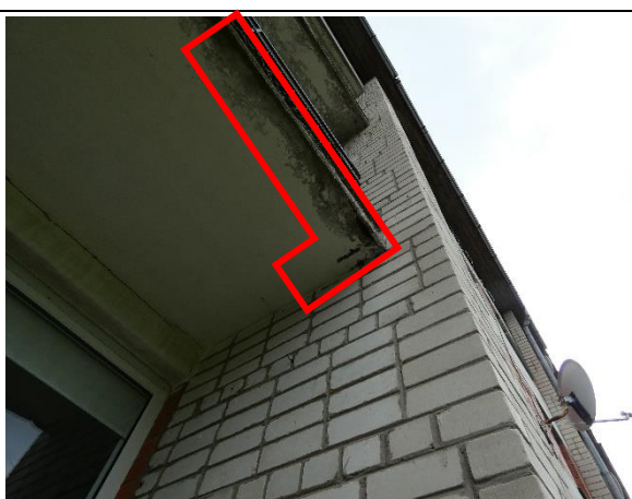
4.9.7.att. Bojāta lodžijas pārseguma plātnē – plaisas, izdrupumi, atsegts korodēts stiebrojums
