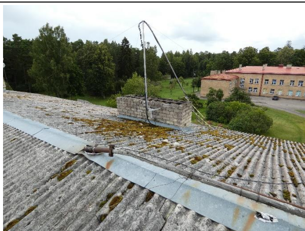
4.8.17.att. Bojātas antenas, nehermētiski skārda elementi, jumta segums ar apaugumiem.
