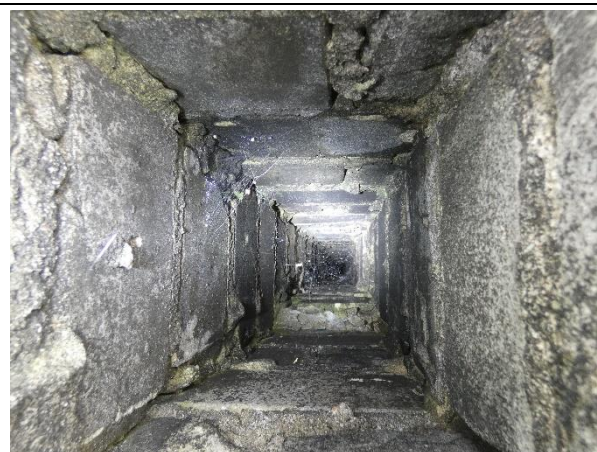
4.16.2.att. Mūrēto ventilācijas šahtu izvadi virs jumta līmeņa. Konstatēti netīrīti ventilācijas kanāli.
