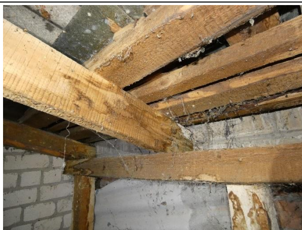
4.8.6.att. Jumta konstrukciju nesošie elementi ar mitruma un bojājumu pazīmēm.
