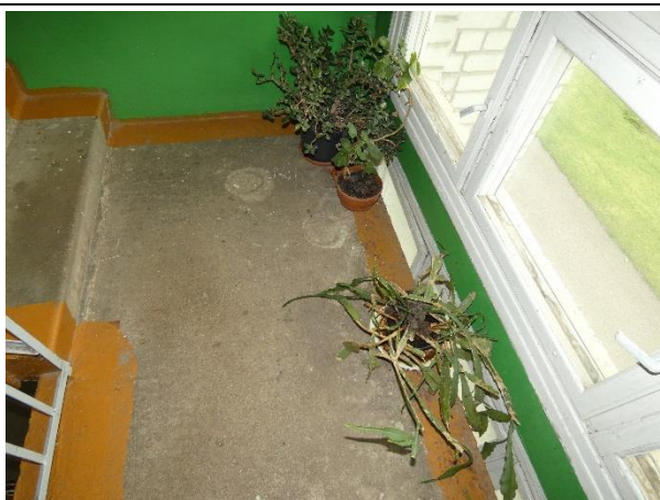
4.10.5.att. Dzelzsbetona laukumi ar lokāliem betona izdrupumiem.
