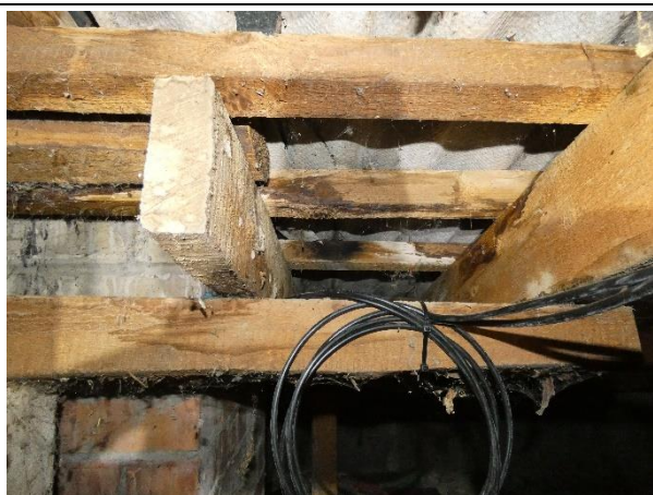
4.8.5.att. Jumta konstrukciju nesošie elementi ar mitruma un bojājumu pazīmēm.
