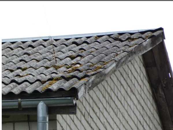
4.8.15.att. Nehermētiski skārda nosegelementi korē, satrupējies vēja dēļis, jumta segums ar apsūnojumu.
