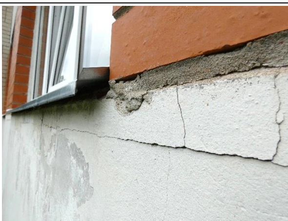
4.4.6.att. Plaisas un izdrupumi pašnesošajos ārsienu paneļos, apdares bojājumi.
