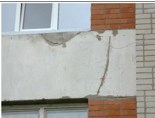
4.4.5.att. Plaisas un izdrupumi pašnesošajos ārsienu paneļos, apdares bojājumi.
