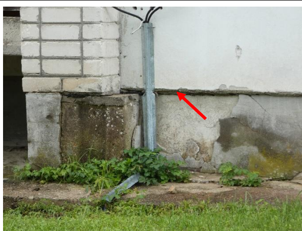
4.1.3.att. Horizontālā hidroizolācija. Cokola daļā vertikālā hidroizolācija nav redzama. Konstatēti apmetuma izdrupumi.
