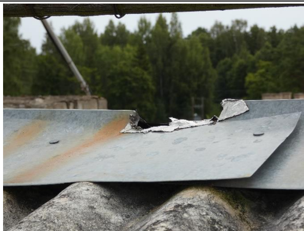
4.8.16.att. Nehermētiski un bojāti skārda elementi kores daļā.
