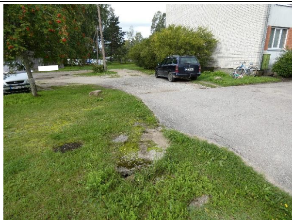
3.1.1. Brauktuves un ietves – daļēji apmierinošā stāvoklī.
