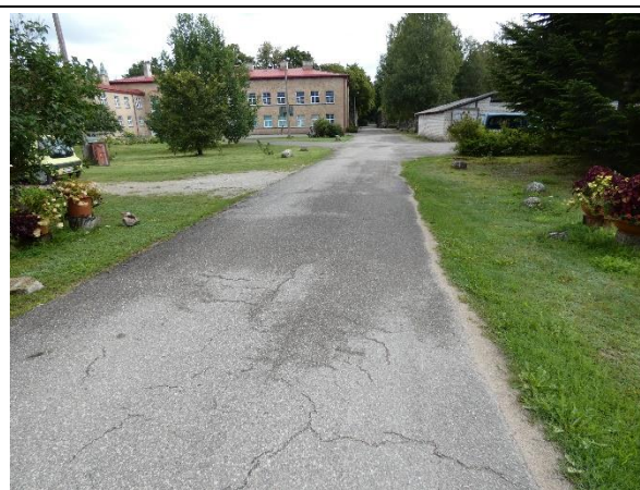
3.1.4.att. Ietves – daļēji apmierinošā stāvoklī.
