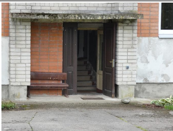
4.13.5. att. Kāpņu telpām koka ārdurvis ar bojātu krāsojumu – daļēji apmierinošā stāvoklī.
