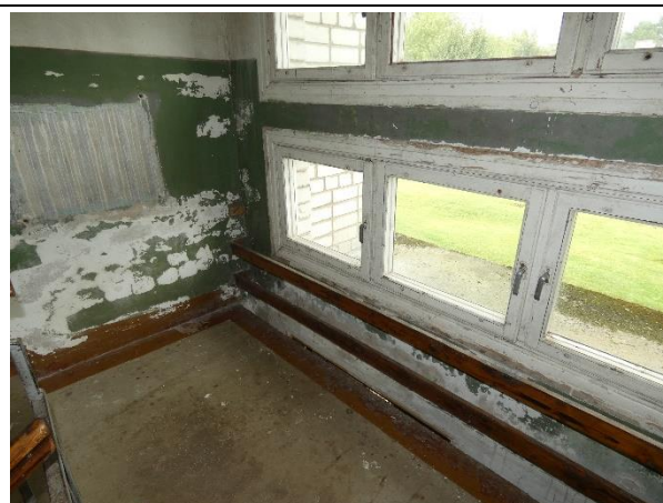
4.13.8. att. Koka logiem konstatēta būtiska aizsargkrāsojuma atslāņošanās.
