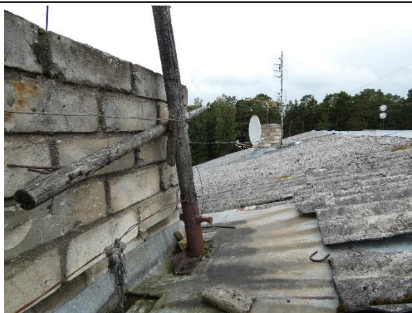
4.8.14.att. Nehermētiski skārda savienojuma elementi. Bojāts jumta segums.
