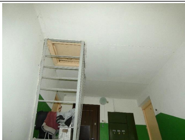
4.6.4. Att. Bēniņu pārsegums virs kāpņu telpas – apmierinošā stāvoklī.
