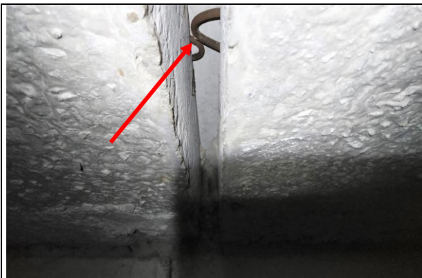
4.8.9.att. Jumta klāja ribotās dzelzsbetona plātņu tērauda cilpas nav savienotas atbilstoši montāžas projektam.
