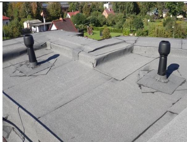
4.14.2.att. VILPE tipa PVC ventilācijas kanālu izvadi uz jumta.
