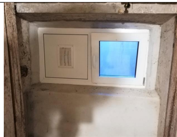
4.12.7.att. Pagraba logi PVC rāmjos ar iebūvētu ventilatoru.
