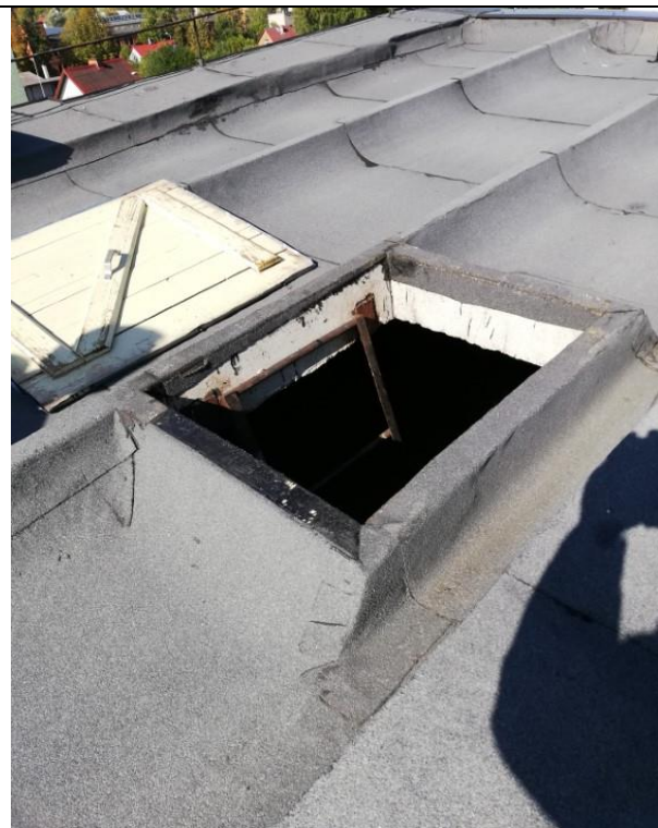
4.12.9.att. Jumta lūka, nav ierīkoti rokturi.
