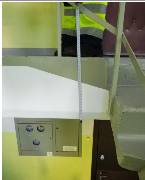
4.10.4.att. Kāpnes starp stāviem izbūvētas no dzelzsbetona gatavelementu laidiem un kāpņu laukumiem 400mm biezumā.
