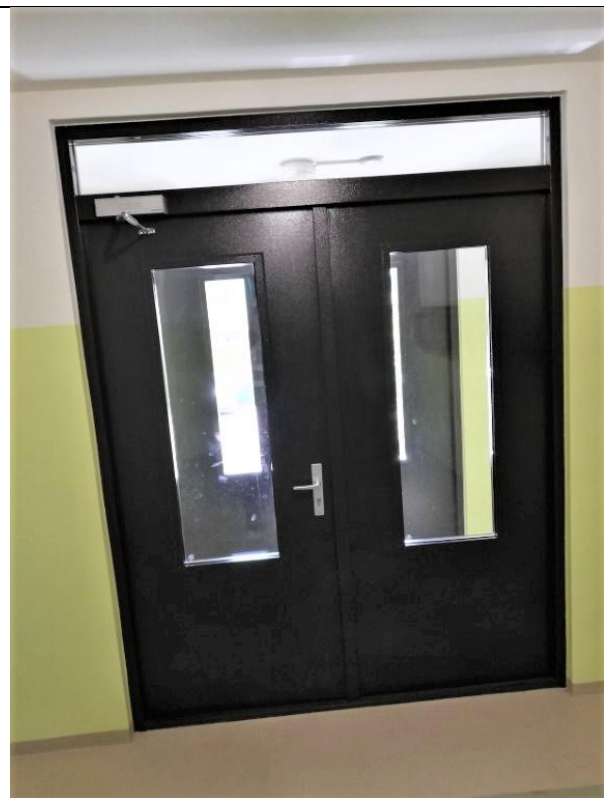
4.12.3.att. Stikla pildīņu iekšdurvis.
