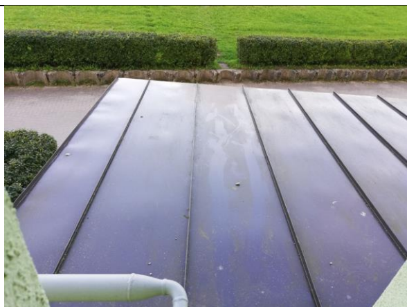
4.9.3.att. Valcētais cinkotā skārda segums labā tehniskā stāvoklī.
