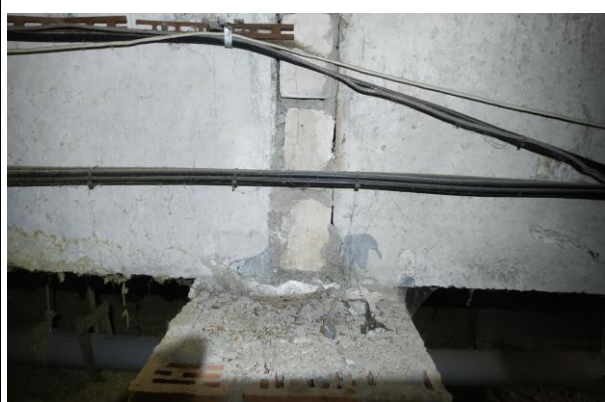
4.8.8.att. Dzelzsbetona teknes sadurvieta uz balsta nekvalitatīvi aizmūrēta.
