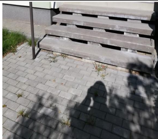
3.1.4.att. Betona bruģakmens segums ietve ēkas dienvidu pusē.
