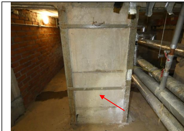
4.1.3.att. Ēkas pagraba pārseguma balsti nostiprināti ar metāla savilcēm.
