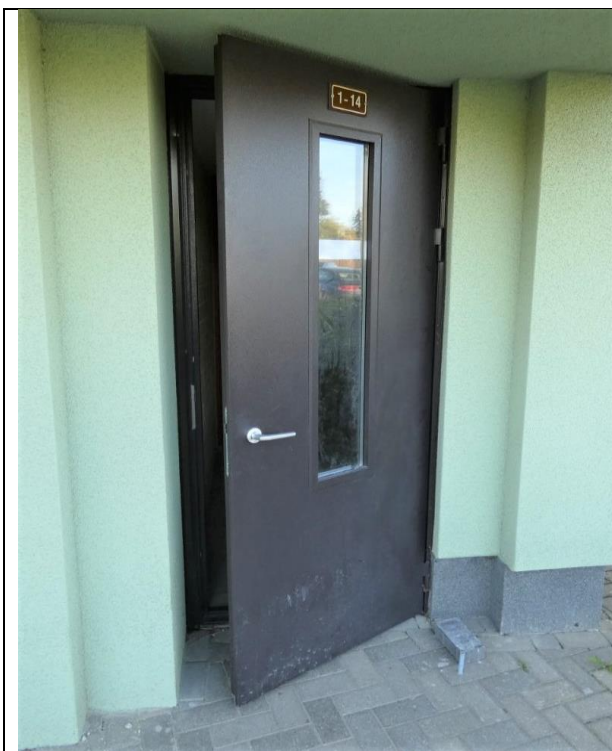
4.12.1.att. Metāla ārdurvis aprīkotas ar elektronisko kodu atslēgu.
