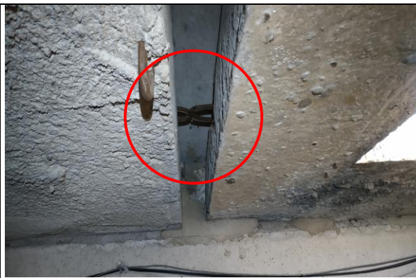
4.8.10.att. Jumta klāja ribotās dzelzsbetona plātņu tērauda cilpas nav savienotas atbilstoši montāžas projektam.
