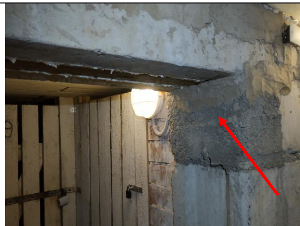
4.2.6.att. Pagrabā droša dzelzsbetona pārsedes balsta vieta.
