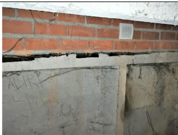
4.4.4.att. Virs cokola paneļiem māla ķieģeļu mūra josla neatbilst Projektam.
