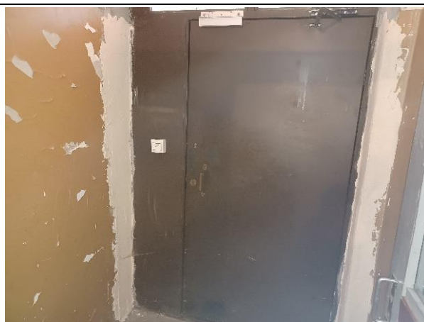
4.13.6. att. Ieejas mezgla metāla ārdurvis ar koda atslēgu apmierinošā stāvoklī
