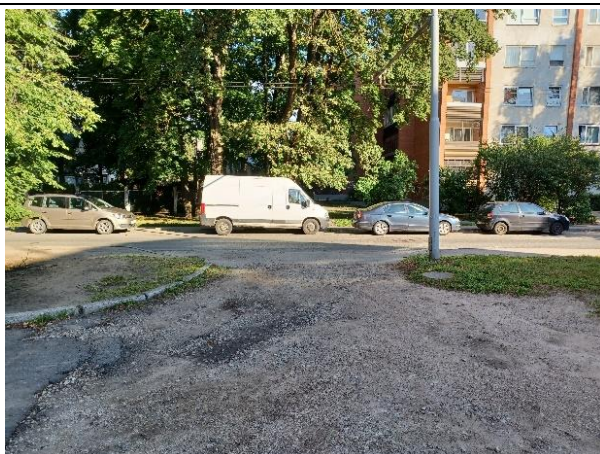
3.1.7.att. Grants seguma iebrauktuve ēkas ziemeļu pusē daļēji apmierinošā stāvoklī
