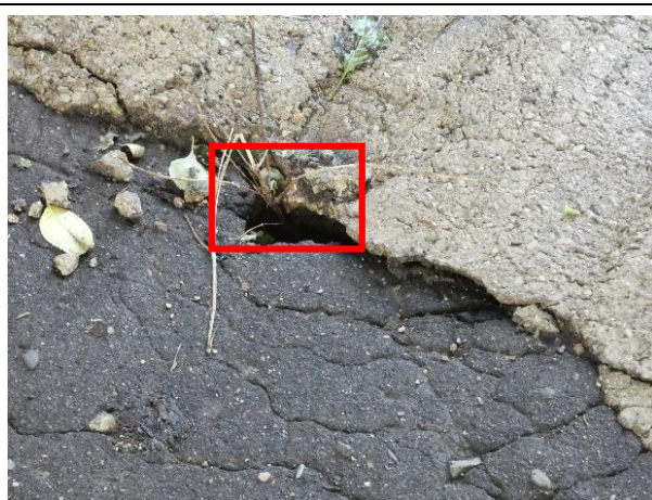
3.1.4.att. Asfaltbetona seguma laukuma nekvalitatīva atjaunošana ar cementa javu, ēkas dienvidu puse (sk. kopā ar att. 3.1.3.)
