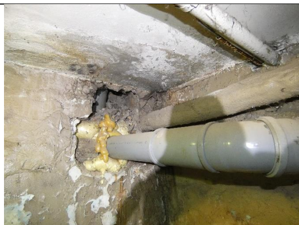
4.10.1.att. Cauruļvadu šķērsojums ugunsdrošajā konstrukcijā pagrabā, nav veikta atbilstoša aizdare.
