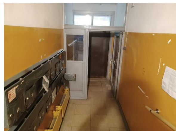
4.13.7. att. Ieejas mezgla koka iekšdurvis ar stikla pildījumu apmierinošā stāvoklī
