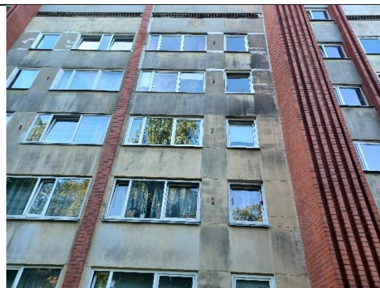
4.4.2.att. Ārsienu paneļi apmierinošā stāvoklī (ziemeļu fasāde)
