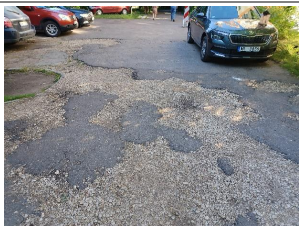
3.1.5.att. Asfaltbetona seguma bojājumi ēkas dienvidu pusē
