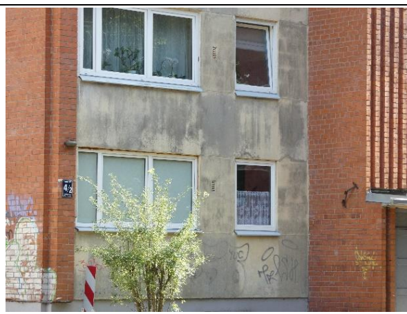
4.5.2.att. Ārsienu paneļu šuves daļēji apmierinošā stāvoklī (ziemeļu fasāde)
