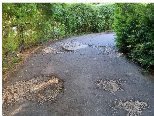
3.1.6.att. Asfaltbetona seguma bojājumi ēkas dienvidu pusē
