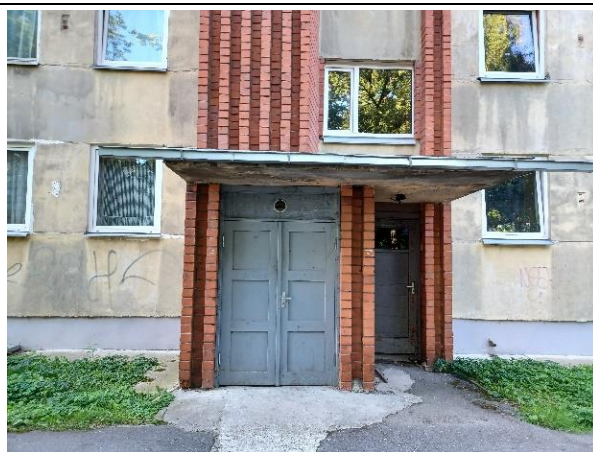
4.13.2.att. Ieejas mezgla ārdurvis un atkritumu vada telpas koka durvis ar stikla pildījumu apmierinošā stāvoklī
