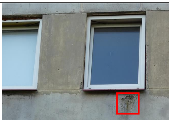
4.4.4.att. Ārsienu paneļa izdrupums (dienvidu fasāde)
