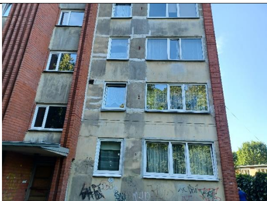
4.4.1.att. Ārsienu paneļi apmierinošā stāvoklī (ziemeļu fasāde)
