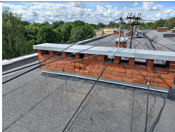
4.15.2.att. Ventilācijas kanālu ķieģeļu izdrupumi
