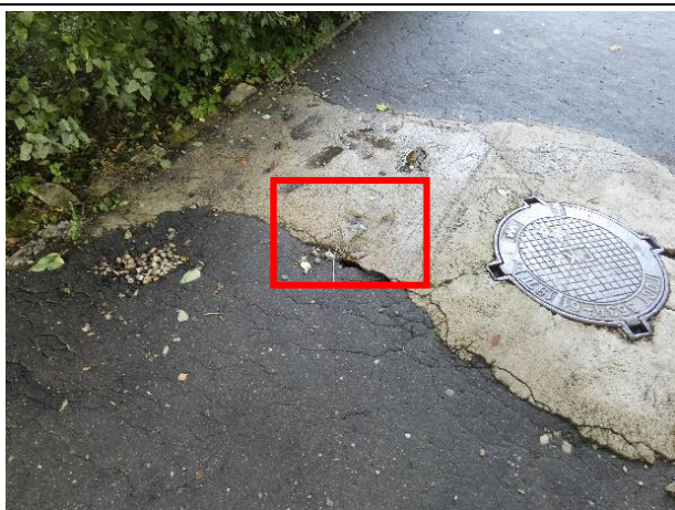
3.1.3.att. Asfaltbetona seguma laukuma nekvalitatīva atjaunošana ar cementa javu, ēkas dienvidu puse (sk. kopā ar att. 3.1.4.)
