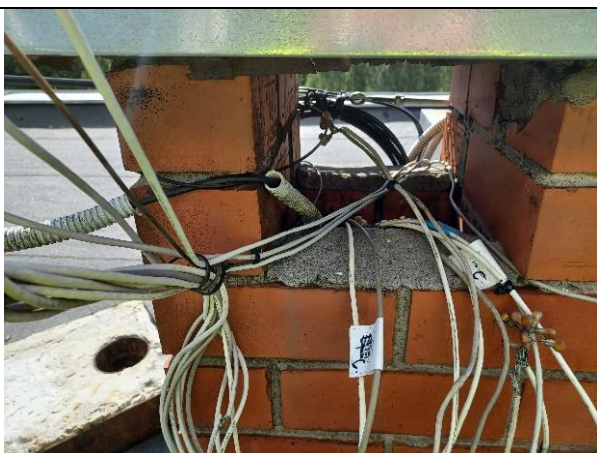
4.15.3.att. Ventilācijas kanālā ievietoti elektronisko sakaru tīklu kabeļi – nav pieļaujams.
