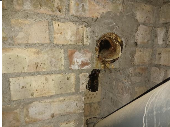
4.10.2.att. Demontēto cauruļvadu šķērsojums ugunsdrošajā konstrukcijā, nav veikta ugunsdrošā aizdare.
