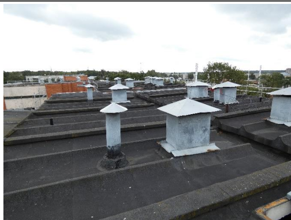
4.8.12.att. Izvadiem jumtā skārda elementi ar koroziju. Nehermētiskas pieslēgumu vietas.
