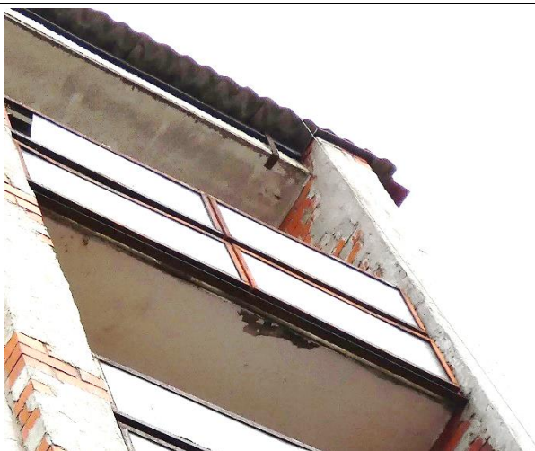
4.9.7.att. Bojāta lodžijas pārseguma plātne – plaisas, izdrupumi, atsegts korodēts stiebrojums.
