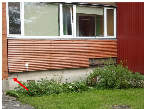
4.5.8. att. Cokola zona ar apdares bojājumiem, vertikālā hidroizolācija netika konstatēta.
