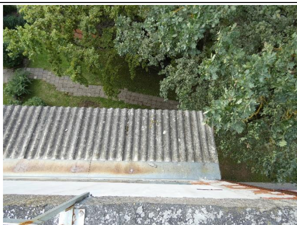
4.8.21.att. Jumta segums azbestcementsa lokšņu – kaitīgs apkārtējai videi.
