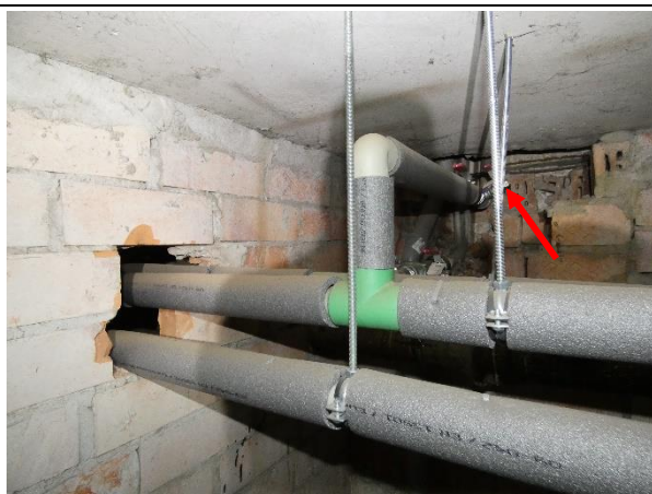
4.6.3. Att. Nehermetizētas inženiertīklu šķērsojumu vietas.
