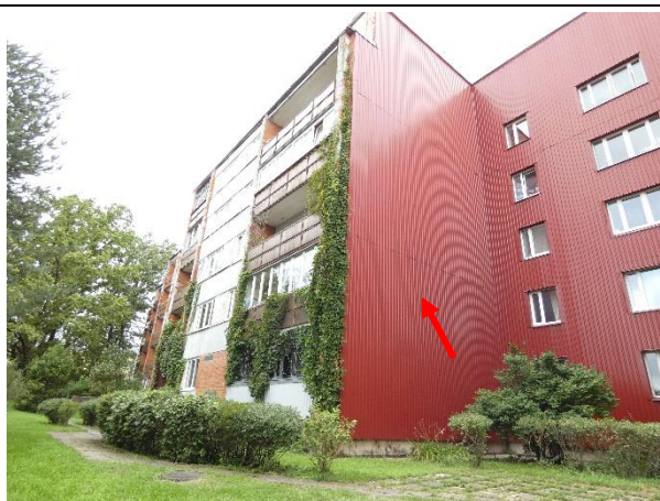
4.2.3.att. Nesošās gala sienas siltinātas un nosegtas ar profilēto skārdu – apmierinošā stāvoklī.
