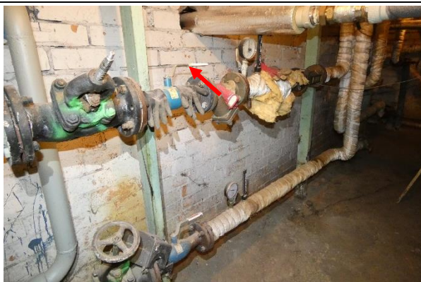
4.15.1.att. Cauruļvadu šķērsojums ugunsdrošajā konstrukcijā, nav veikta ugunsdrošā aizdare.
