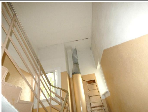
4.8.27. Att. Pārsegumi virs kāpņutelpām vietām ar lokāliem saduršuves izdrupumiem.
