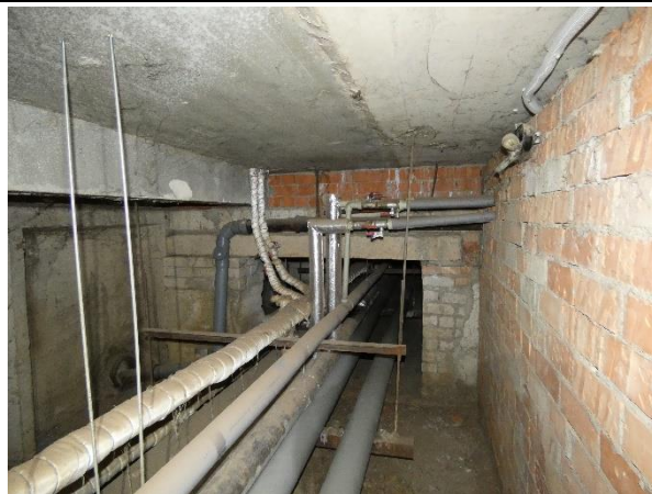
4.6.2. Att. Pagraba pārsegums apmierinošā stāvoklī.
