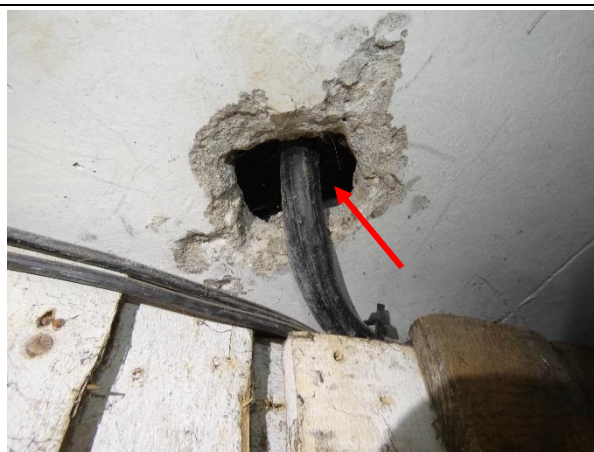
4.6.4. Att. Nehermetizēta inženiertīklu šķērsojuma vieta.
