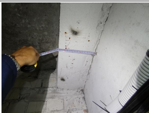
4.8.31. Att. Tērauda sijas balstījuma vieta mūra šķērssienā – apmierinošā stāvoklī
