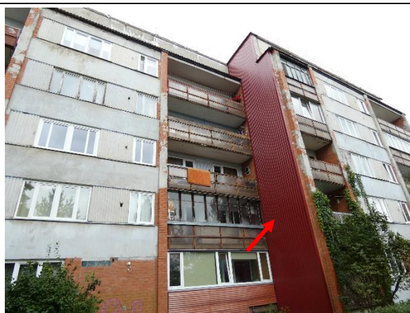
4.2.4.att. Nesošās gala sienas siltinātas – apmierinošā stāvoklī.
