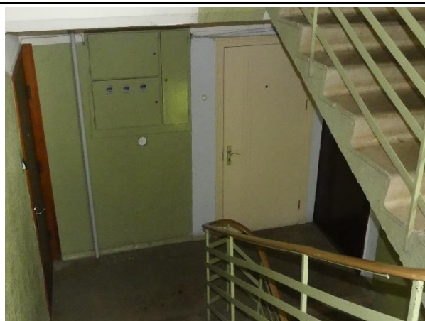
4.13.8. att. Dzīvokļu ārdurvis no dažāda materiāla, metāla, koka, u.c. – apmierinošā stāvoklī.
