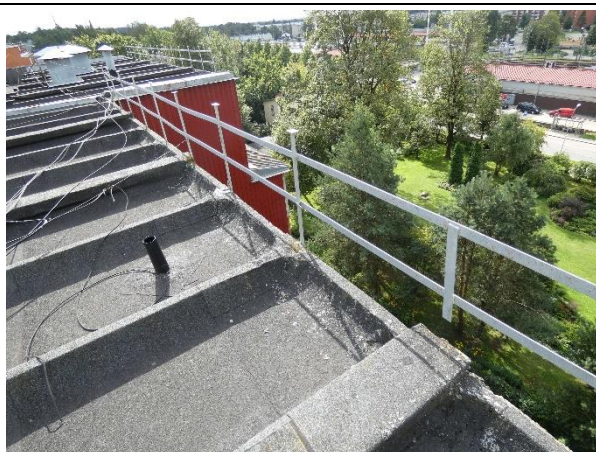
4.8.25.att. Jumta margas ar koroziju. Korodējuši vai iztrūkstoši stiprinājuma elementi.
