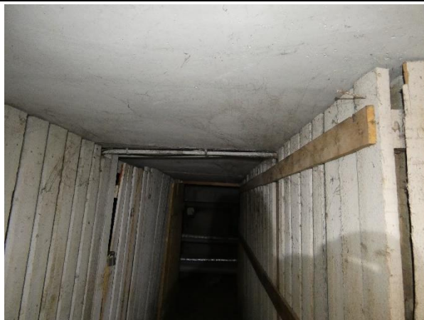
4.6.1. Att. Pagraba pārsegums apmierinošā stāvoklī.
