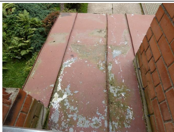
4.9.4.att. Jumtiņu segums ar bojātu aizsargkrāsojumu.
