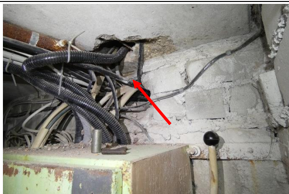
4.15.2.att. Kabeļu šķērsojums ugunsdrošajā konstrukcijā, nav veikta ugunsdrošā aizdare.
