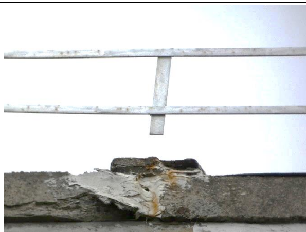
4.8.26.att. Jumta margas ar koroziju. Korodējuši vai iztrūkstoši stiprinājuma elementi.
