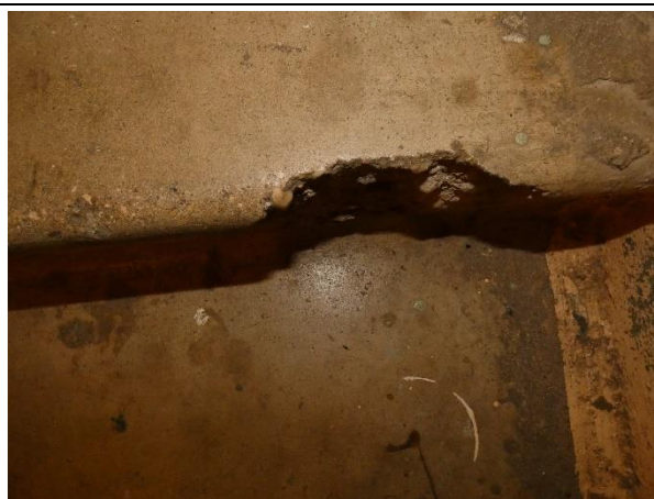
4.10.6.att. Dzelzsbetona laidumi ar lokāliem betona izdrupumiem.
