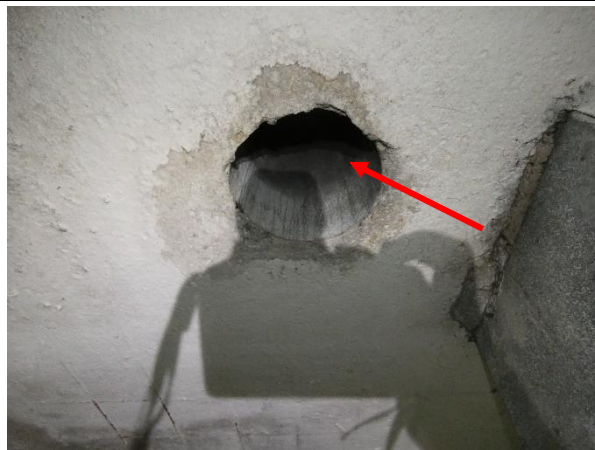
4.8.2.att. Konstatēta mitruma infiltrācija pie izvadiem jumtā.
