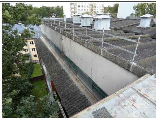
4.8.22.att. Jumta segums azbestcementsa lokšņu – kaitīgs apkārtējai videi.
