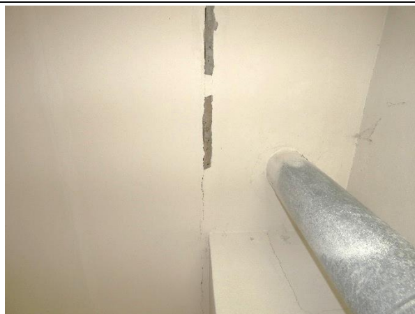
4.8.28. Att. Pārsegumi virs kāpņutelpām vietām ar lokāliem saduršuves izdrupumiem.
