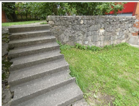
4.10.14.att. Ārējās kāpnes daļēji apmierinošā stāvoklī. Lokāli izdrupumi.
