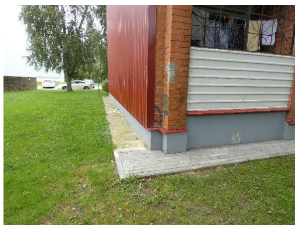
4.1.2.att. Bojāta ēkas aizsargapmale. Daļēji atjaunota aizsargapmale.
