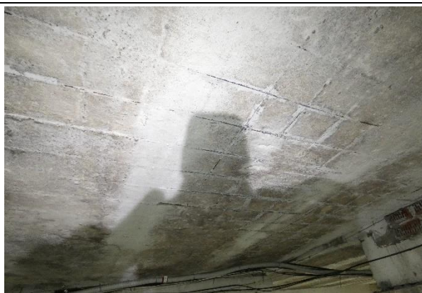
4.8.3.att. Atsegts un korodējis jumta paneļu stiegrojums. Ražošanas defekts.
