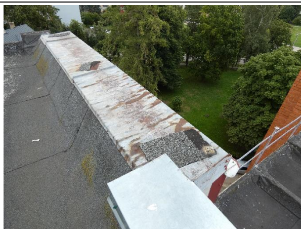
4.8.14.att. Korodējuši parapeta skārda elementi un nehermētiskas savienojumu vietas.
