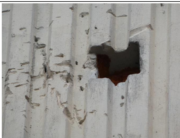
4.4.6.att. Mehāniskie bojājumi starplogu aillas aizpildījuma panelī. Nav nodrošināts ārsienas konstrukcijas hermētiskums.
