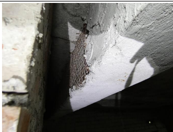
4.8.8.att. Apmesta metāla sija – apmierinošā stāvoklī.
