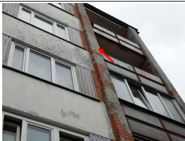
4.2.2.att. Konstatēti ievērojami ķieģeļu izdrupumi un lokālas remonta zonas.
