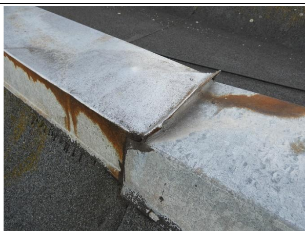
4.8.18.att. Korodējuši parapeta skārda elementi un nehermētiskas savienojumu vietas.
