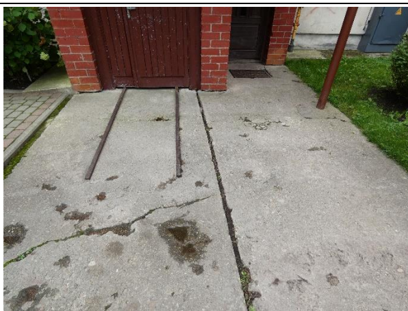
4.9.5.att. Ieejas lieveņi ar betona izdrupumiem.
