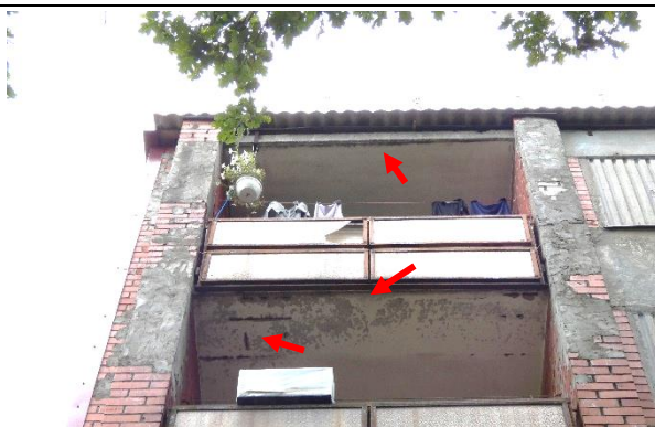
4.5.10. att. Lodžiju paneli ar mitruma radītiem bojājumiem. Hidroizolācija neapmierinošā stāvoklī.
