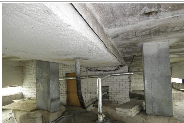
4.8.5.att. Atsegts un korodējis jumta paneļu stiegrojums. Dzelzsbetona tekne apmierinošā stāvoklī.
