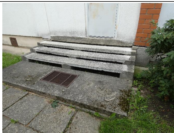
4.9.6.att. Ieejas lieveņi ar betona izdrupumiem.
