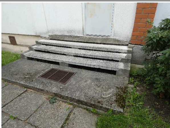
4.10.13.att. Ārējās kāpnes daļēji apmierinošā stāvoklī. Lokāli izdrupumi.
