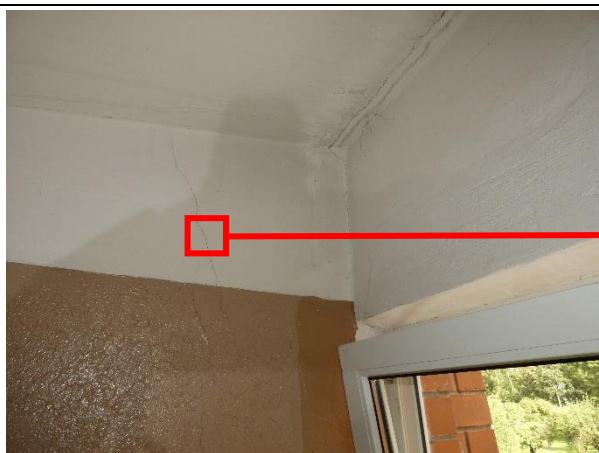
4.2.5.att. Plaisas kāpņu telpas nesošajā sienā.
