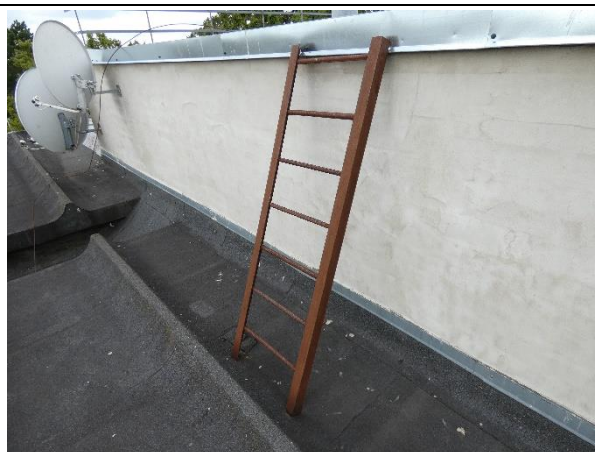
4.10.16.att. Ārējās kāpnes uz jumta nav nostiprinātas, konstatēta korozija.
