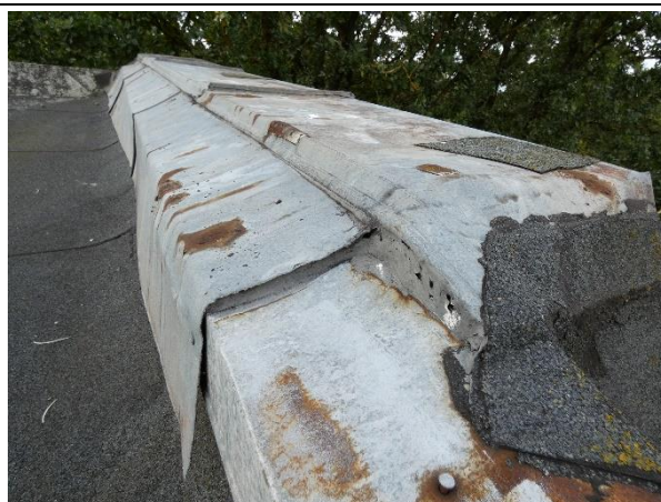
4.8.20.att. Korodējuši parapeta skārda elementi un nehermētiskas savienojumu vietas.
