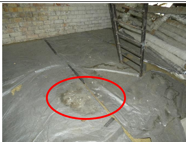
4.5.12. att. Mitruma infiltrācijas pazīmes uz bēniņu pārseguma
