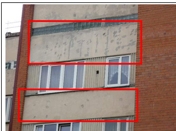
4.4.1. Piekārtie sienu paneļi ar bojājumiem.
