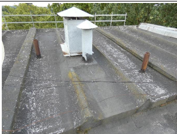
4.8.19.att. Jumta segums ar apaugumiem. Zuduši nosedzošie vāciņi izvadiem jumtā.
