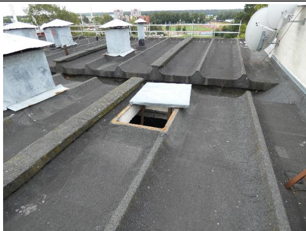
4.8.11.att. Bitumena jumta segums – daļēji apmierinošā stāvoklī.
