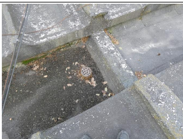
4.8.17.att. Gruži jumta tekņē. Jumta segums ar apaugumiem.
