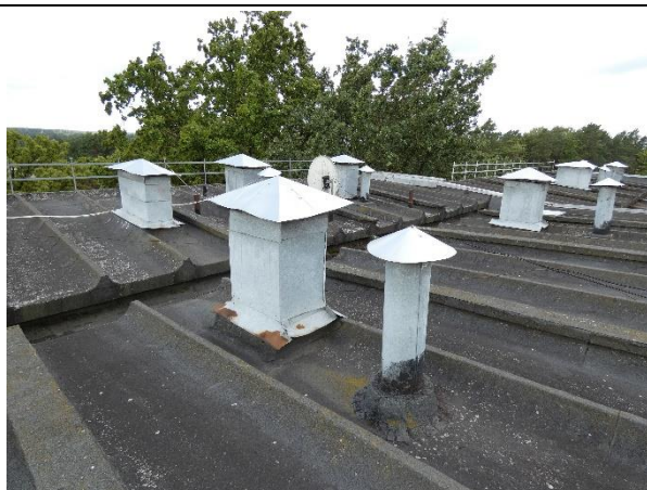
4.8.15.att. Izvadiem jumtā skārda elementi ar koroziju. Nehermētiskas pieslēgumu vietas.
