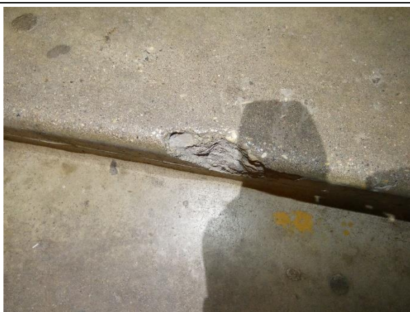
4.10.5.att. Dzelzsbetona laidumi ar lokāliem betona izdrupumiem.
