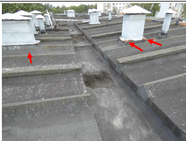
4.8.13.att. Nesakārtoti kabeļu uz jumta. Izvadiem jumtā skārda elementi ar koroziju.
