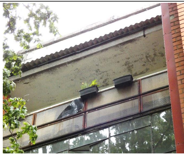
4.9.8.att. Bojāta lodžijas pārseguma plātne – plaisas, izdrupumi, atsegts korodēts stiebrojums.
