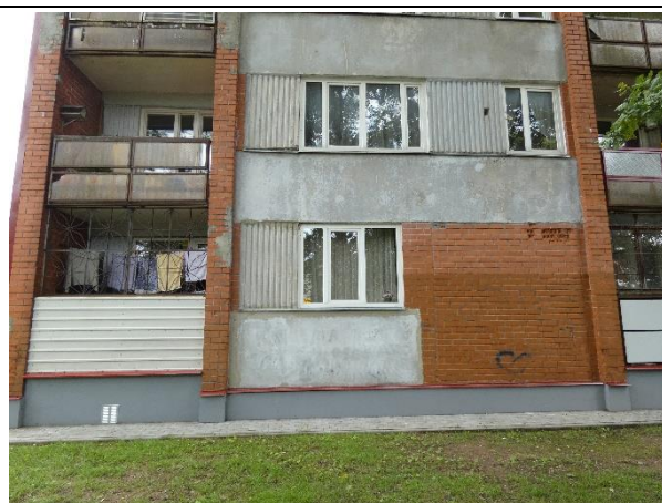
4.4.12.att. Bojājumi fasādes konstrukcijās. Ēkas ekspluatācijas laikā aizmūrēta eja.
