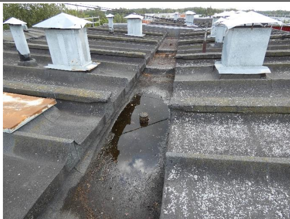
4.8.23.att. Mitruma uzkrāšanās dzelzsbetona tekņē. Jumta segums ar apaugumiem.
