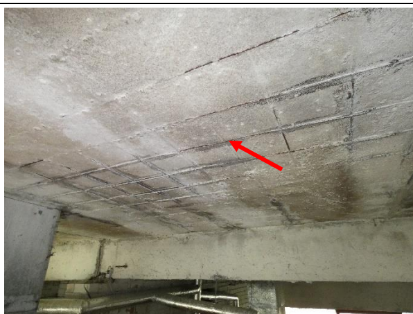
4.8.9.att. Mitruma infiltrācijas pazīmes, atsegts un korodējis jumta paneļu stiegrojums. Nepietiekama aizsargkārtas - ražošanas defekts.
