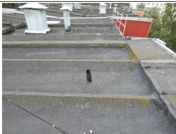
4.8.16.att. Jumta segums ar apaugumiem. Zuduši nosedzošie vāciņi izvadiem jumtā.
