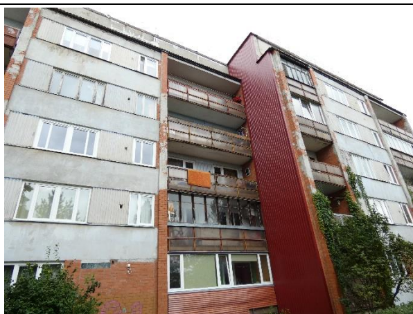
4.4.11.att. Ķieģeļu izdrupumi un remonta zonas nesošajās šķērssienās.
