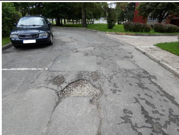
3.1.1. Brauktuves daļa neapmierinošā stāvoklī.
