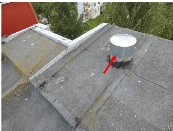
4.16.3.att. Atkritumu vada ventilācijas izvads virs jumta – apmierinošā stāvoklī.
