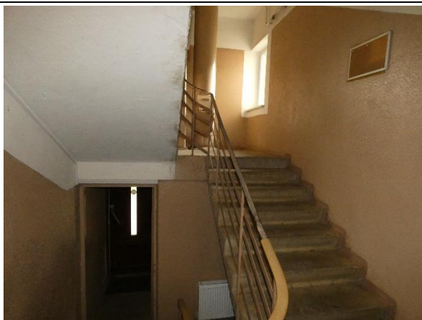
4.10.7.att. Kāpņu margas ar vinila elementu bojājumiem.
