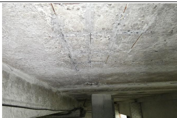
4.8.6.att. Atsegts un korodējis jumta paneļu stiegrojums. Ražošanas defekts.
