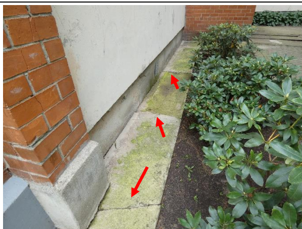
4.5.7. att. Cokola zona ar aizsargapmales bojājumiem. Pastāv risks mitruma iekļūšanai pagrabā.
