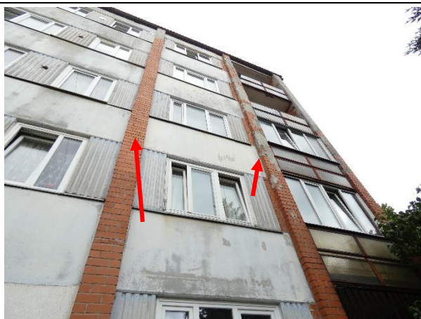
4.2.1.att. No nokrišņiem neaizsargāts nesošo šķērssienu fasādes daļas mūris.
