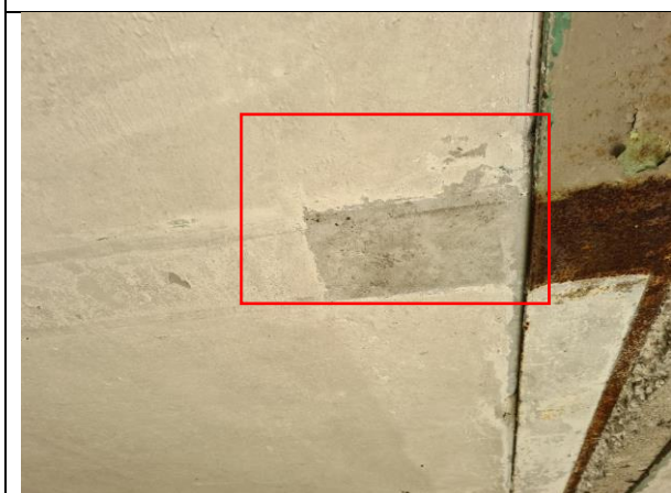
2.5.att. Dobās starpstāvu pārseguma plātnes
