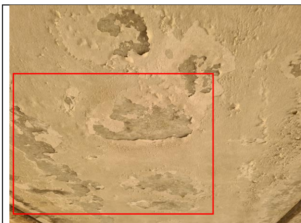
2.1.att. Dobās starpstāvu pārseguma plātnes
