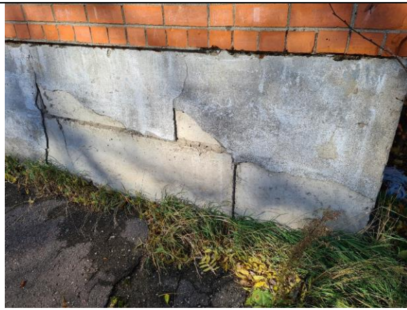
1.4.2.att. Pamatu bloki ΦC-4 ar biezumu 400 mm. Būvdarbi veikti nekvalitatīvi – nav aizpildītas šuves starp blokiem. Būtiskas pamatu sēšanās pazīmes vai nesošo sienu deformācijas netika konstatētas.
