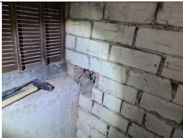
4.1.att. Tipveida Projektā (att. 4.3.) paredzētie stiegrojuma elementi ИМ-7 virs ārsienas paneļa netika konstatēti
