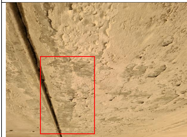
2.3.att. Dobās starpstāvu pārseguma plātnes
