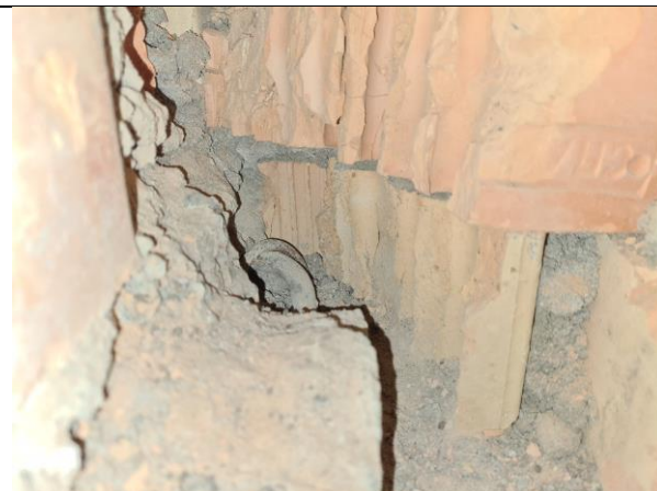
4.2.att. Konstatēts cilpveida izlaidums d12 mm un skava d6 mm, kas visdrīzāk enkurota mūra šuvē. Savienojuma mezgls monolitizēts ar betonu (pildvielas ar frakciju 4-6 mm). Metāla elementi bez pretkorozijas apstrādes, tomēr būtiskas korozijas pazīmes nav konstatētas.
