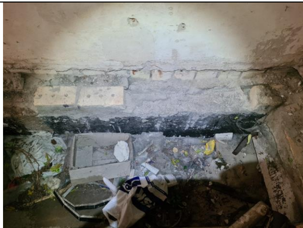
1.4.1.att. Pamatu bloki ΦC-4 konstatēti 150 mm zem pagraba grīdas līmeņa. Ierīkota vertikālā pamatu hidroizolācija.
