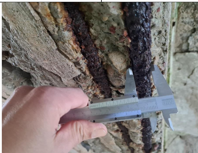
6.3.att. Dzelzsbetona pārsedzes kāpņu telpas nesošajā mūra sienā ar stiegrojumu 4x d20 mm apakšējā daļā. Pastiprināta mitruma iedarbībā betona aizsargkārtā pilnībā atdalījusies un norit pastiprināta stiegrojuma korozija.
