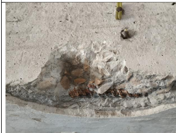
3.3.att. Dzelzsbetona pārsedze. Karbonizētais slānis lielāks par 1,0 cm.
