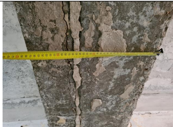
6.2.att. Dzelzsbetona pārsedzes nesošās mūra šķērssienas vidusdaļā. Sk. kopā ar att. 6.1.
