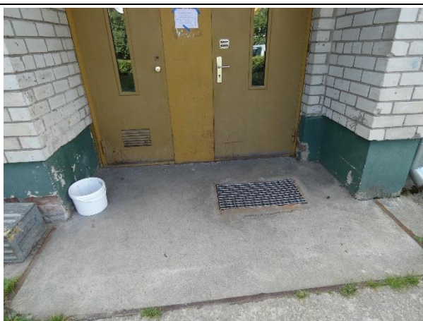
4.9.5.att. Ieejas lieveņi ar betona izdrupumiem.
