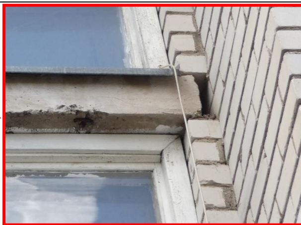
4.2.12.att. Neprecīzi veikta ailas pārsedzes montāža. Deformācijas nav konstatētas.
