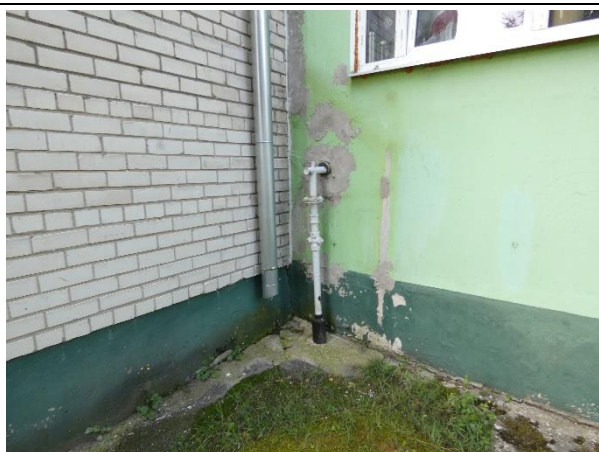
4.2.7.att. No nokrišņiem neaizsargāts gala sienas mūris – notekcaurulei nav pievienots līkums. Aizdarīta sprauga sienu sadurvietā.
