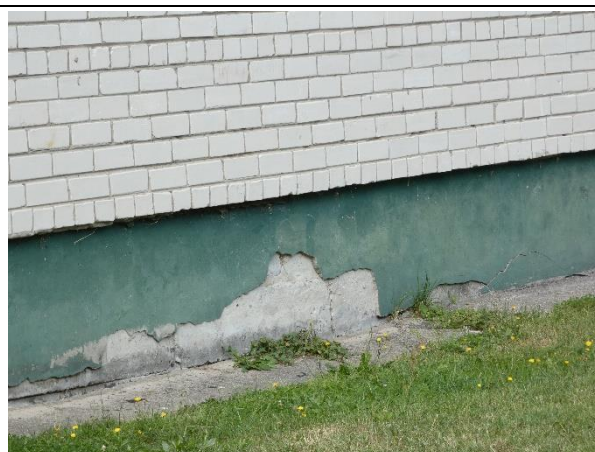
4.5.10. att. Cokola zonā vertikālā hidroizolācija netika konstatēta.
