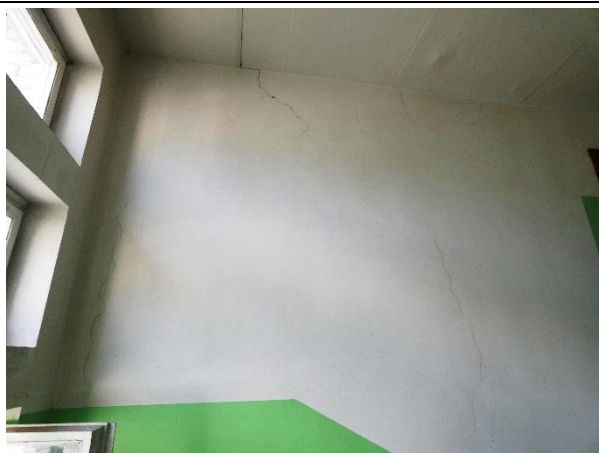
4.2.9.att. Kāpņu telpā pārseguma plātņu balsta vietā konstatētas diagonālās plaisas mūra nesošajā šķērssienā.
