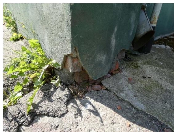
4.1.4.att. Cokola daļā vertikālā hidroizolācija netika konstatēta. Konstatēti apmetuma izdrupumi un mūrējuma bojājumi.
