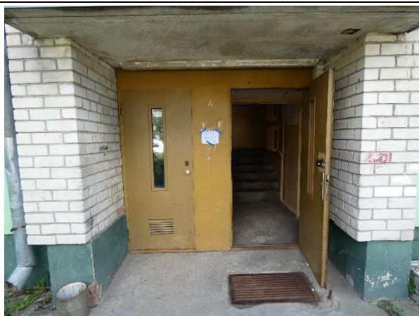
4.13.5. att. Kāpņutelpām metāla ārdurvis ar koroziju – daļēji apmierinošā stāvoklī.
