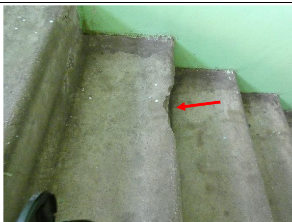
4.10.6.att. Dzelzsbetona laidumi ar lokāliem betona izdrupumiem.
