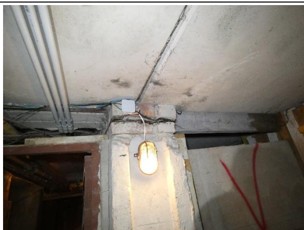
4.6.1. Att. Pagraba pārseguma paneli – apmierinošā stāvoklī.
