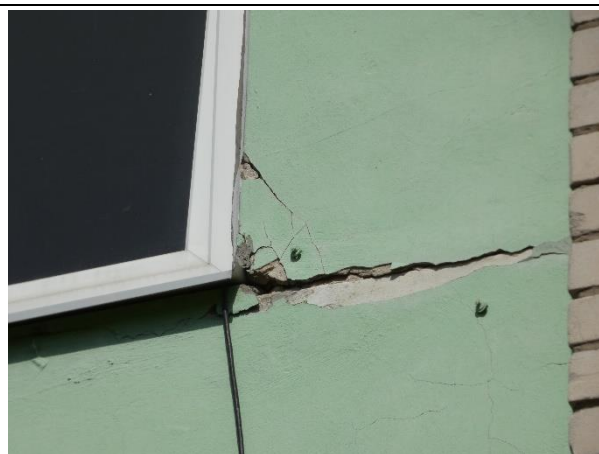
4.5.3. att. Nehermētiska starppaneļu šuve un izdrupumi.
