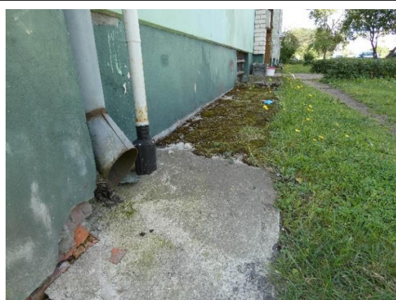
4.1.1.att. Bojāta ēkas aizsargapmale.
