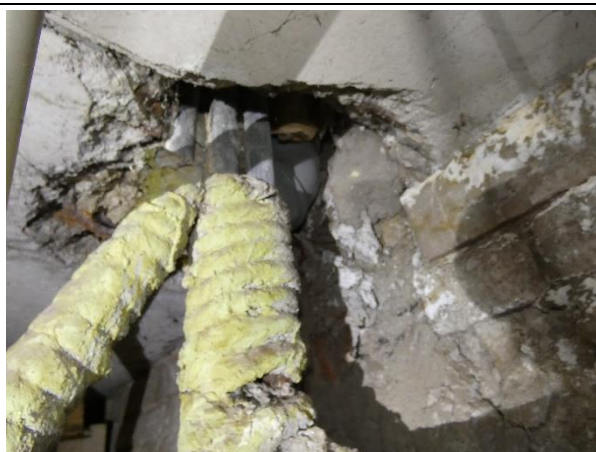
4.15.1. Cauruļvadu šķērsojums ugunsdrošajā konstrukcijā, nav veikta ugunsdrošā aizdare
