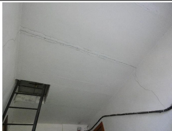
4.2.10.att. Kāpņu telpā konstatētas plaisas mūra nesošajā šķērssienā pārseguma plātņu balsta vietā.
