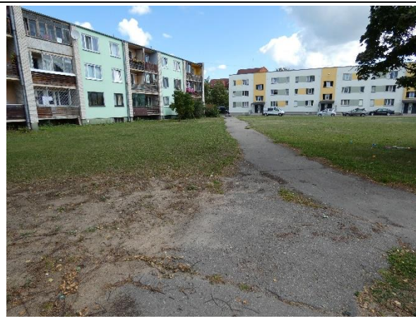
3.1.4.att. Ietves – daļēji apmierinošā stāvoklī.
