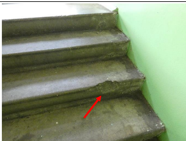
4.10.5.att. Dzelzsbetona laidumi ar lokāliem betona izdrupumiem.
