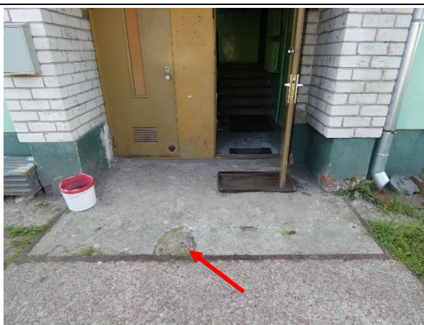
4.9.6.att. Ieejas lieveņi ar betona izdrupumiem.
