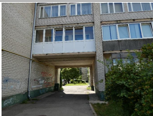
4.6.5. Att. Pārsegums virs caurbauktuves daļēji apmierinošā stāvoklī.
