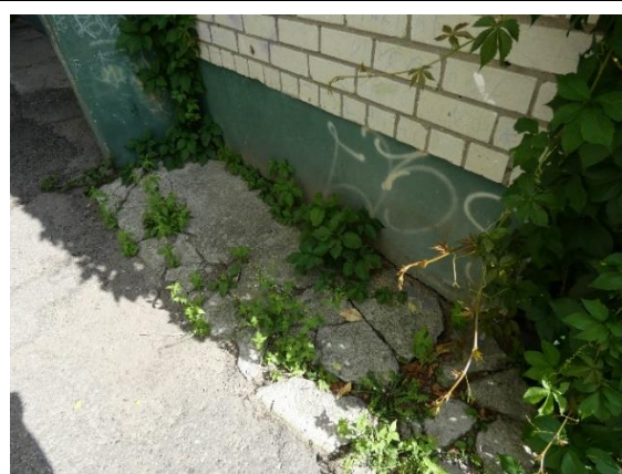
4.1.2.att. Bojāta ēkas aizsargapmale.
