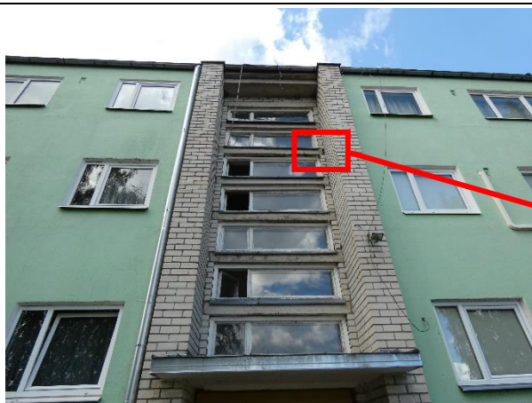
4.2.11.att. Neprecīzi veikta ailas pārsedzes montāža.
