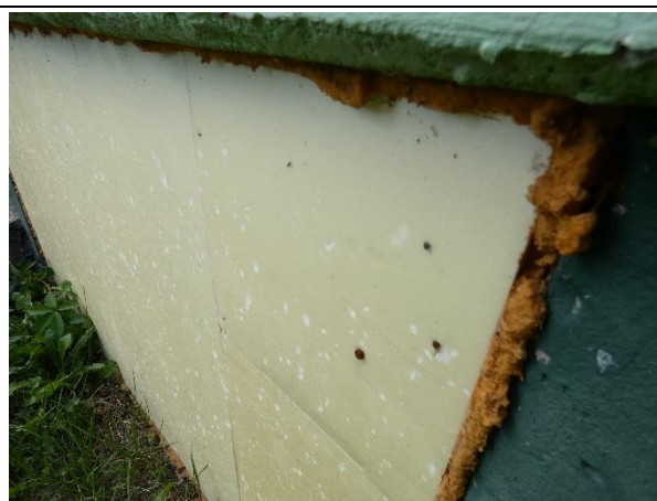
4.5.8. att. Nehermētiska šuve pagraba loga aizpildījuma vietā, remontam pielietots nepiemērots būvmateriāls
