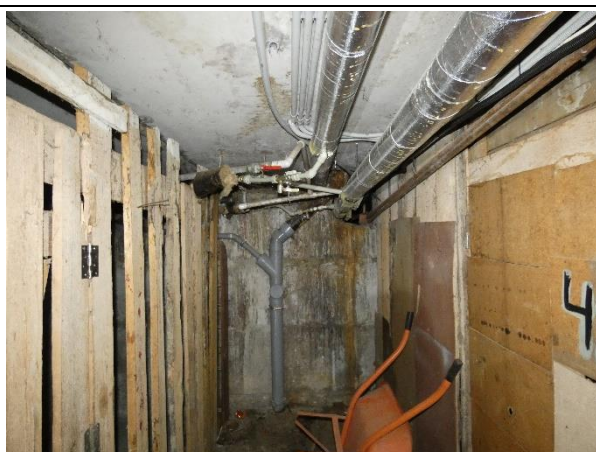
4.13.13. att. Pagrabā durvis koka konstrukcijās – daļēji apmierinošā stāvoklī.
