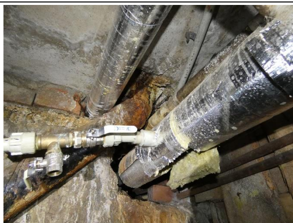
4.15.2.att. Cauruļvadu šķērsojums ugunsdrošajā konstrukcijā, nav veikta ugunsdrošā aizdare
