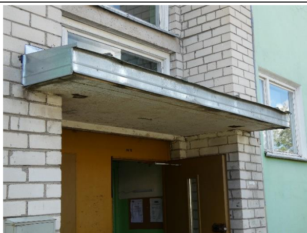
4.9.1.att. Jumtiņi virs ieejas mezgļiem daļēji apmierinošā stāvoklī. Nehermēiskas skārda elementu pievienojumu vietas sienām.
