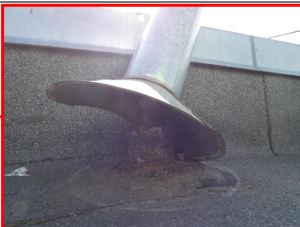
4.8.12.att. Bojāts skārda nosegelements kanalizācijas ventilācijas izvadam.
