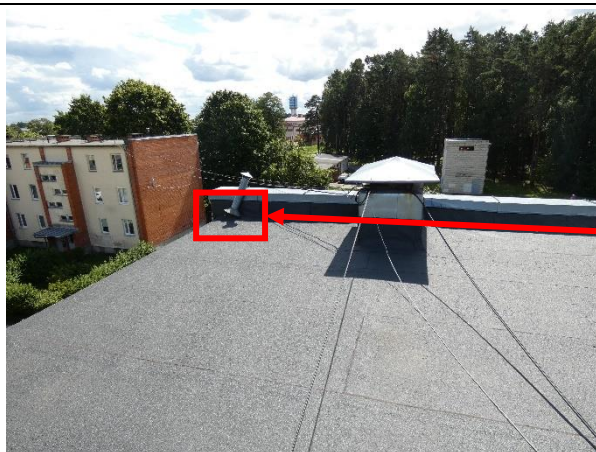
4.8.11.att. Bojāts skārda nosegelements kanalizācijas ventilācijas izvadam.
