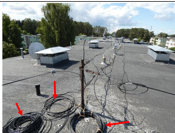
4.8.2.att. Nepievienoti kabeļi uz jumta.
