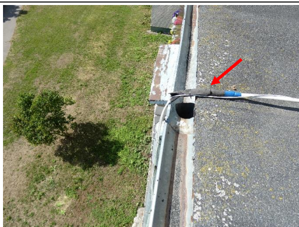
4.8.3.att. Kabeli nav atbilstoši aizsargāti.
