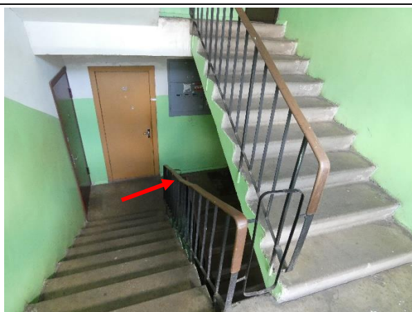
4.10.7.att. Kāpņu margas ar deformācijām.
