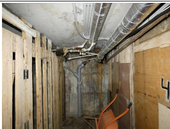
4.6.2. Att. Pagraba pārseguma paneli – apmierinošā stāvoklī.
