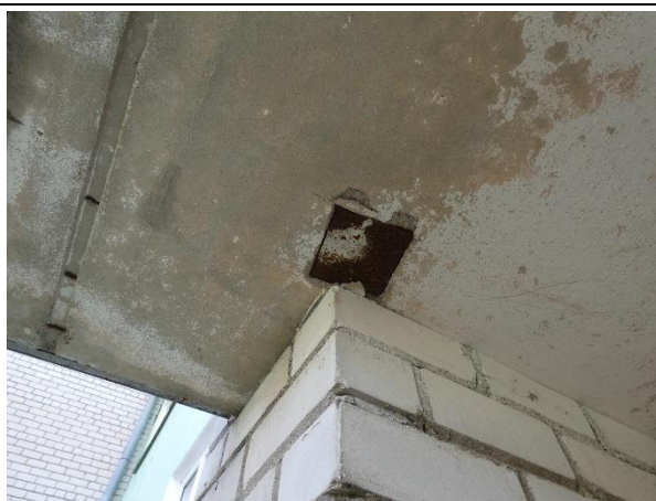
4.9.2.att. Jumtiņi virs ieejas mezgļiem daļēji apmierinošā stāvoklī. Korodējis stiegrojumu un metāla eliekamās detaļas.
