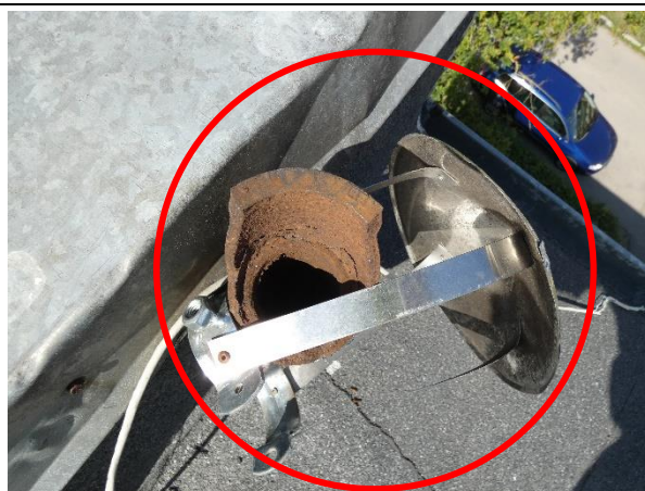
4.8.4.att. Bojāts kanalizācijas ventilācijas izvada noseglements.
