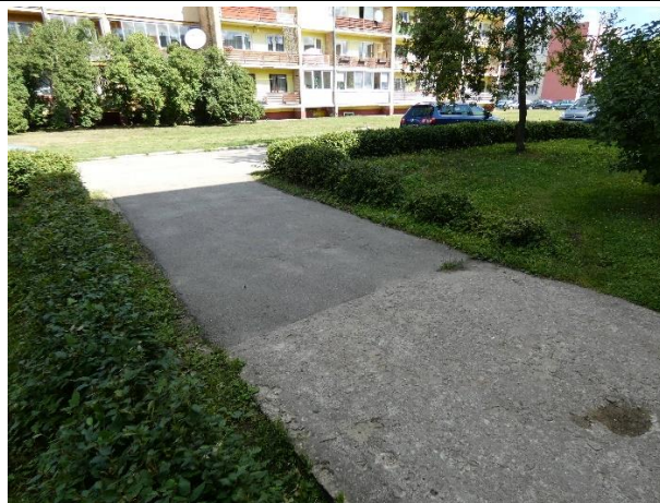
3.1.2.att. Brauktuves un ietves – daļēji apmierinošā stāvoklī.
