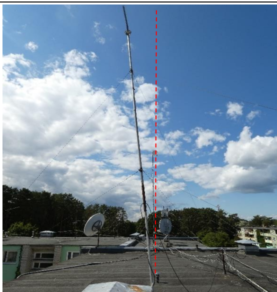
4.8.5.att. Antenas uz jumta ar novirzi no vertikālītātes.
