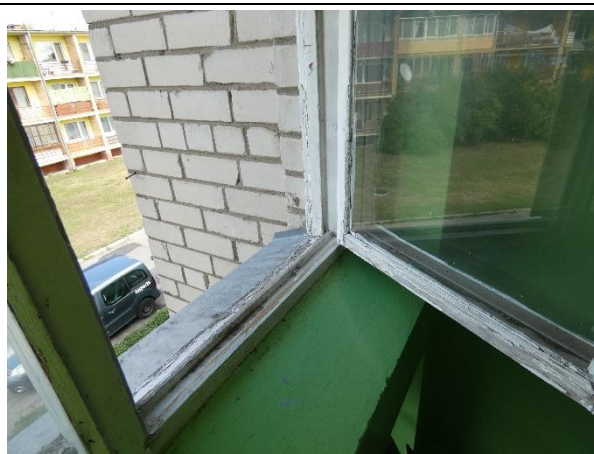
4.13.8. att. Koka logiem konstatēta būtiska aizsargkrāsojuma atslāņošanās.
