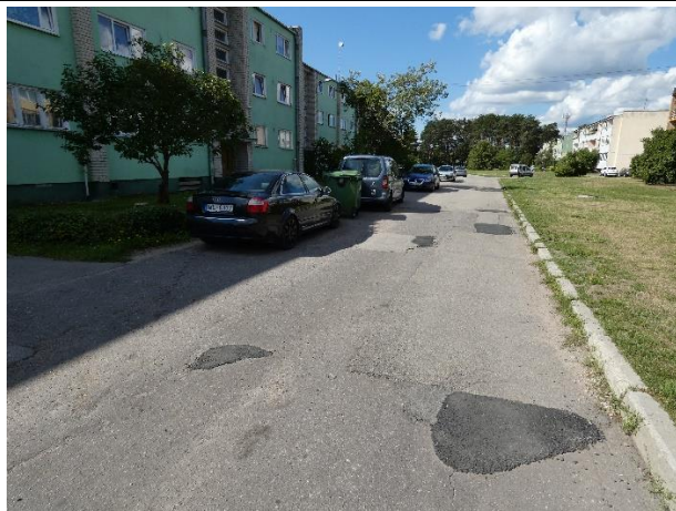
3.1.1. Brauktuves un ietves – daļēji apmierinošā stāvoklī.
