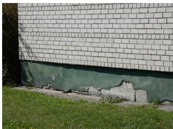
4.1.3.att. Cokola daļā vertikālā hidroizolācija netika konstatēta. Konstatēta apmetuma atslāņošanās.
