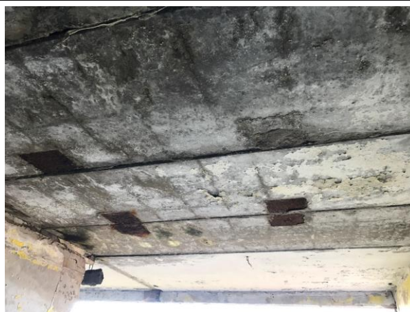
4.6.4.att. Starpstāvu pārseguma plātnes ar mitruma izraisītiem bojājumiem
