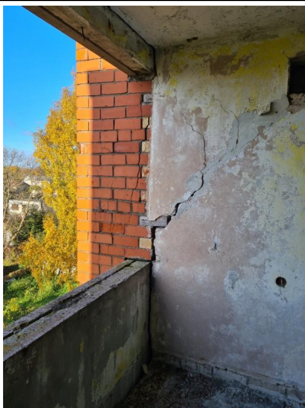
4.2.1.att. Nesošās mūra sienas ar caurejošām, slīpām plaisām – konstrukcijas ir avārijas stāvoklī
