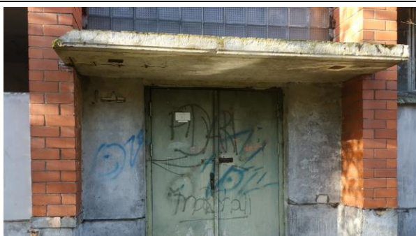
4.9.3.att. Ieejas mezgla dzelzsbetona jumta konstrukcija ēkas ZA pusē ar betona struktūras bojājumiem un stieģrojuma koroziju
