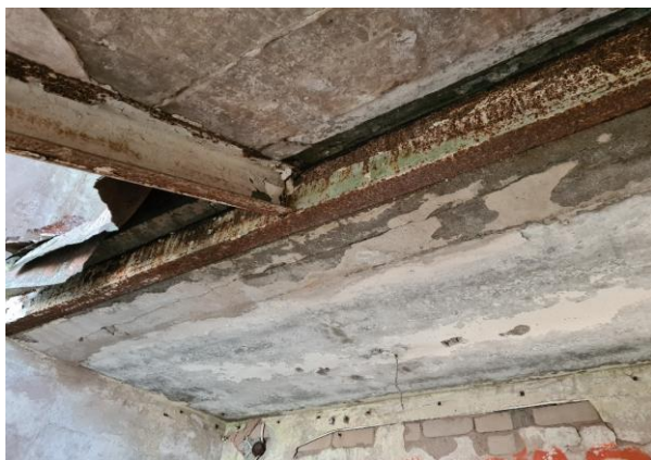
4.10.1.att. Kāpņu nesošās metāla konstrukcijas ar korozijas bojājumiem visā platībā. Kāpnes ir neapmierinošā tehniskajā stāvoklī.
