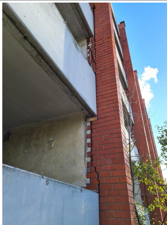
4.2.4.att. Nesošās mūra sienas pilastri ar caurejošām plaisām, konstrukcijas ir avārijas stāvoklī
