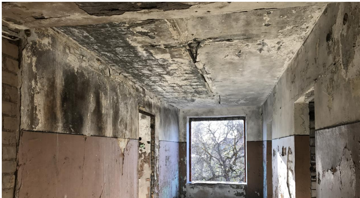
4.8.1.att. Savietotā jumta dobās dzelzsbetona pārseguma plātnes ar mitruma izraisītiem bojājumiem
