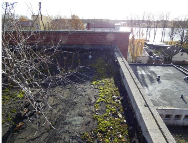
4.8.4.att. Jumta klājs ar apaugumu. Skārda nosegelementi nav uzstādīti.
