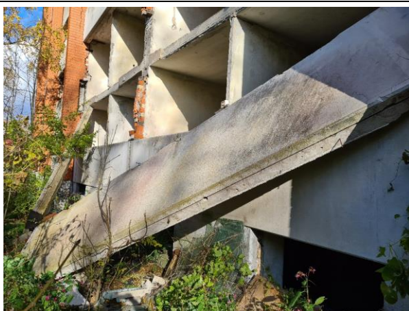
4.4.3.att. Atdalījies ārsienas panelis. Nesošo mūra sienu pilastrī paneļu balsta vietās sabrukušī, izraisot pašnesošo sienu sagrūšanu. Ēka ir avārijas stāvoklī.
