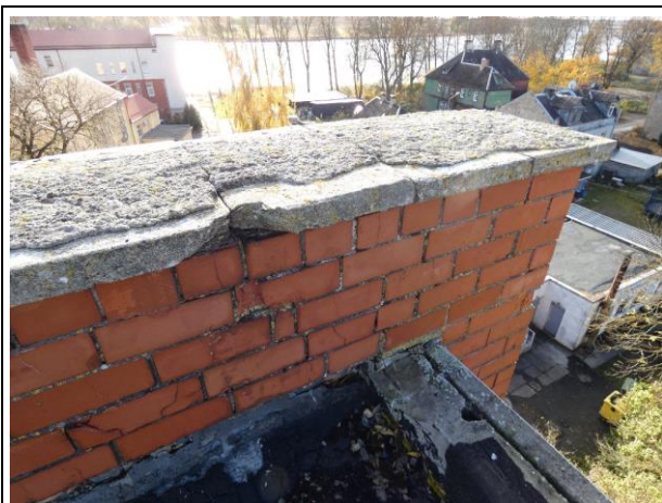
4.8.5.att. Betona nosegelementi ar izdrupumiem
