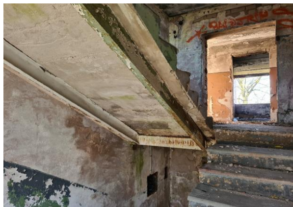
4.10.2.att. Kāpņu margas nav uzstādītas. Kāpņu nesošās metāla konstrukcijas ar korozijas bojājumiem visā platībā. Kāpnes ir neapmierinošā tehniskajā stāvoklī.
