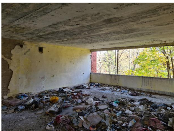
4.6.3.att. Starpstāvu pārseguma plātnes ar mitruma izraisītiem bojājumiem
