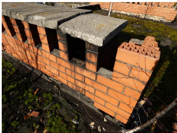
4.8.3.att. Ventilācijas izvadu mūra destrukcija
