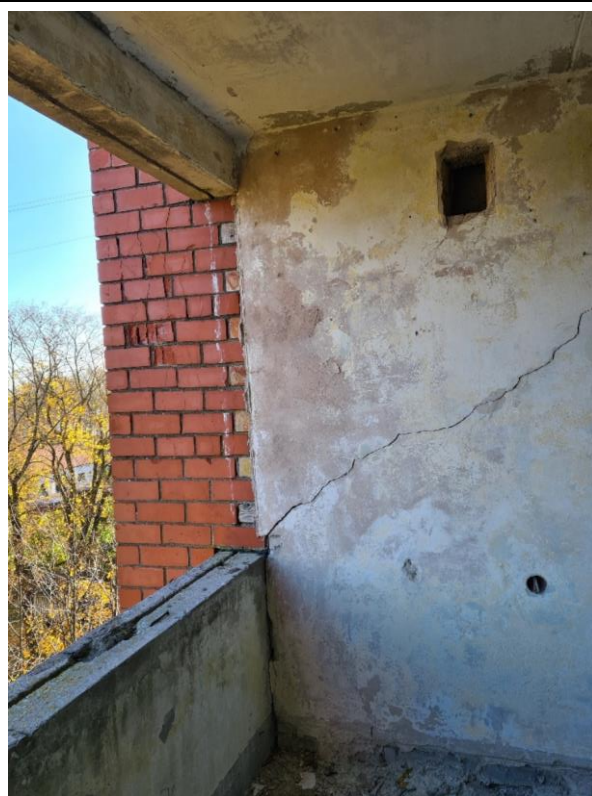
4.2.2.att. Nesošās mūra sienas ar caurejošām, slīpām plaisām – konstrukcijas ir avārijas stāvoklī
