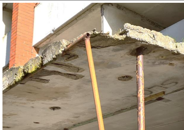
4.9.2.att. Ieejas mezgla jumta dzelzsbetona plātne ir avārijas stāvoklī . Notiek betona struktūras destrukcija sala un mitruma iedarbībā, kā arī pastiprināta stieģrojuma korozija.
