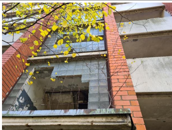
4.12.2.att. Bojāts stikla bloku ailu aizpildījums kāpņu telpā
