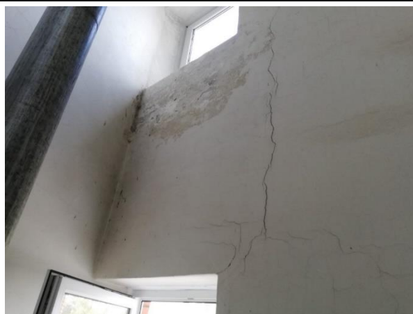
4.2.34.att. Plaisa un mitruma bojājumi 2.sekcijas kāpņu telpas mūra sienā. Ilgstoši nav veikts jumta seguma remonts. Valmieras iela 21, Cēsis.
