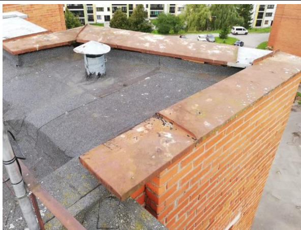
4.8.49.att. Savietotais jumta pārsegums virs kāpņu telpas. Nekvalitatīvi iesegts segums un skārda nosegelementi. Valmieras iela 21, Cēsis
