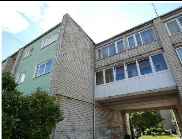
3.9.att. Lodžiju konstrukcijas neatbilst Projekta risinājumam. Patvaļīgas būvniecības pazīmes. Mazcenu aleja 9, Jaunmārupe
