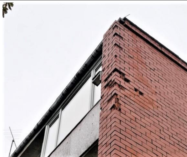
4.2.18.att. Klimatisko apstākļu ietekmē erodējis gala sienas mūris. Saulkalni, Liepa.
