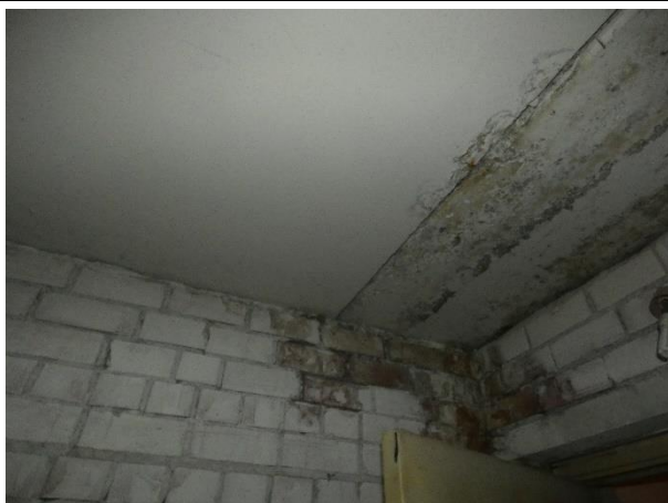
4.8.18.att. Jumta dzelzsbetona pārseguma plātnes ar mitruma bojājumiem 5.stāvā. Loka iela 3, Cēsis.
