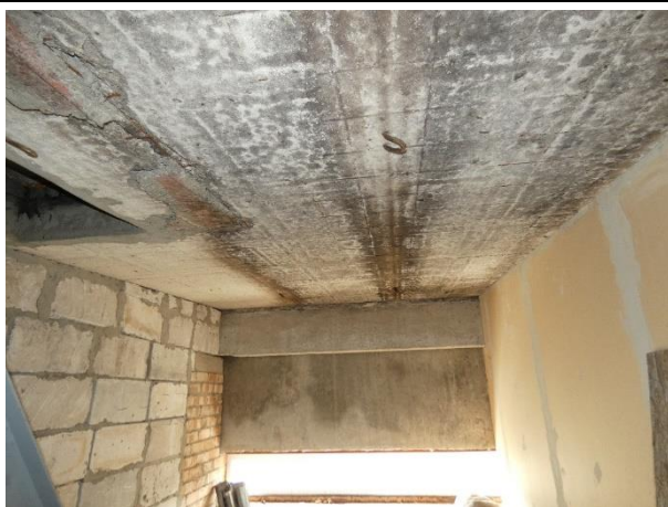
4.8.8.att. Jumta klāja dzelzsbetona plātnes ar mitruma radītiem bojājumiem. Irlavas iela 26, Rīga.
