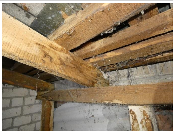
4.8.38.att. Jumta nesošā konstrukcija no koka elementiem ar mitruma un bojājumu pazīmēm. Mazirbe, Skolotāju māja 2.
