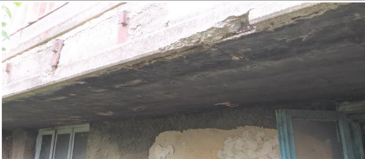
4.9.11.att. Ugunsgrēka rezultātā bojāta lodžijas pārseguma plātne – plaisas, izdrupumi un atsegts stiegrojums. Saulkalni, Liepa
