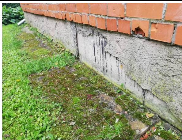
4.1.10.att. Bloku pagraba sienas cokola daļa. Konstatēta horizontālā hidroizolācija. Apmetums atdalījies no pamatnes. Pūpoli, Liepa.
