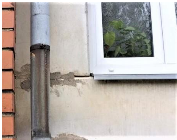
4.4.20.att. Bojāts starppaneļu šuves aizpildījums. Saulkalni, Liepa.
