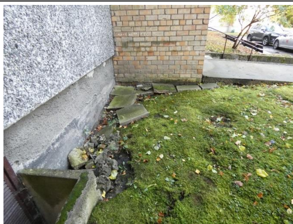
4.1.18.att. Ēkas aizsargapmale sabrukusi pa visu ēkas perimetru. Grēdu 3, Rīga.
