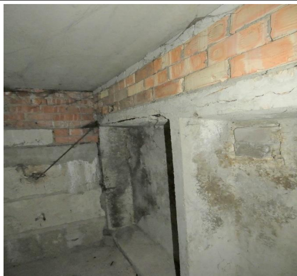
4.2.6. att. Pagraba cokola paneli ar atsegtu, korodējušu stiegrojumu un mitruma radītiem bojājumiem. Irlavas iela 26, Rīga.
