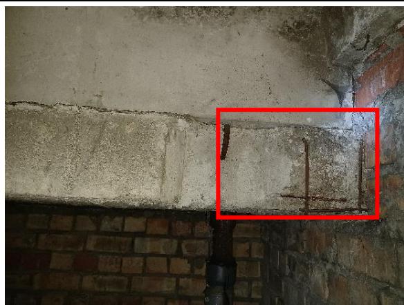
4.8.4.att. Teknes balsta vietā stiebrojuma korozija un aizsargkārtas izdrupumi (3. kāpņu telpa, bēniņi), bojājumi nav. Kapseļu iela 4 k-2, Rīga.
