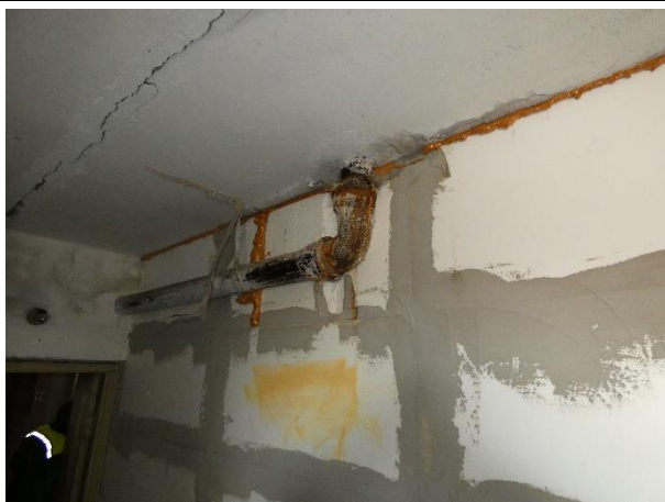
4.8.74.att. Lietus ūdens kanalizācijas cauruļvadi (ķeta) ar neblīvumu, notecējumu pazīmēm. Loka iela 3, Cēsis
