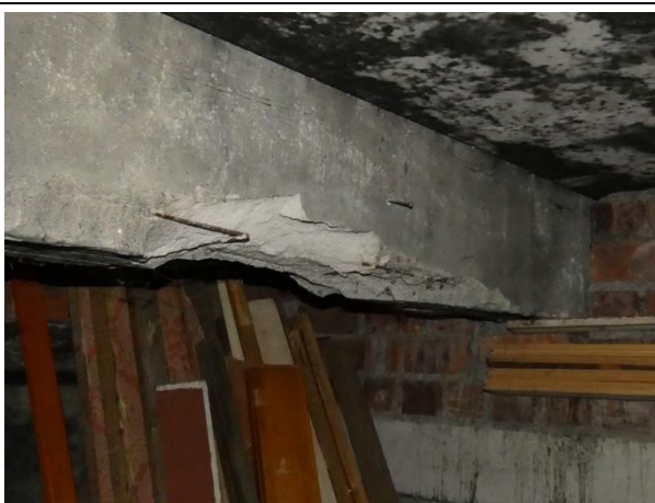
4.4.11. att. Lokāli izdrupumi ārsienas panelī. Irlavas iela 26, Rīga.
