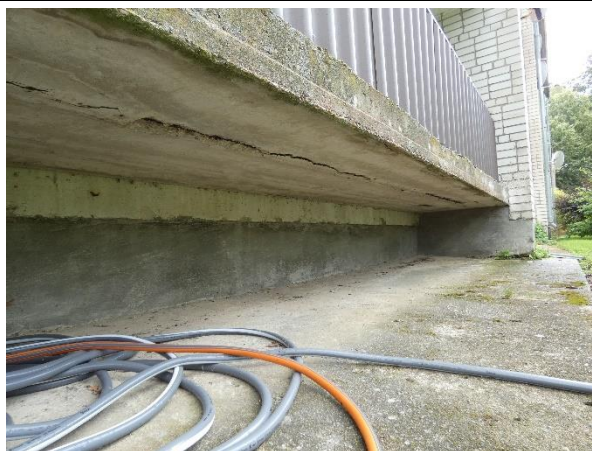
4.9.2.att. Bojāta lodžijas pārseguma plātne – plaisas, izdrupumi, atsegts korodēts stiebrojums. Mazirbe, Skolotāju māja 2
