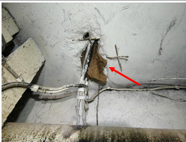
4.6.10. Att. Neatbilstoši hermetizēta inženiertīklu šķērsojumu vieta. 1905.gada iela, Talsi
