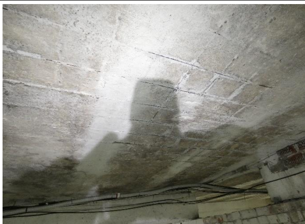
4.8.12.att. Atsegts un korodējis jumta panelu stiegrojums. Ražošanas defekts. Ausekļa prospekts 1, Ogre.
