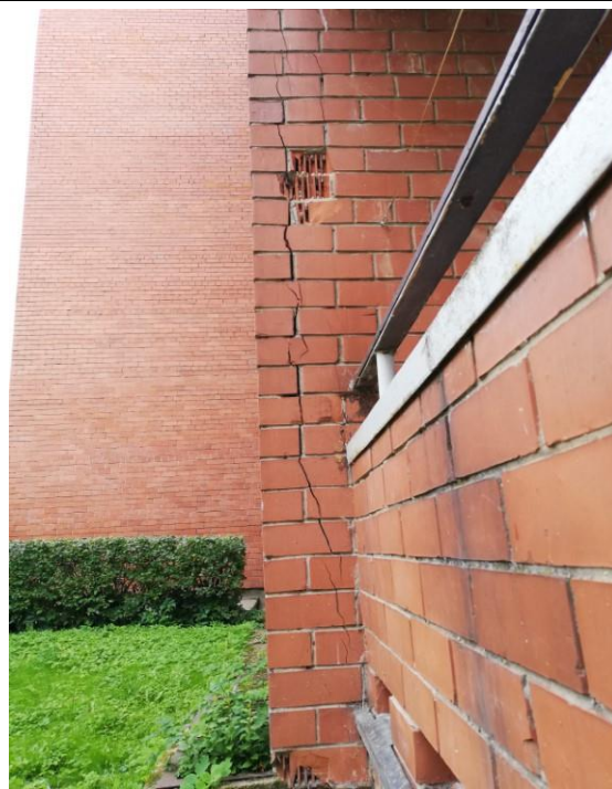
4.2.36.att. Vertikāla plaisa un ķieģeļu izdrupumi nesošajā šķērssienā nokrišņu un sala ietekmē. Vāja pilastra balsta pamatne. Valmieras iela 25, Cēsis.
