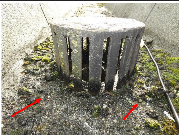
4.8.54.att. Jumta segums ar apaugumiem. Pastāv aizsērējuma risks. 1905.gada iela 7, Talsi
