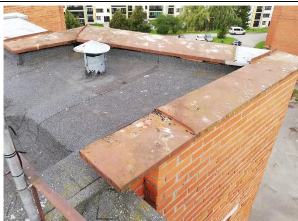
4.8.35.att. Savietotais jumta pārsegums virs kāpņu telpas. Nekvalitatīvi iesegts segums un skārda nosegelementi. Valmieras iela 21, Cēsis
