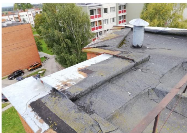
4.8.48.att. Savietotais jumta pārsegums virs kāpņu telpas. Nekvalitatīvi iesegts segums, skārda nosegelementu korozija. Valmieras iela 21, Cēsis
