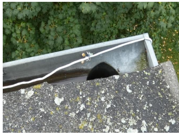
4.8.77.att. Neizolēti kabeļu savienojumi uz jumta. Mazcenu aleja 9, Jaunmārupe
