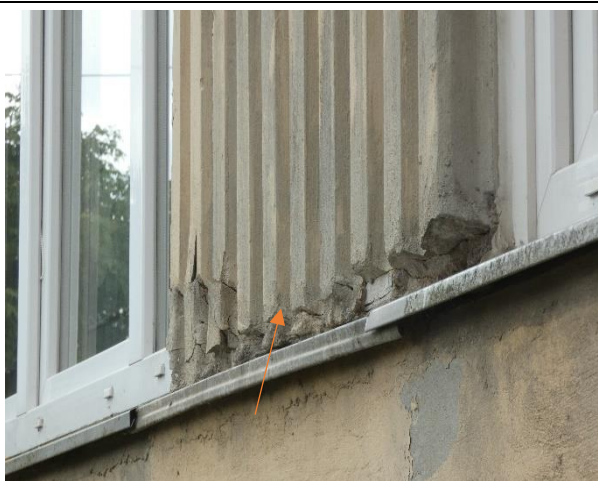
4.5.5. att. Nehermētiska savienojuma vieta starp paneli un dekoratīvo loga aizpildījumu. Ausekļa prospekts 1, Ogre.
