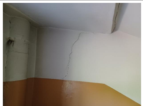
4.2.12.att. Slīpā plaša nesošajā šķērssiēnā kāpņu laukuma balsta vietā (3. kāpņu telpa). Kapseļu iela 4 k-2, Rīga
