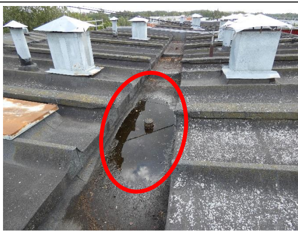
4.8.69.att. Nokrišņu uzkrāšanās dzelzsbetona tekņē. Jumta segums ar apaugumiem. Ausekļa pr.1, Ogre
