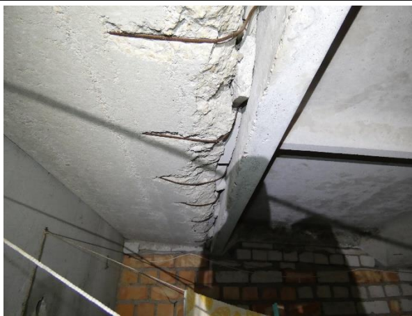
4.8.19.att. Atsegts un korodējis jumta plātnes stiegrojums. Iespējams bojājums montāžas laikā. 1905.gada iela 7, Talsi
