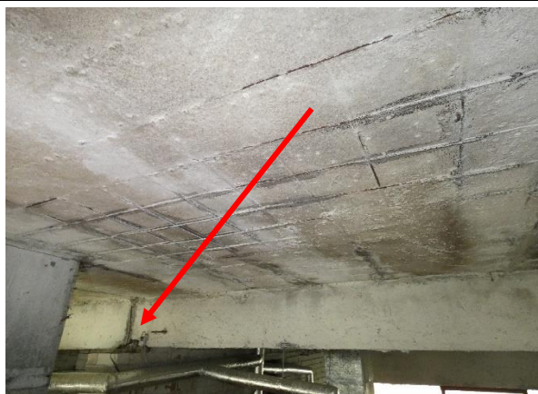
4.8.15.att. Mitruma infiltrācijas pazīmes, atsegts un korodējis jumta plātņu stiegrojums, nepietiekama aizsargkārtā. Ausekļa prospekts 1, Ogre.
