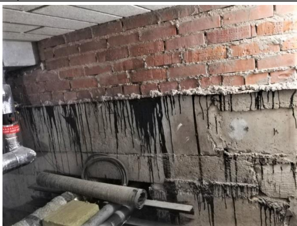
4.1.9. attēls. Konstatēta pamatu horizontālā hidroizolācija. Vaives 2A, Cēsis
