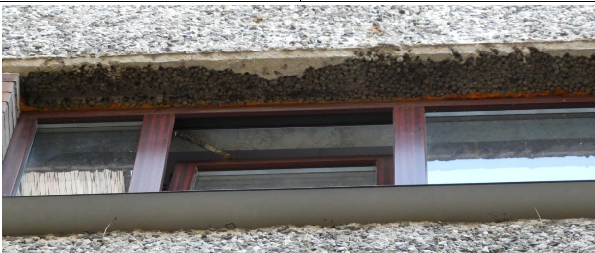
4.4.29.att. Kelamzītbetona paneļa apakšēja mala bez apdares. Nav aizsargāta no mitruma paneļa struktūra. Grēdu iela 3, Rīga
