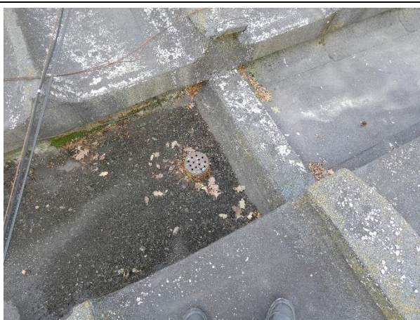
4.8.44.att. Gruži jumta teknē. Jumta segums ar apaugumiem. Ausekļa prospekts 1, Ogre
