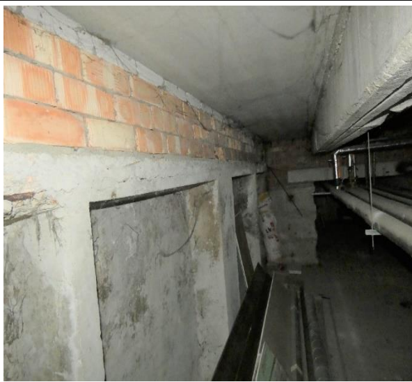
4.2.7. att. Pagraba cokola paneli ar atsegtu, korodējušu stiegrojumu un mitruma radītiem bojājumiem. Irlavas iela 26, Rīga.
