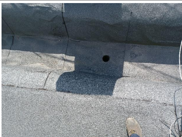
4.8.66.att. Trūkst teknes piltuves aizsargreše. Kapseļu iela 4 k-2, Rīga
