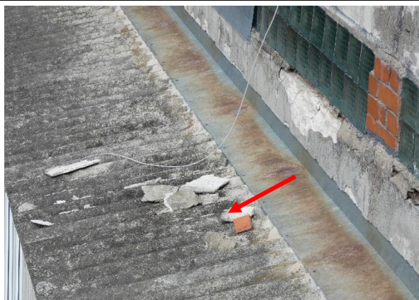
4.8.47.att. Jumta segums - azbestcements lokšņu. Apdares kārtas atdalīšanās – nepieciešams attīrīt jumtu no gružiem. Ausekļa prospekts 1, Ogre
