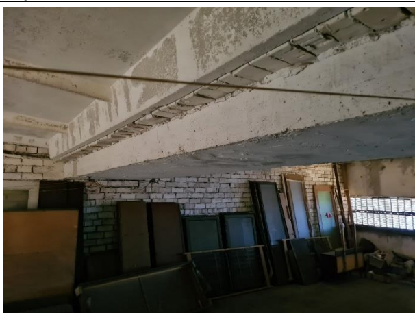
4.8.24.att. Iecirknis gar teknes elementu aizmūrēts ar ķieģeļiem. Montāžas neprecizitātes. Grēdu iela 3, Rīga.
