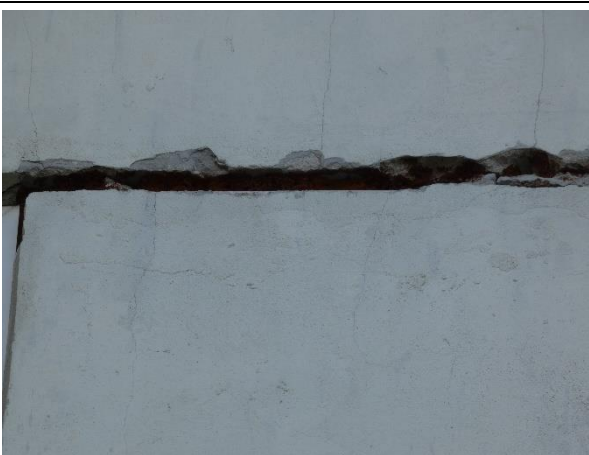
4.4.22.att. Izdrupums starppaneļu šuves aizpildījums. Loka iela 3, Cēsis.
