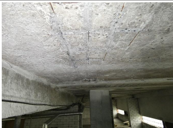
4.8.13.att. Atsegts un korodējis jumta panelu stiegrojums. Ražošanas defekts. Ausekļa prospekts 1, Ogre.
