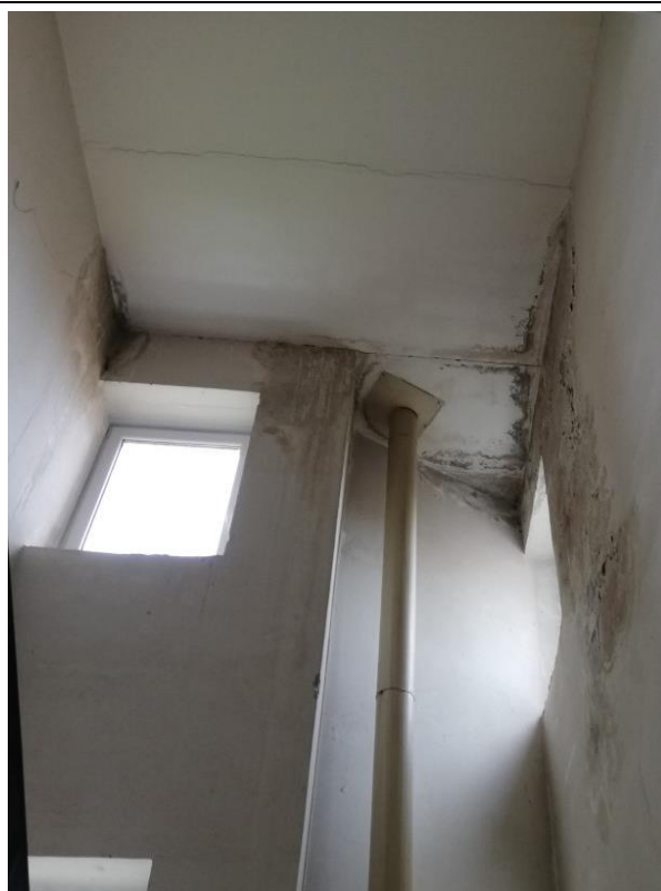
4.8.37. att. Savietotā jumta pārsegums virs kāpņu telpas. Mitruma infiltrācijas pazīmes. 5-stāvu ēka Valmieras ielā 21, Cēsīs.
