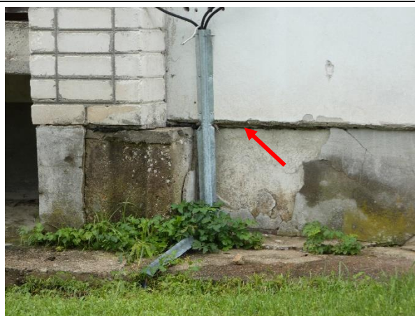
4.1.14.att. Konstatēta horizontālā hidroizolācija. Apmetums atdalījies no pamatnes. Mazirbe, Skolotāju māja 2.
