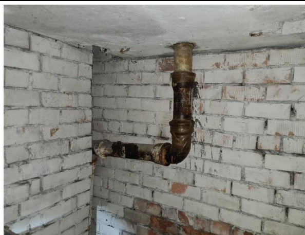
4.8.33.att. Jumta lietus ūdens kanalizācijas notekcaurule (ķeta). Grēdu iela 3, Rīga.
