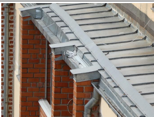
4.8.68.att. Valcētā skārda segums un notekrenes jumta konstrukcijai virs 5.stāva. Irlavas iela 26, Rīga
