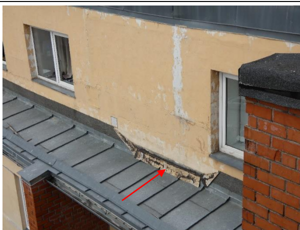
4.8.11.att. Bojāts ruberoīda hidroizolācijas pieslēgums ārsienas konstrukcijai virs 5.stāva
