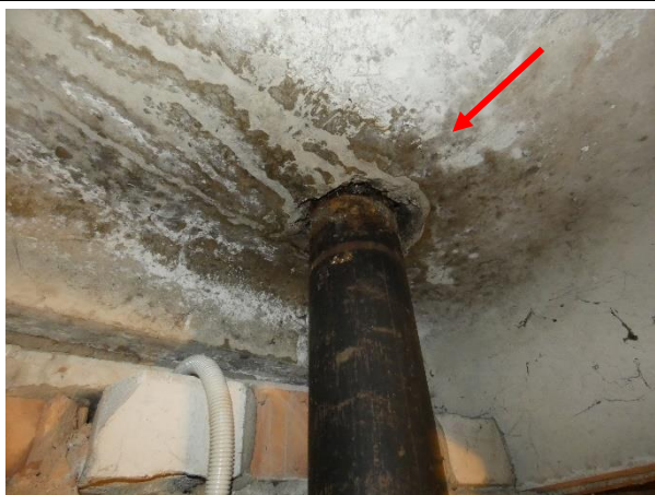
4.8.20.att. Konstatēta mitruma infiltrācija pie izvadiem jumtā. 1905.gada iela 7, Talsi
