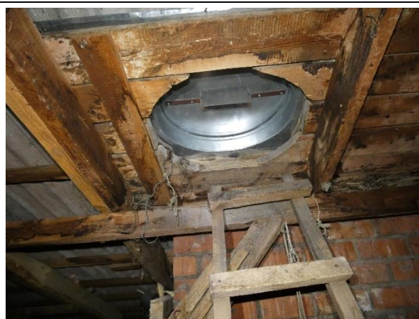
4.8.39.att. Lūka jumtā – koka konstrukcijās ar mitruma pazīmēm. Mazirbe, Skolotāju māja 2.
