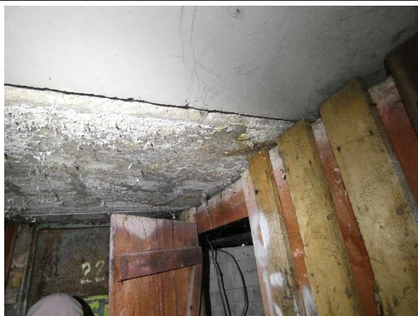
4.6.4.att. Mitruma pazīmes pagraba pārsegumā. Iespējams, inženiertīklu bojājumu dēļ. Kapseļu iela 4 k-2, Rīga.
