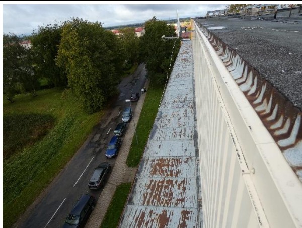
4.8.52.att. Skārda elementi un jumta segums ar koroziju. 1905.gada iela 7, Talsi
