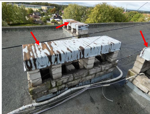
4.8.53.att. Skārda elementu korozija, nehermētiskas savienojumu vietas. 1905.gada iela 7, Talsi
