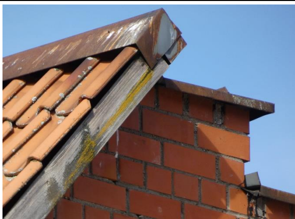
4.8.51.att. Korodējuši skārda nosegelementi. Vēja dēļi ar trapes pazīmēm, bez aizsargkrāsojuma. Loka iela 3, Cēsis
