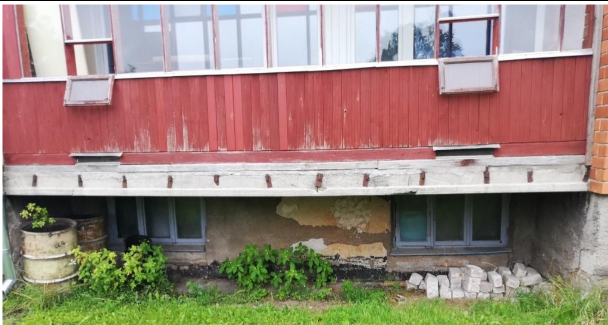
4.9.12.att. Lodžijas pārseguma plātne ieliekusies – plaisas, izdrupumi un detaļu korozija. Saulkalni, Liepa.
