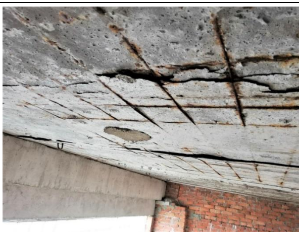
4.8.23.att. Jumta klāja ribotām dzelzsbetona plātnēm atslāņojies betons un korodējis stiegrojums. Valmieras iela 21, Cēsis.
