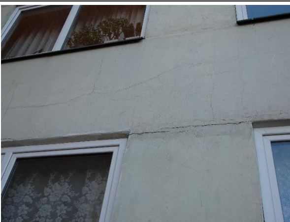
4.4.24.att. Ārsienu paneļi ar plaisu tīklu. Loka iela 3, Cēsis.
