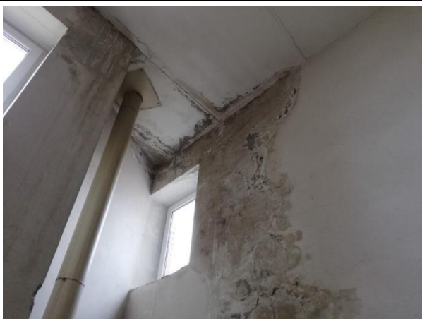
4.2.33.att. Plaisas un mitruma bojājumi 4.sekcijas kāpņu telpas mūra sienā. Ilgstoši neremontēts jumta segums. Valmieras iela 21, Cēsis.
