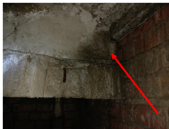
4.8.5.att. Mitruma filtrācijas pazīmes teknes balsta vietā – nav nodrošināts seguma hermētiskums (2. kāpņu telpa, bēniņi). Kapseļu iela 4 k-2, Rīga.
