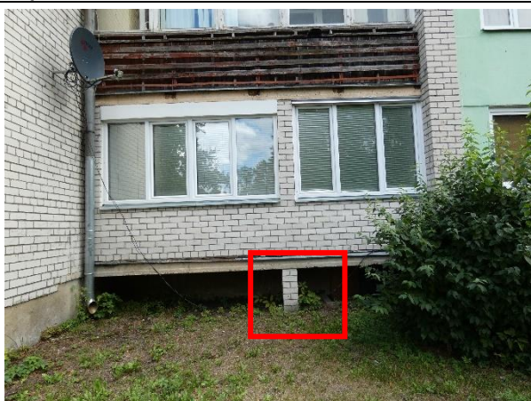
3.8.att. Konstatēta neatbilstība Projektam un patvaļīgi būvdarbi - aizmūrēta un aizstiklota lodžija, zem pārseguma plātnes ierīkots balsts. Mazcenu aleja 9, Jaunmārupe
