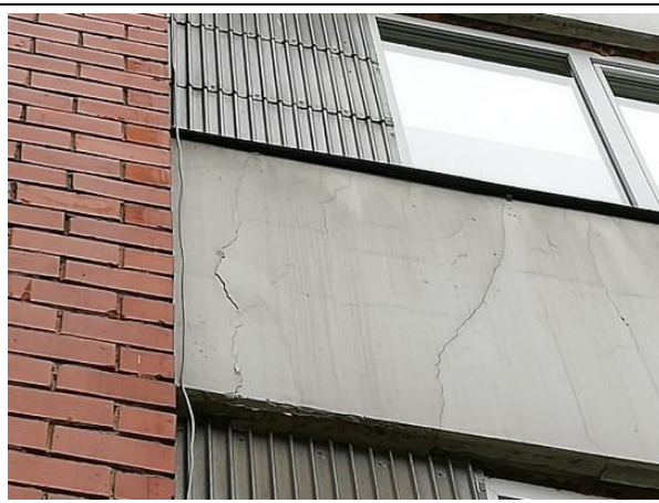
4.4.18.att. Plaisu tīkls - caurredzama gāzbetona paneļu stiebrojuma karkasa aizsargkārtas atslāņošanās paneļu virsmā. Valmieras iela 25, Cēsis.
