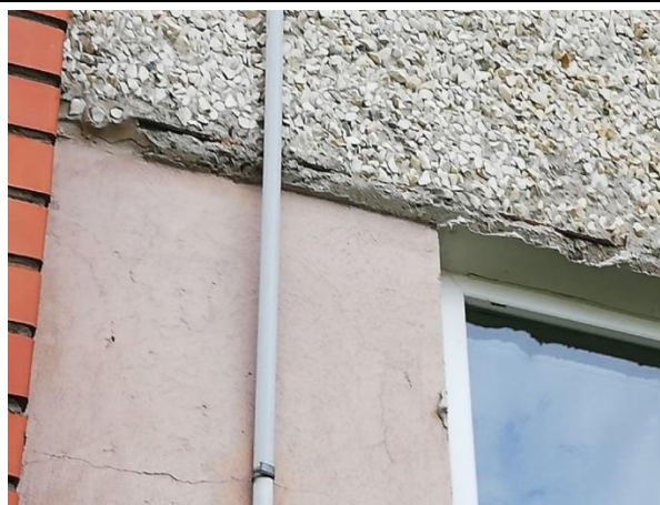
4.4.28.att. Lokāli izdrupumi un atsegts stiegrojums ārsienu paneļos, plaisu tīkls apmetumā gāzbetona starplogu aizmūrējumā. Valmieras iela 21, Cēsis.
