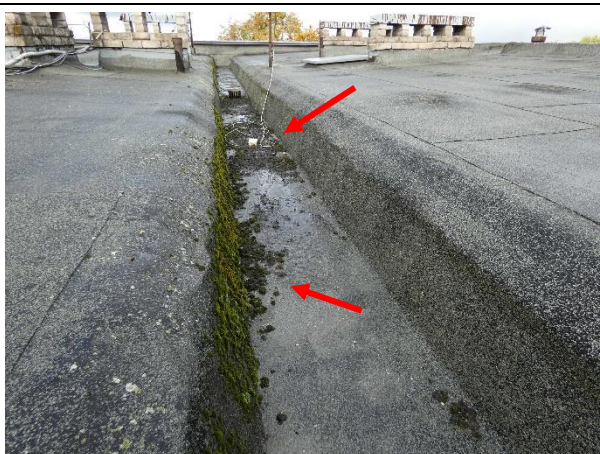
4.8.56.att. Gruži jumta teknē. Jumta segums ar apaugumiem. 1905.gada iela 7, Talsi
