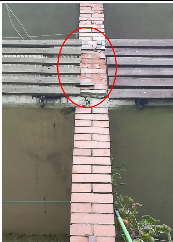
4.2.16.att. Kieģeļu mūra izdrupumi nesošajā šķērssienā. Pūpoli, Liepa.
