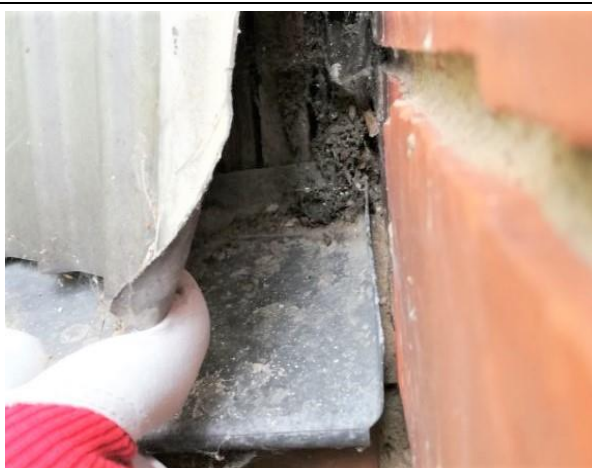
4.4.12.att. Aizpildījums starp logu ailām ir veidots no koka karkasa un minerālvates, atsegtas vietas. Nav nodrošināts ārējās norobežojošās konstrukcijas hermētiskums.
