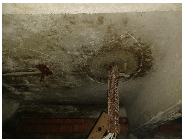
4.8.7.att. Mitruma filtrācijas pazīmes jumta plātnē tīklu šķērsojuma vietā (2. kāpņu telpa, bēniņi). Kapseļu iela 4 k-2, Rīga.
