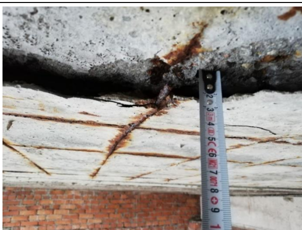
4.8.22.att. Jumta klāja ribotām dzelzsbetona plātnēm atslāņojies betons un korodējis stiegrojums. Valmieras iela 21, Cēsis.
