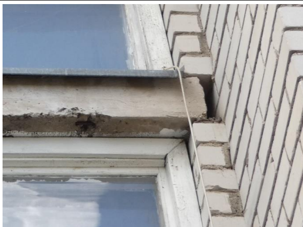
4.2.13.att. Nepietiekama pārsedzes balsta vieta. Būvdarbu defekts. Deformācijas nav konstatētas. Mazcenu aleja 13, Mārupe
