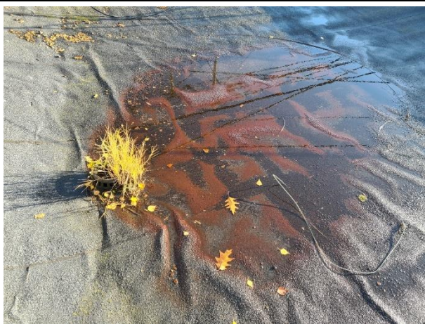
4.8.60.att. Jumta segums ar lokāliem bojājumiem
