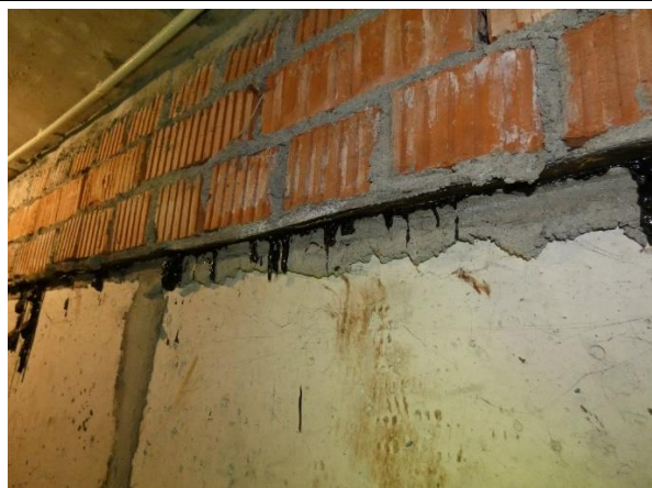
4.1.16. attēls. Konstatēta bitumena horizontālā hidroizolācija virs pamatu blokiem – apmierinošā stāvoklī. Irlavas iela 26, Rīga.
