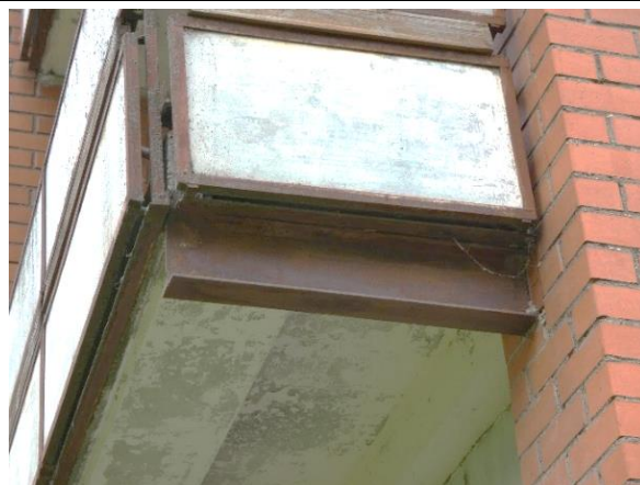
4.9.14.att. Konsolsija un lodžijas norobežojošo elementu metāla konstrukciju elementi korodējuši, bez aizsargpārklājuma. Nepieciešams veikt to pretkorozijas apstrādi. Konsolsijas balsta vieta labā stāvoklī. Loka iela 3, Cēsis.
