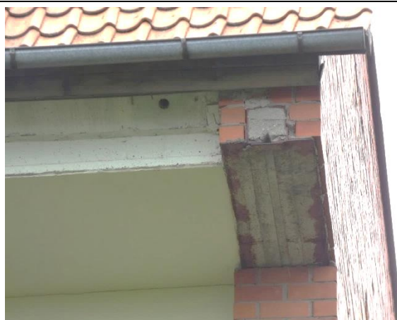
4.2.32.att. Nesošās mūra gala sienas fragments balstīts uz metāla konstrukcijas un monolītā dzelzsbetona konsoles, ar korozijas pazīmēm, Loka iela 3, Cēsis.
