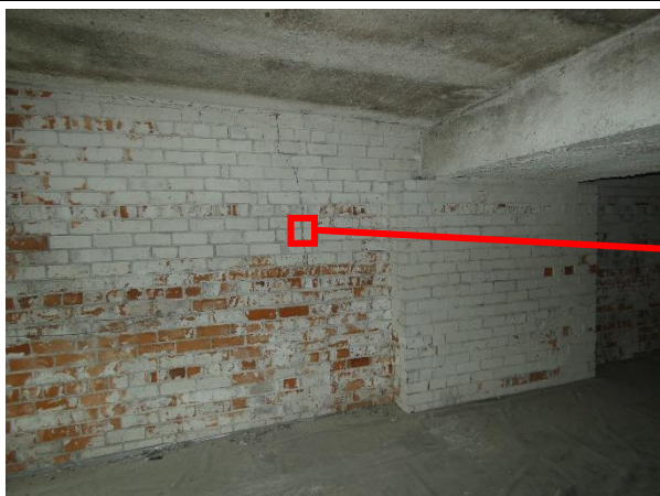
4.2.29.att. Plaisa nesošajā šķērssienā bēniņos, Ausekļa prospekts 1, Ogre.
