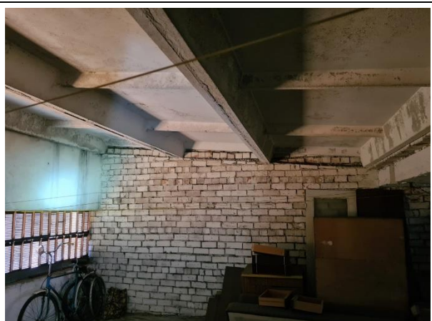
4.8.27.att. Jumta klāju veido ribotās dzelzsbetona plātnes, balsta vietas apmierinošā stāvoklī. Grēdu ielā 3, Rīgā
