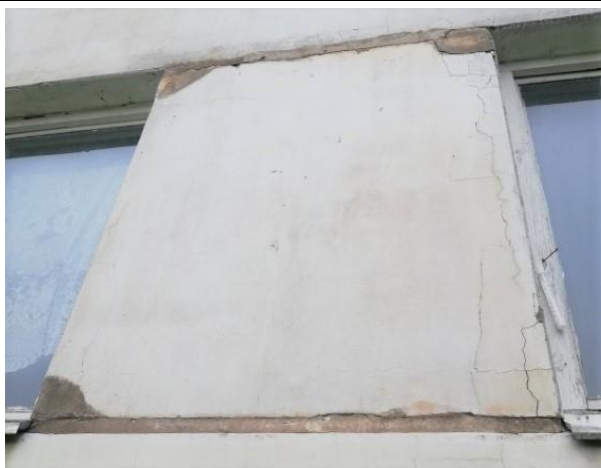
4.4.19.att. Bojāts starppaneļu šuves aizpildījums, gāzbetona paneļa bojājumi. Saulkalni, Liepa.
