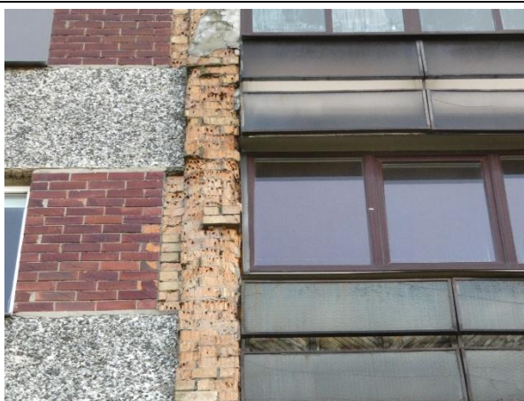
4.2.28.att. Mūra erozija nesošās mūra šķērssienas vidusdaļā (2.sekcija). Grēdu iela 3, Rīga.
