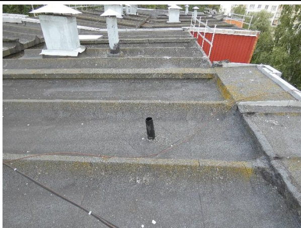
4.8.42.att. Jumta segums ar apaugumiem. Zuduši nosedzošie vāciņi izvadiem jumtā. Irlavas iela 26, Rīga
