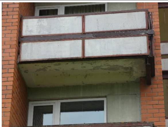
4.9.13.att. Konsolsija un lodžijas norobežojošo elementu metāla konstrukciju elementi korodējuši, bez aizsargpārklājuma. Nepieciešams veikt to pretkorozijas apstrādi. Konsolsijas balsta vieta labā stāvoklī. Loka iela 3, Cēsis.
