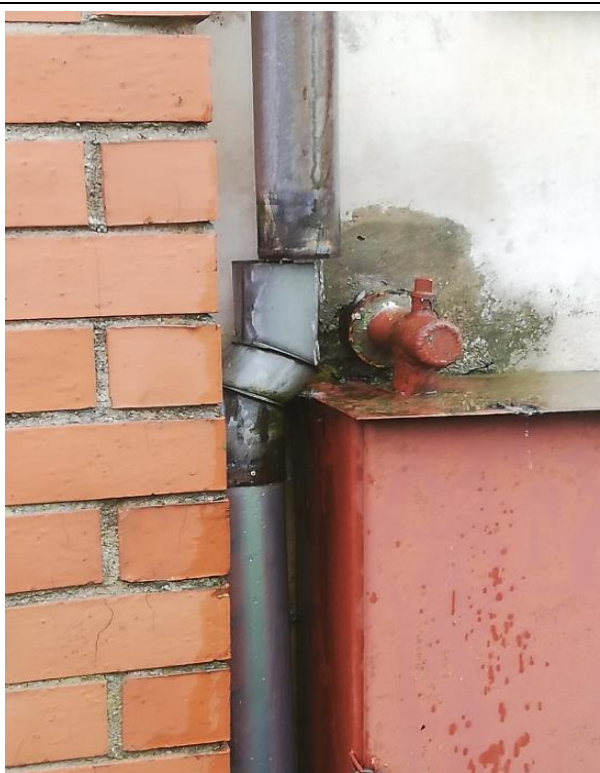
4.8.72.att. Bojāts notekcaurules posms. Saulkalni, Liepa
