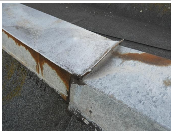
4.8.45.att. Korodējuši parapeta skārda elementi un nehermētiskas savienojumu vietas. Ausekļa prospekts 1, Ogre
