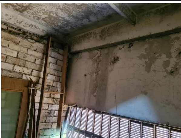
4.4.27. att. Mitruma pazīmes, mikroplaisas uz ārsienu paneļa iekšējās virsmas, 4.kāpņu telpas bēniņos. Grēdu iela 3, Rīga.
