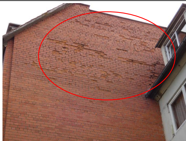
4.2.22.att. Ķieģeļu izdrupumi, mitruma infiltrācijas rezultātā bojājumi iekštelpās, sk. att. 4.2.5. Loka iela 3, Cēsis.
