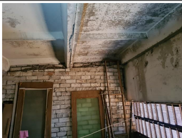
4.8.25.att. Jumta klāja ribotās dzelzsbetona plātnes ar nebūtiskām mitruma bojājumu pazīmēm. Nehermētisks jumta segums un pieslēgumu vietas. Grēdu iela 3, Rīga.
