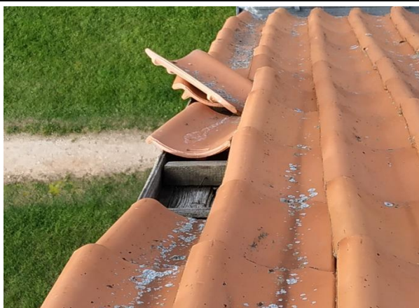
4.8.50.att. Bojāts māla dakstiņu segums. Loka iela 3, Cēsis
