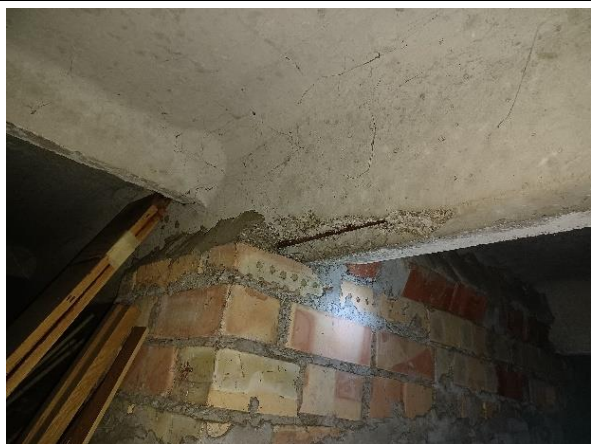
4.8.6.att. Stiegrojuma aizsargslāņa izdrupumi, atsegumi un korozija jumta plātnes balsta vietā (2. kāpņu telpa). Kapseļu iela 4 k-2, Rīga.
