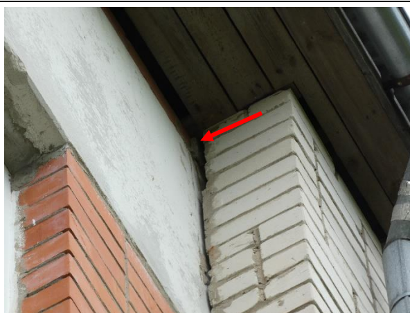
4.2.24.att. Pilastra nobīde no vertikālītātes, nav pārsiets ar ēkas konstrukcijām. Mazirbe, Skolotāju māja 2.
