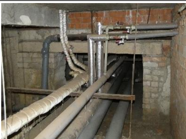
4.2.31. att. Tehniskajā gaitenī pārsedze balstīta uz ķieģeļu mūri, kas neatbilst Projekta norādēm. Ausekļa prospekts 1, Ogre.
