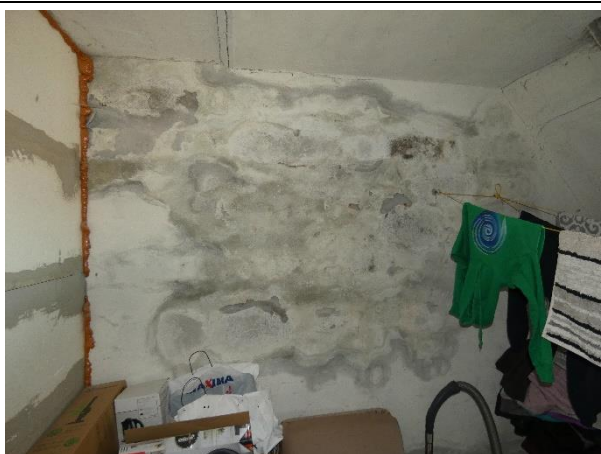
4.2.21.att. Mitruma radīti bojājumi nesošajā šķērssienā. 5.stāva telpās, skatīt ārsienas fragmentu attēlā 4.2.6. Loka iela 3, Cēsis.
