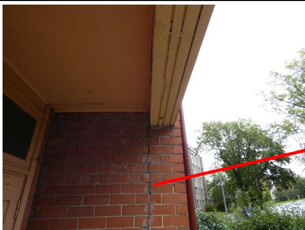
4.2.25.att. Plaisa nesošajā sienā pirmā stāva līmenī. Valmieras iela 25, Cēsis.
