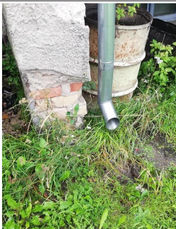
4.8.73.att. Nokrišņu ūdens tiek novadīts pārāk tuvu ēkas konstrukcijām. Saulkalni, Liepa
