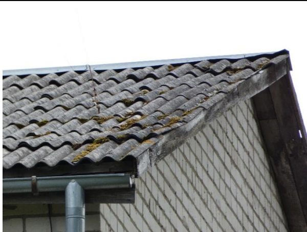
4.8.62.att. Nehermētiski skārda nosegelementi korē, satrupējis vēja dēlis, jumta segums ar apsūņojumu. Mazirbe, Skolotāju māja 2.
