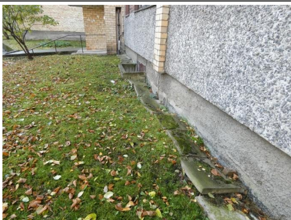
4.1.17.att. Ēkas aizsargapmale sabrukusi pa visu ēkas perimetru. Grēdu 3, Rīga.
