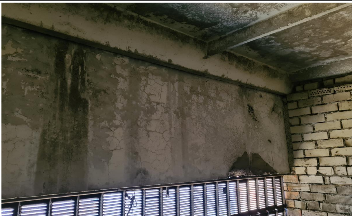
4.4.31. attēls. Nokrišņu ietekmē ārējo paneļa bojājumi uz iekšējās virsmas. Nehermētisks jumta segums. Grēdu iela 3, Rīga
