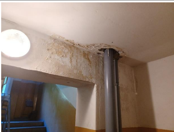
4.6.3.att. Mitruma filtrācijas pazīmes starpstāvu pārsegumā lietussūdens kanalizācijas stāvvada bojājuma rezultātā (3. kāpņu telpa). Kapseļu iela 4 k-2, Rīga.
