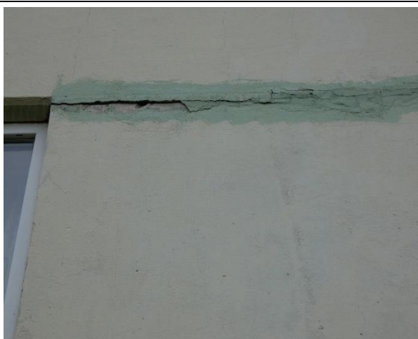
4.5.6.att. Starppaneļu šuves neapmierinošā tehniskā stāvoklī. Loka iela 3, Cēsis
