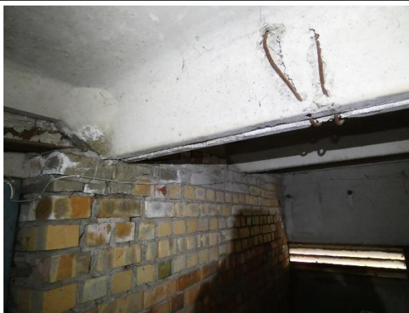
4.8.21.att. Atsegts un korodējis jumta paneļu stiegrojums. Ražošanas defekts. 1905.gada iela 7, Talsi
