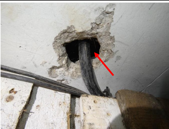
4.6.7. Att. Nenoblīvēta inženiertīklu šķērsojumu vieta. Ausekļa prospekts 1, Ogre.
