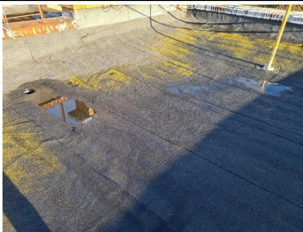
4.8.61.att. Jumta segums ar apaugumu
