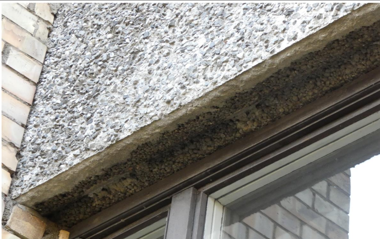
4.4.30. attēls. Keramzītbetona paneļa apakšēja mala bez apdares. Nav aizsargāta no mitruma paneļa struktūra. Grēdu iela 3, Rīga
