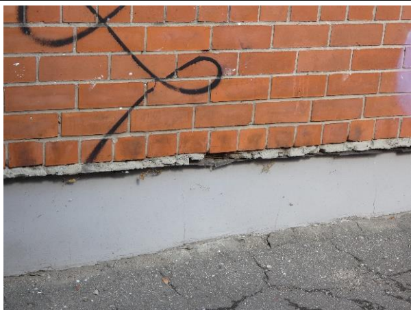
4.1.15.att. Bitumena horizontālā hidroizolācija virs pamatu blokiem – apmierinošā stāvoklī. Kapseļu iela 4 k-2, Rīga.
