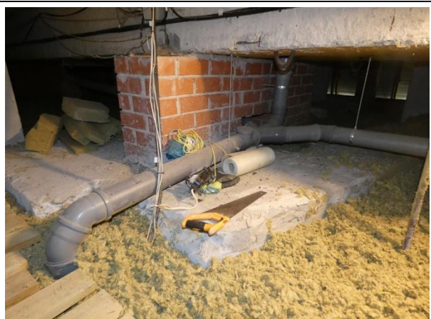
4.8.29.att. Tekņu elementu balsta vieta uz mūra sienu apmierinošā stāvoklī. Vaives iela 2A, Cēsis
