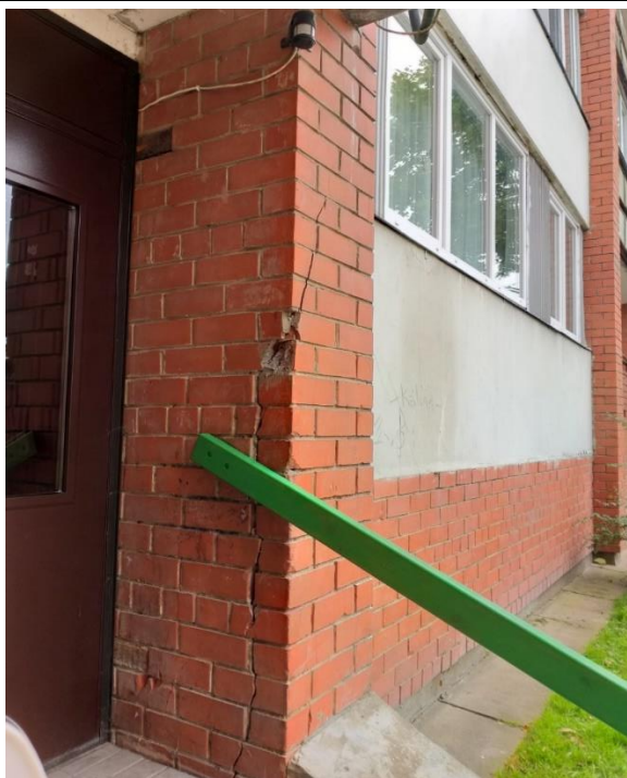
4.2.35.att. Vertikāla plaisa un mūra izdrupumi ēkas kāpņu telpas nesošajā šķērssienā. Cēloņi – mūrī nav ievietots stiegrojums. Valmieras iela 25, Cēsis.
