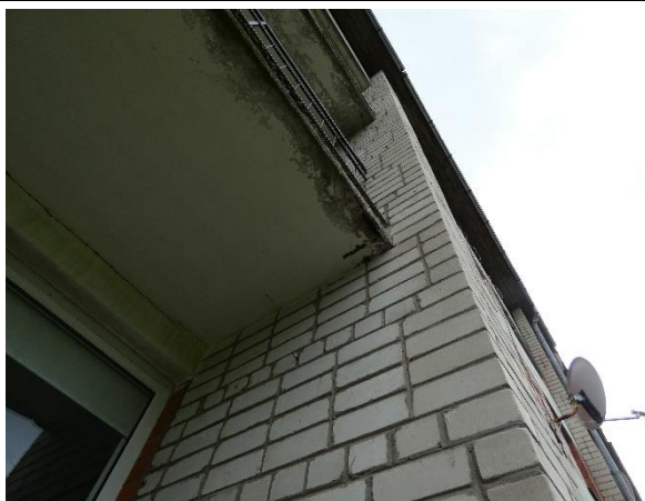
4.9.1.att. Bojāta lodžijas pārseguma plātne – plaisas, izdrupumi, atsegts korodēts stiebrojums. Mazirbe, Skolotāju māja 2
